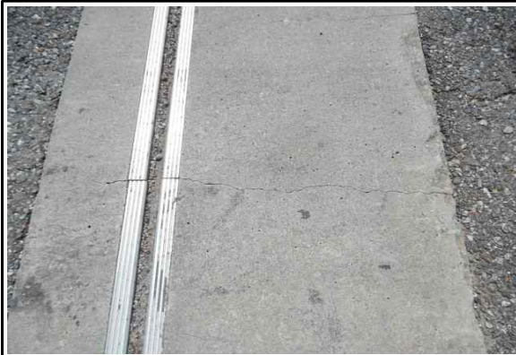
신축이음 후타재 균열(cw:0.3mm미만) (25년 상반기 정기안전점검)
