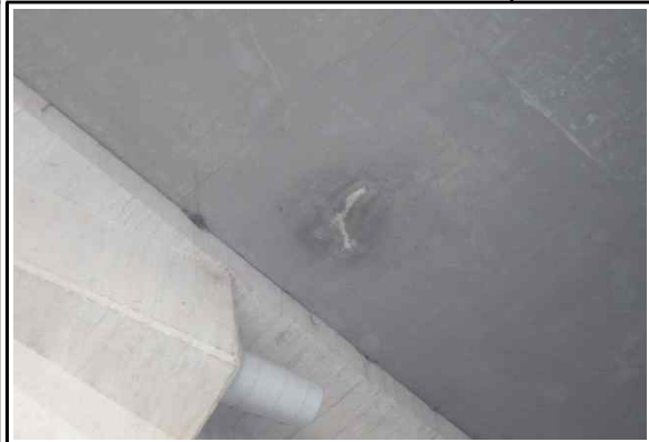
바닥판하면 백태 (25년 하반기 정기안전점검)
