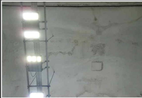
Sta. 017(Span 4) 천단부-표면열화 (25년 상반기 정기안전점검)
