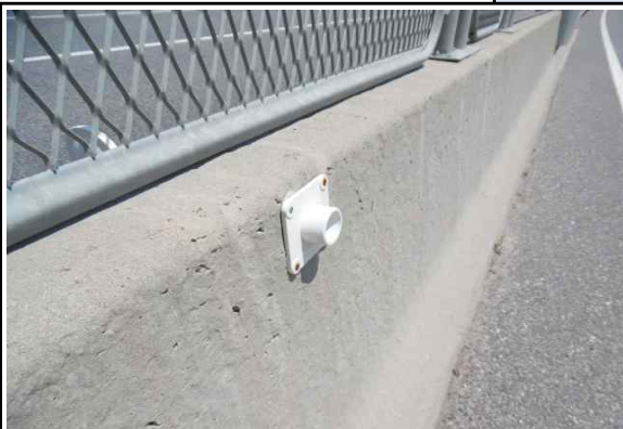
중앙분리대 텔리네이트 파손 (25년 상반기 정기안전점검)
