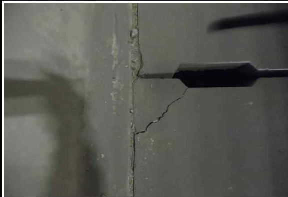
Sta. 177(Span 22) 공동구-덮개파손 (25년 상반기 정기안전점검)
