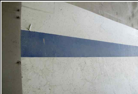
종점 갭문-망상균열(cw:0.3mm미만) (25년 상반기 정기안전점검)
