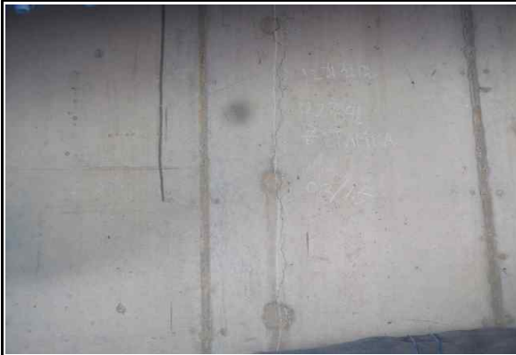
A2 흉벽-균열(cw:0.3mm미만) (25년 상반기 정기안전점검)
