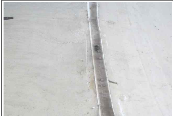
시점(Span 2) 갭문-박리 (25년 하반기 정기안전점검)
