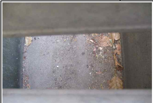
배수시설-배수로 토사퇴적 (25년 하반기 정기안전점검)
