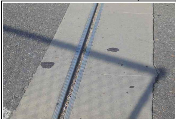
신축이음 후타재 균열(cw:0.3mm미만) (25년 하반기 정기안전점검)
