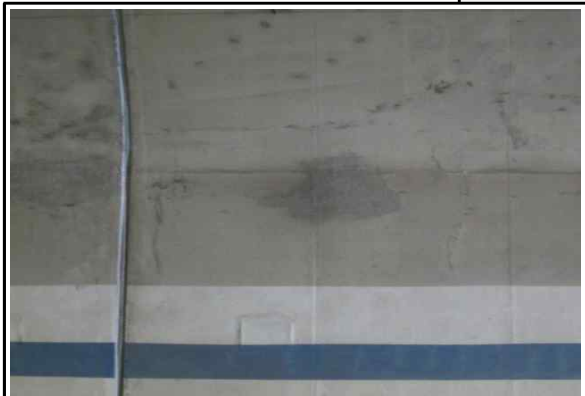
Sta. 200(Span 25) 중앙벽체-누수흔적 (25년 하반기 정기안전점검)
