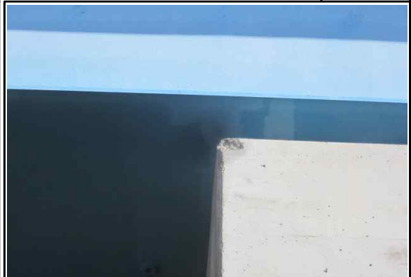
P1 코핑-파손 (25년 하반기 정기안전점검)
