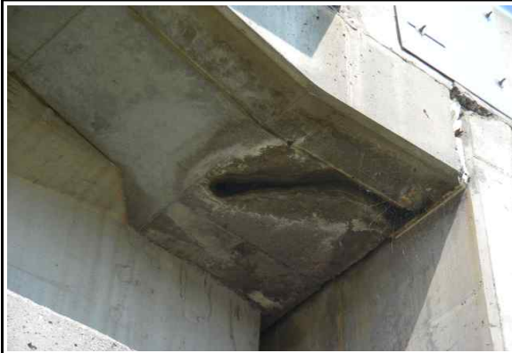
바닥판하면 누수흔적, 백태 (25년 상반기 정기안전점검)
