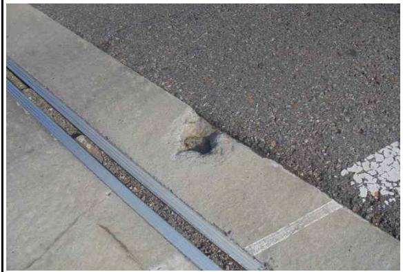
신축이음 후타재 파손 (25년 하반기 정기안전점검)
