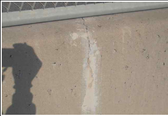
중앙분리대 균열(cw:0.3mm이상) (25년 하반기 정기안전점검)
