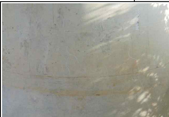
교각 망상균열(cw:0.3mm미만) (25년 하반기 정기안전점검)
