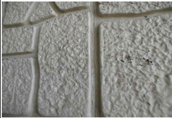
교대 균열(cw:0.3mm미만) (25년 상반기 정기안전점검)
