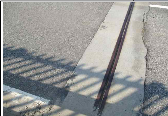
P9(강화) 신축이음-후타재 망상균열 (25년 상반기 정기안전점검)
