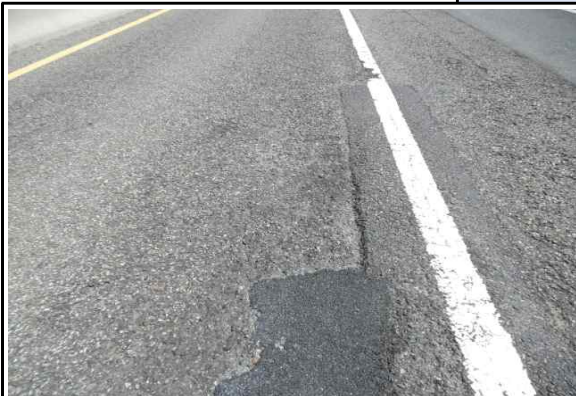
교면포장 포장 열화, 패임 (25년 상반기 정기안전점검)
