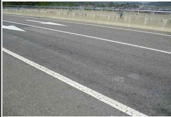
교면포장 포장 망상균열 (25년 상반기 정기안전점검)
