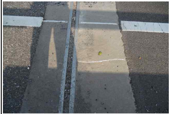
신축이음 후타재 균열(cw:0.3mm미만) (25년 하반기 정기안전점검)
