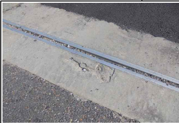
신축이음 후타재 파손 (25년 하반기 정기안전점검)
