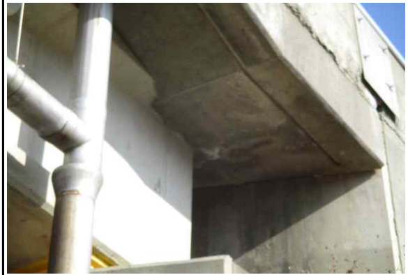
바닥판하면 백태, 유공관 길이부족 (25년 하반기 정기안전점검)
