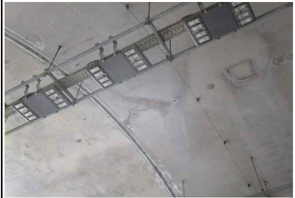
Sta. 228(Span 27) 천단부-표면열화 (25년 하반기 정기안전점검)
