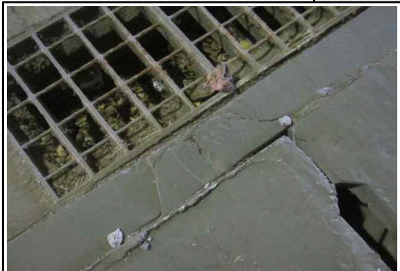
Sta. 175(Span 22) 공동구-파손 (25년 하반기 정기안전점검)
