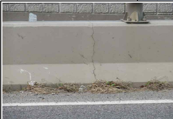
U-Type 옹벽-균열(cw:0.3mm이상) (25년 상반기 정기안전점검)
