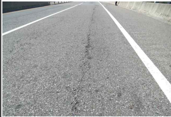
교면포장 포장 균열 (25년 상반기 정기안전점검)
