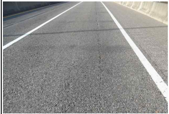
교면포장 포장 균열 (25년 하반기 정기안전점검)
