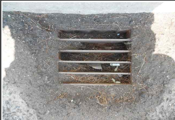
배수시설 배수구 막힘 (25년 상반기 정기안전점검)
