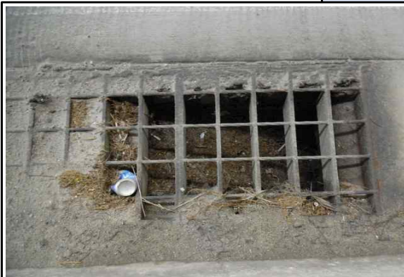
Span 22 배수구-토사퇴적 (25년 상반기 정기안전점검)
