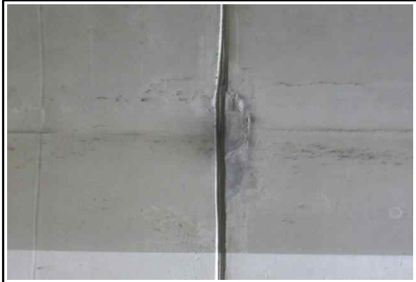
Sta. 209(Span 26) 중앙벽체-박리 (25년 하반기 정기안전점검)
