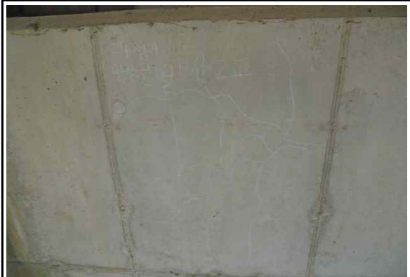
교대 망상균열(cw:0.3mm미만) (25년 하반기 정기안전점검)
