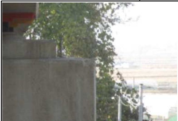
P3 코핑-파손 (25년 하반기 정기안전점검)
