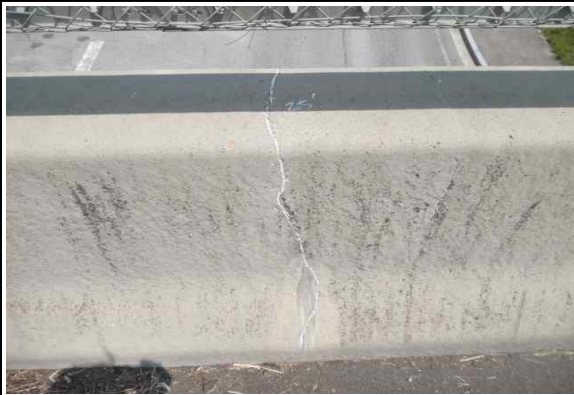
연석 균열(cw:0.3mm미만) (25년 상반기 정기안전점검)
