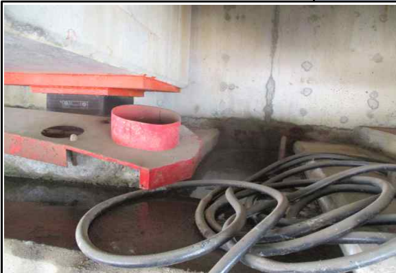
A1 교량받침면-채수흔적 (25년 상반기 정기안전점검)
