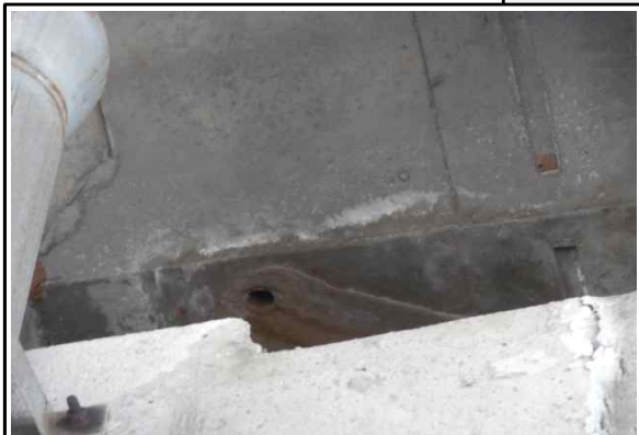
바닥판하면 백태, 유공관 길이부족 (25년 하반기 정기안전점검)
