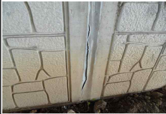
교대 실링재 파손 (25년 상반기 정기안전점검)
