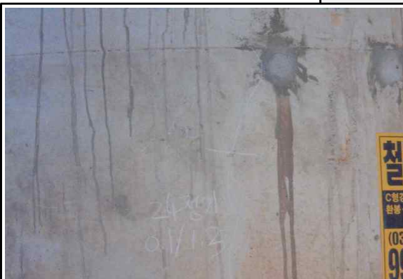
교각 균열(cw:0.3mm미만) (25년 하반기 정기안전점검)
