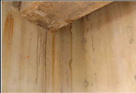
S1-G5 거더-파손 (25년 상반기 정기안전점검)
