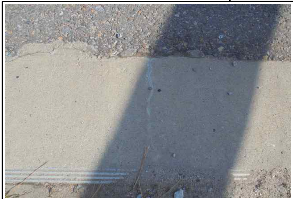
신축이음 후타재 균열(cw:0.3mm미만) (25년 하반기 정기안전점검)
