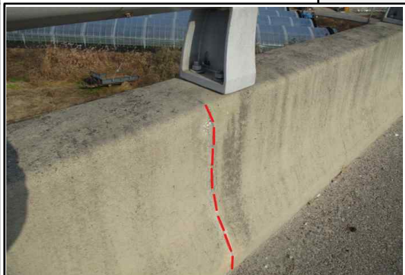
S2 방호울타리-균열(cw:0.3mm미만) (25년 하반기 정기안전점검)
