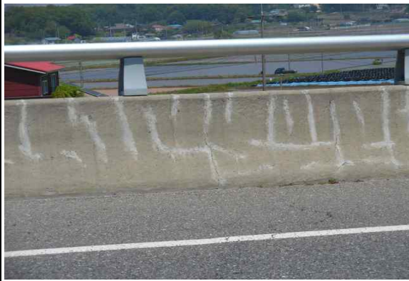
방호벽 보수부 균열(cw:0.3mm 이상) (25년 상반기 정기안전점검)
