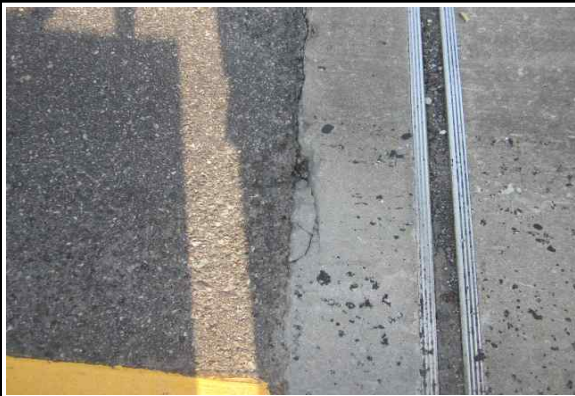
신축이음 후타재 파손 (25년 하반기 정기안전점검)
