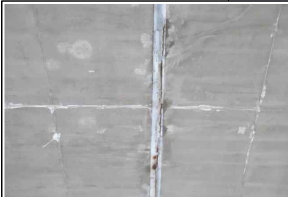
바닥판하면 실런트 열화 (25년 상반기 정기안전점검)
