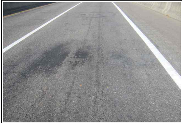
교면포장 포장 균열 (25년 하반기 정기안전점검)
