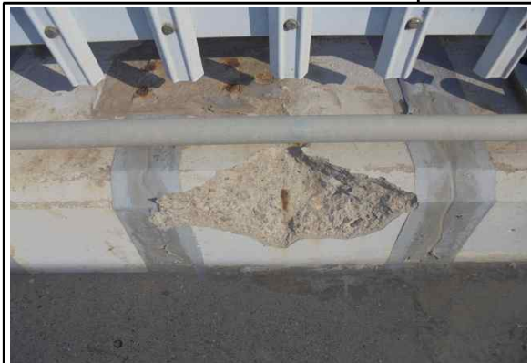
S10(강화) 연석-파손 및 철근노출 (25년 하반기 정기안전점검)
