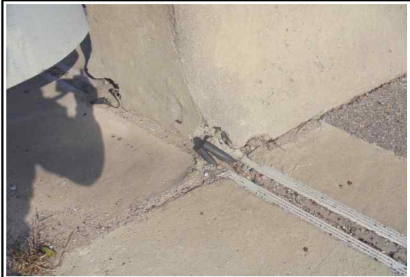
중앙분리대 파손 (25년 하반기 정기안전점검)
