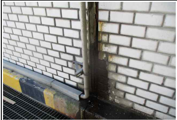
U-Type구간 실린트 파손, 누수 (25년 하반기 정기안전점검)
