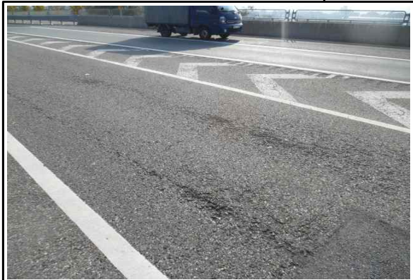
교면포장 포장 마모 (25년 하반기 정기안전점검)
