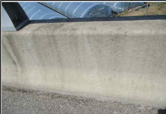
S4 방호울타리-균열(cw:0.3mm미만) (25년 상반기 정기안전점검)
