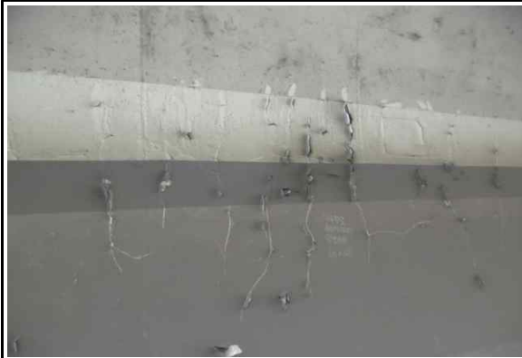
Span22 벽체-망상균열(cw:0.3mm미만) (25년 상반기 정기안전점검)
