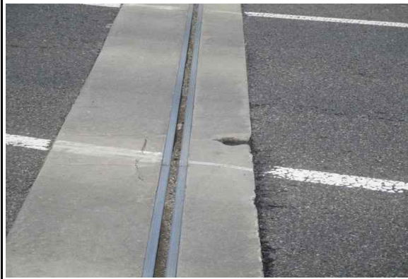
신축이음 후타재 파손 (25년 상반기 정기안전점검)
