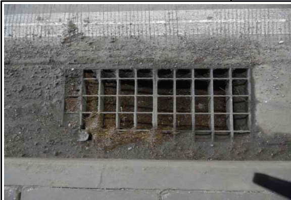
Sta. 022(Span 5) 배수구-토사퇴적 (25년 상반기 정기안전점검)
