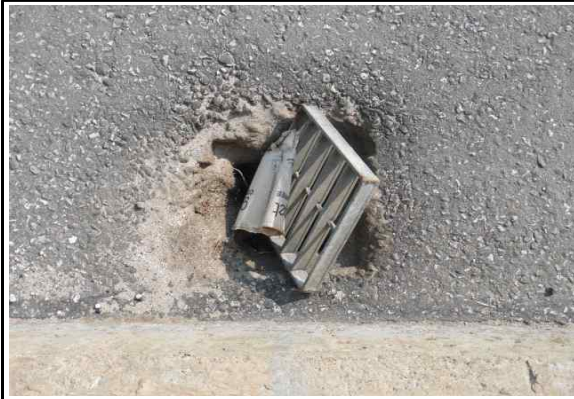
S10(강화) 배수시설-그레이팅 탈락 (25년 상반기 정기안전점검)
