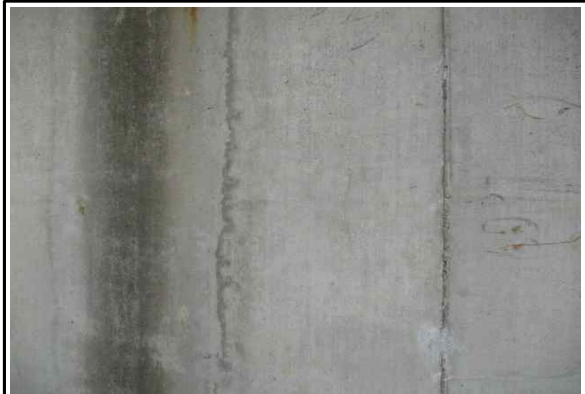
교대 균열(cw:0.3mm미만) (25년 하반기 정기안전점검)
