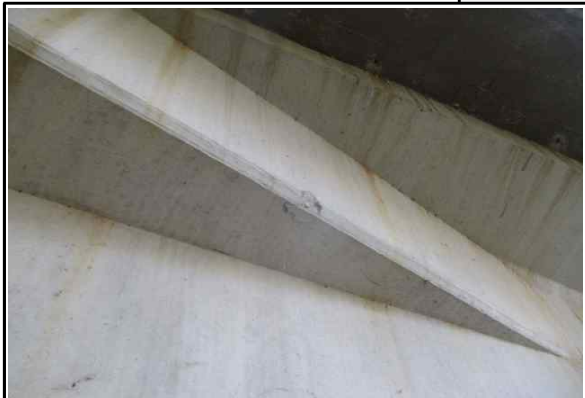
S4-G5 거더-파손 (25년 하반기 정기안전점검)
