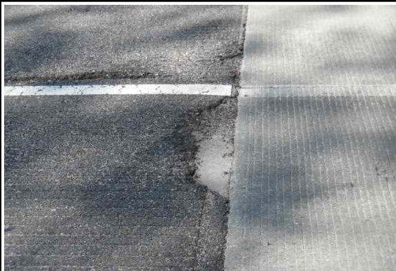
시점부 접속포장-파손 (25년 상반기 정기안전점검)
