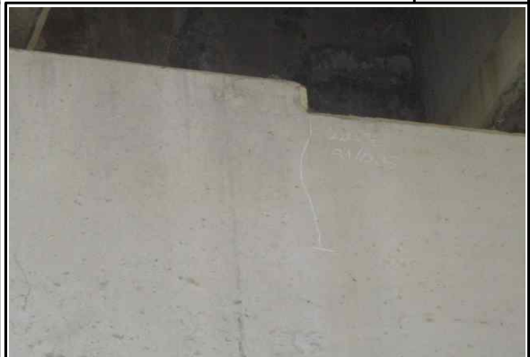
P1(G2~G3) 코핑(전면)-균열(cw:0.3mm미만) (25년 하반기 정기안전점검)
