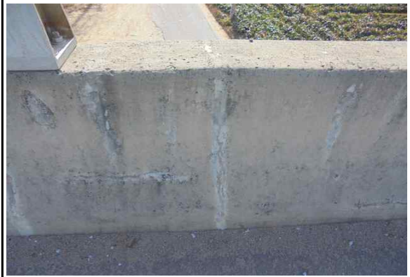
방호벽 균열부 백태(cw:0.3mm 이상) (25년 하반기 정기안전점검)
