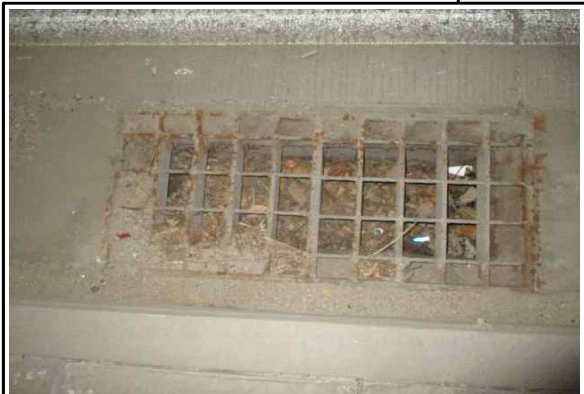
Span 22 배수구-토사퇴적 (25년 하반기 정기안전점검)
