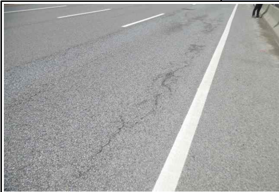
교면포장 포장균열 (25년 상반기 정기안전점검)
