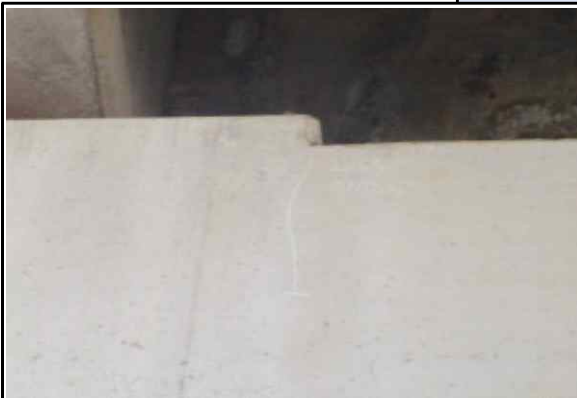
P1(G2~G3) 코핑(전면)-균열(cw:0.3mm미만) (25년 상반기 정기안전점검)
