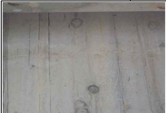
A2(G2~G3) 홍벽-균열(cw:0.3mm미만) (25년 하반기 정기안전점검)
