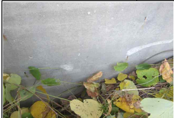
A1 벽체-파손 (25년 하반기 정기안전점검)
