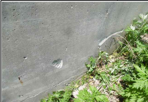
A1 벽체-파손 (25년 상반기 정기안전점검)
