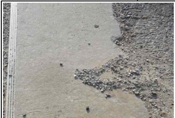
신축이음 후타재 파손 (25년 하반기 정기안전점검)
