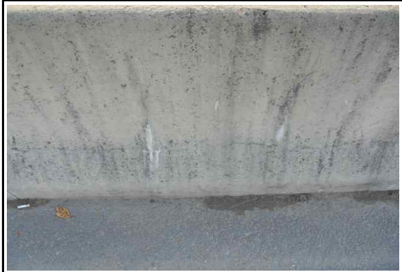
방호벽 균열부 백태(cw:0.3mm미만) (25년 하반기 정기안전점검)
