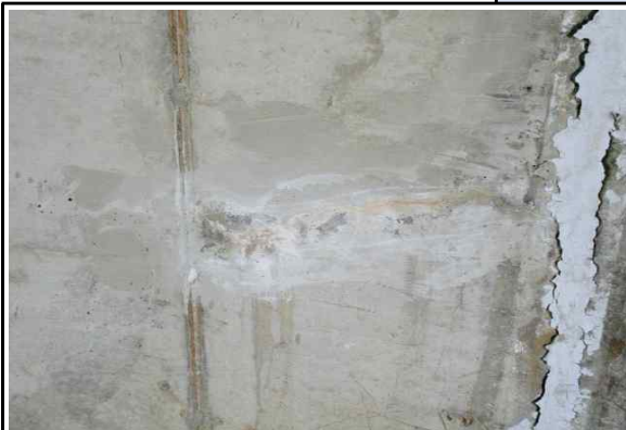
교대 균열부 백태(cw:0.3mm미만) (25년 상반기 정기안전점검)
