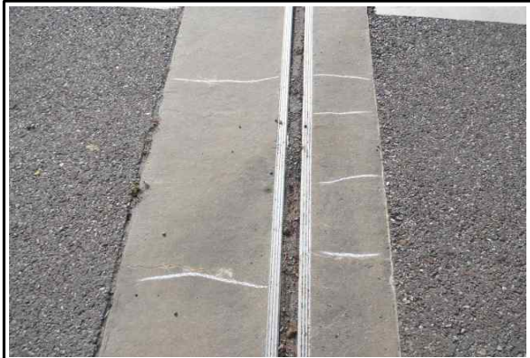
신축이음 후타재 균열(cw:0.3mm미만) (25년 하반기 정기안전점검)
