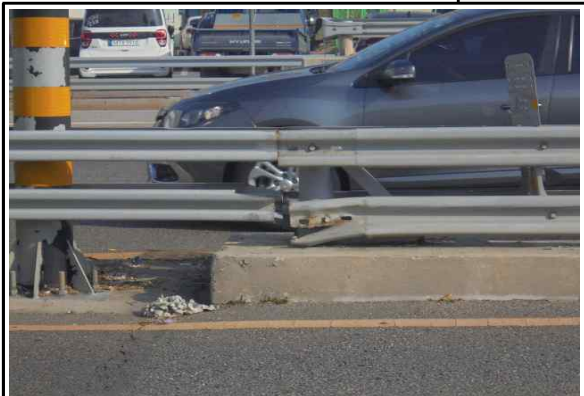
Sta. 000(서울) 난간-중앙분리대 파손 (25년 하반기 정기안전점검)
