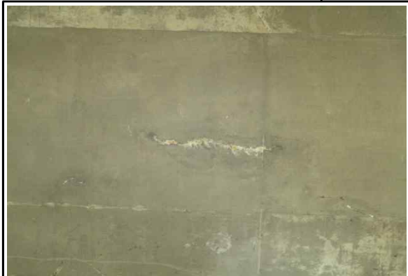
바닥판하면 균열부 백태(cw:0.3mm미만) (25년 하반기 정기안전점검)
