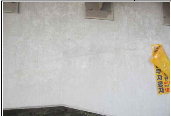
P12 교각-균열(cw:0.3mm미만) (25년 하반기 정기안전점검)
