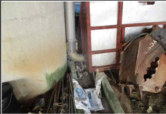
P2 배수시설-배수관 주변 지장물 적치 (25년 하반기 정기안전점검)
