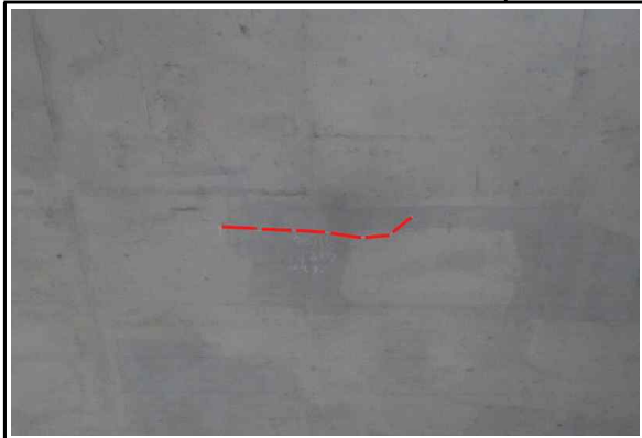
Sta. 013(강화) 슬래브-균열(cw:0.3mm미만) (25년 하반기 정기안전점검)
