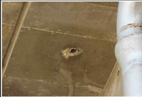
바닥판하면 백태, 유공관 길이부족 (25년 상반기 정기안전점검)
