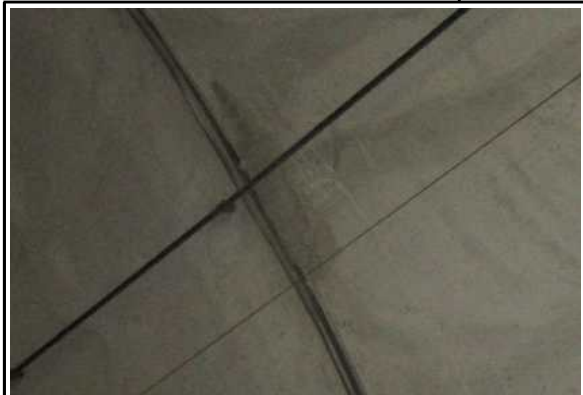
Sta. 047(Span 8) 좌측벽체-박락 (25년 하반기 정기안전점검)
