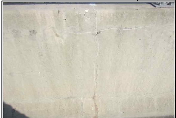
S2 방호울타리-균열(cw:0.3mm미만) (25년 하반기 정기안전점검)
