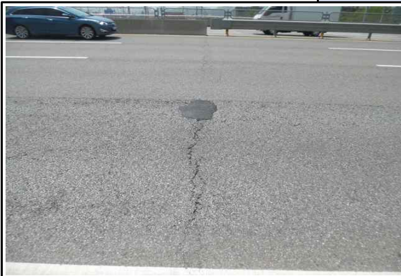
교면포장 포장균열 (25년 상반기 정기안전점검)
