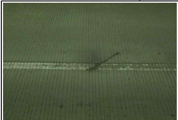
Sta. 097(Span 13) 포장부-잡철근 노출 (25년 하반기 정기안전점검)
