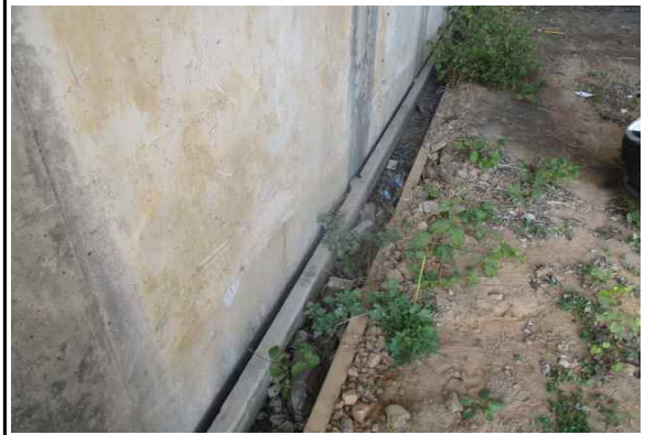
배수시설 배수로 토사퇴적 (25년 하반기 정기안전점검)
