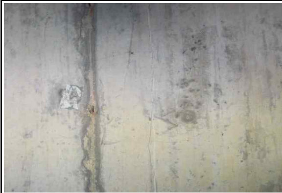
교대 균열(cw:0.3mm미만) (25년 상반기 정기안전점검)
