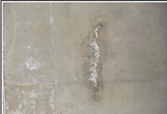
바닥판하면 균열부 백태(cw:0.3mm미만) (25년 상반기 정기안전점검)
