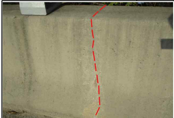
S1 방호울타리-균열(cw:0.3mm미만) (25년 하반기 정기안전점검)
