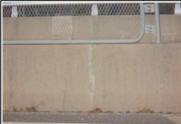
중양분리대 균열(cw:0.3mm이상) (25년 하반기 정기안전점검)
