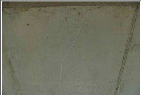
교대 균열(cw:0.3mm미만) (25년 하반기 정기안전점검)
