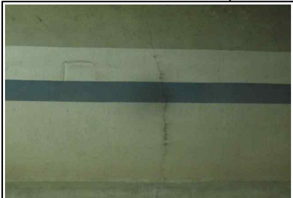
Span12 벽체-균열(cw:0.3mm이상) (25년 하반기 정기안전점검)
