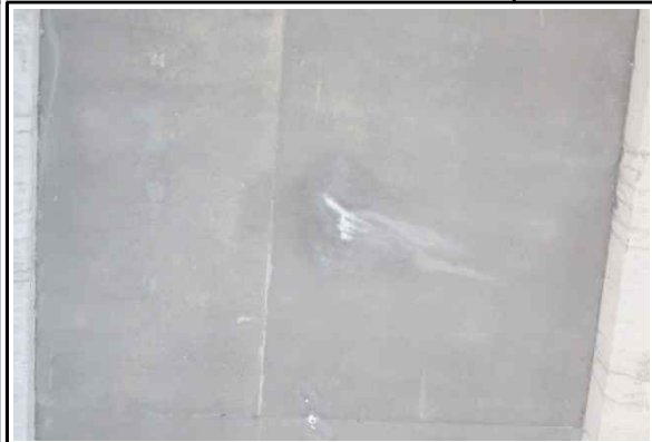
바닥판하면 백태 (25년 하반기 정기안전점검)
