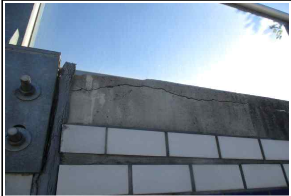
U-Type구간 벽체 파손 (25년 하반기 정기안전점검)
