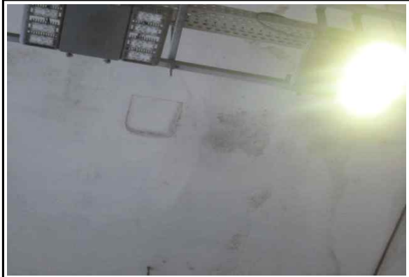
Sta. 017(Span 4) 천단부-표면열화 (25년 하반기 정기안전점검)
