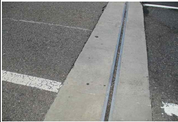
신축이음 후타재 균열(cw:0.3mm미만) (25년 상반기 정기안전점검)
