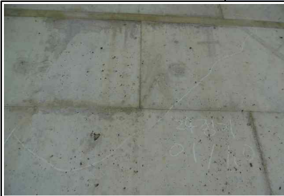
교대 균열(cw:0.3mm미만) (25년 상반기 정기안전점검)
