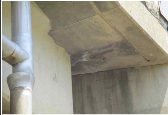
바닥판하면 백태, 유공관 길이부족 (25년 상반기 정기안전점검)
