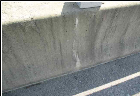
방호벽 균열부 백태(cw:0.3mm미만) (25년 상반기 정기안전점검)
