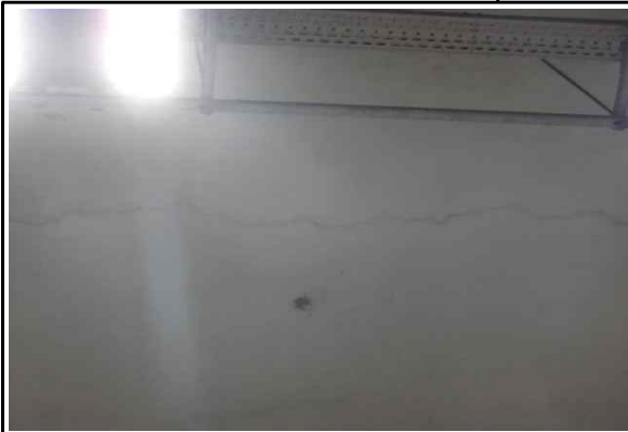
Sta. 128(Span 17) 천단부-균열(cw:0.3mm이상) (25년 상반기 정기안전점검)
