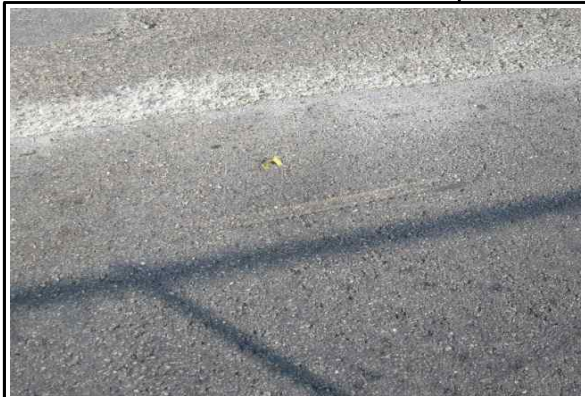
교면포장 포장 패임 (25년 하반기 정기안전점검)
