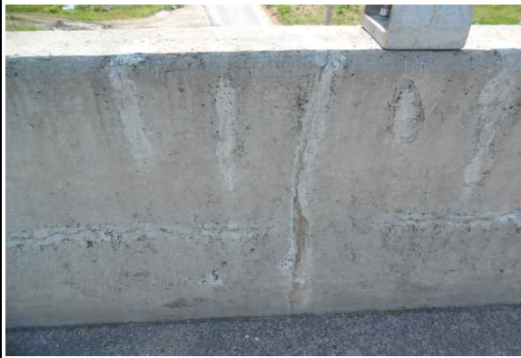
방호벽 균열부 백태(cw:0.3mm 이상) (25년 상반기 정기안전점검)
