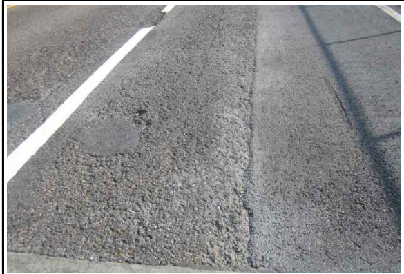
교면포장 포장 열화, 마모 (25년 하반기 정기안전점검)
