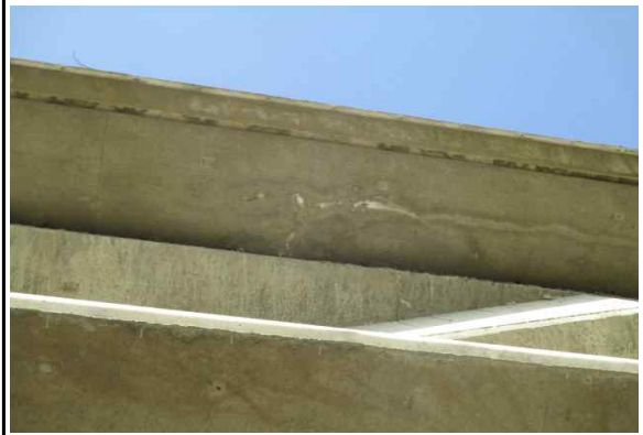
바닥판하면 균열부 백태(cw:0.3mm미만) (25년 하반기 정기안전점검)
