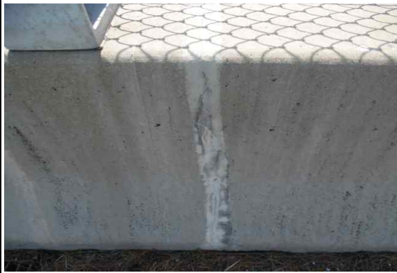
연석 균열(cw:0.3mm미만) (25년 상반기 정기안전점검)
