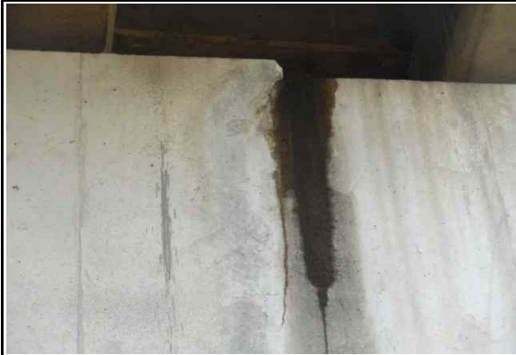
P2(G4~G5) 코핑(전면)-균열(cw:0.3mm미만) (25년 상반기 정기안전점검)
