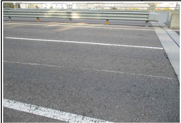
교면포장 접속부 아스콘 망상균열 (25년 하반기 정기안전점검)
