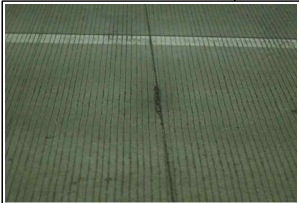
Span12 포장부-파손 (25년 하반기 정기안전점검)
