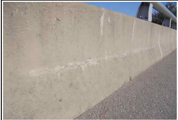
방호벽 균열부 백태(cw:0.3mm이상) (25년 하반기 정기안전점검)
