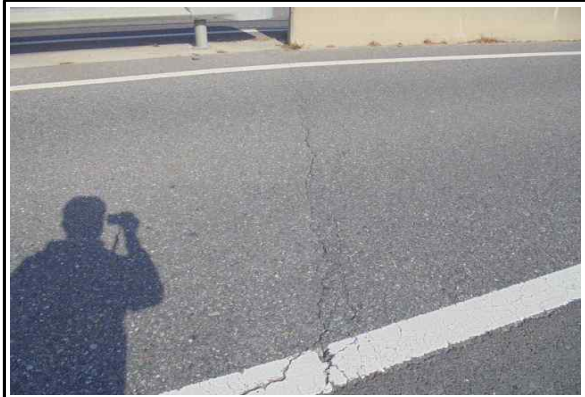
교면포장 접속부 균열 (25년 하반기 정기안전점검)
