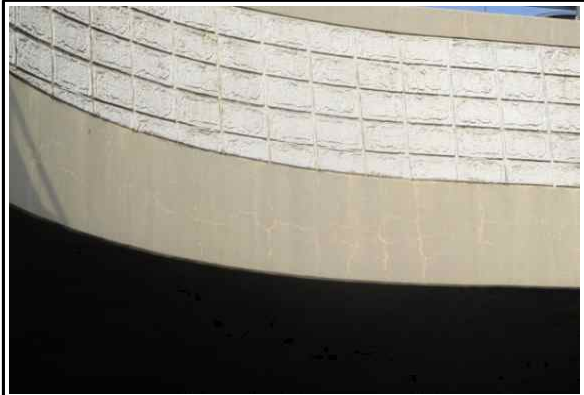
입·출구부-망상균열(cw:0.3mm미만) (25년 하반기 정기안전점검)
