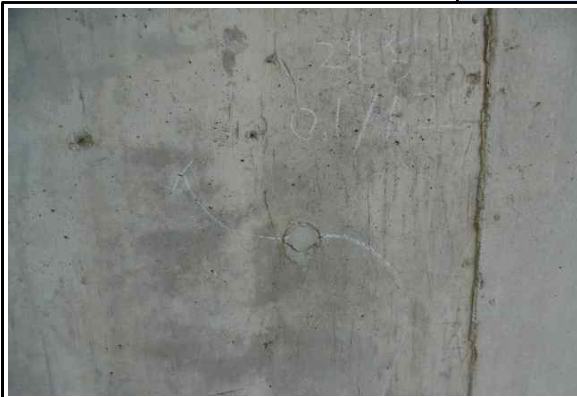
교대 균열(cw:0.3mm미만) (25년 상반기 정기안전점검)
