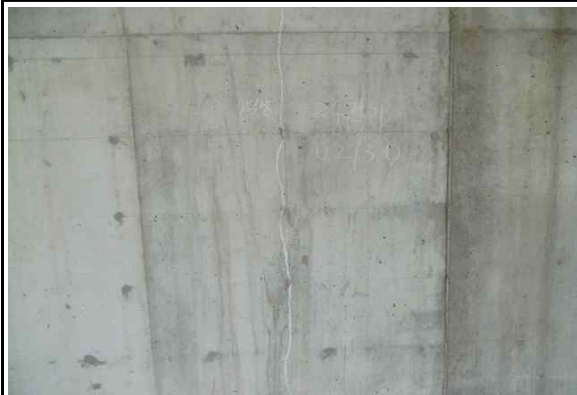
교대 균열(cw:0.3mm미만) (25년 상반기 정기안전점검)
