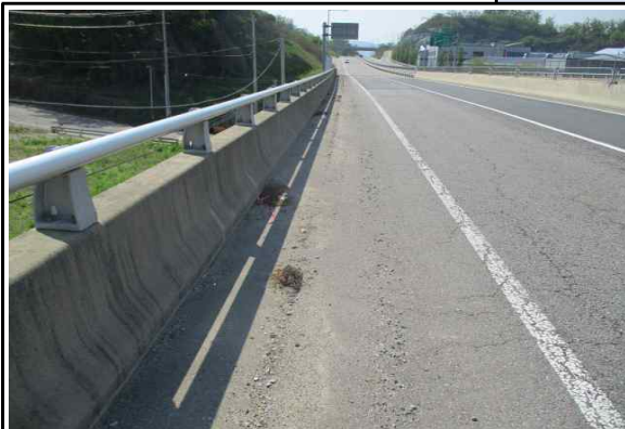
교면포장 토사퇴적 (25년 상반기 정기안전점검)
