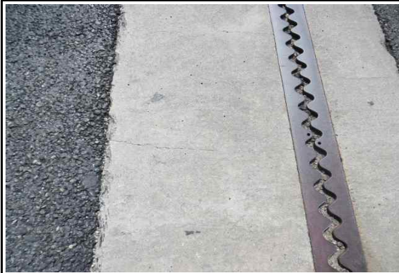
신축이음 후타재 균열(cw:0.3mm미만) (25년 상반기 정기안전점검)
