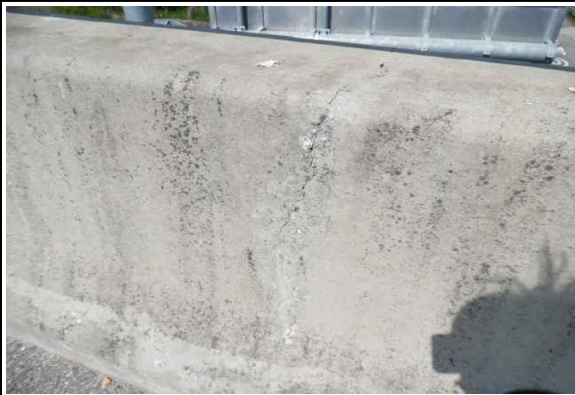
연석 균열(cw:0.3mm미만) (25년 상반기 정기안전점검)
