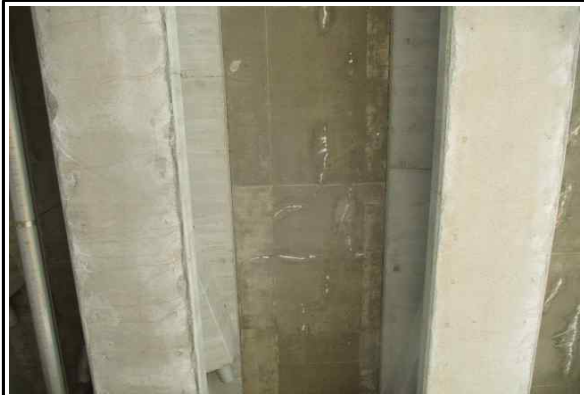
바닥판하면 균열부 백태(cw:0.3mm미만) (25년 하반기 정기안전점검)
