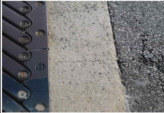
P12(강화) 신축이음-후타재 균열 (25년 상반기 정기안전점검)
