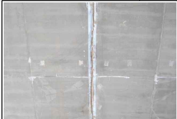
바닥판하면 실런트 열화 (25년 하반기 정기안전점검)
