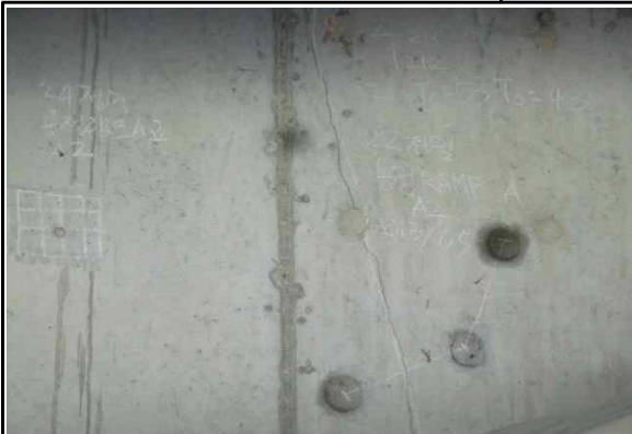
A2 흉벽-균열(cw:0.3mm이상) (25년 상반기 정기안전점검)
