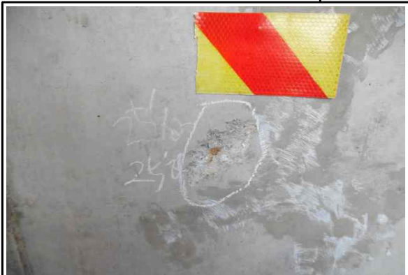
교대 파손 (25년 하반기 정기안전점검)
