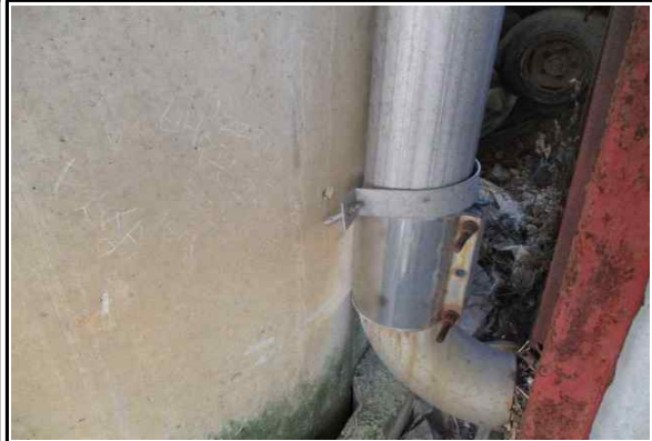
P2 배수시설-배수관 고정앵커 탈락 (25년 하반기 정기안전점검)
