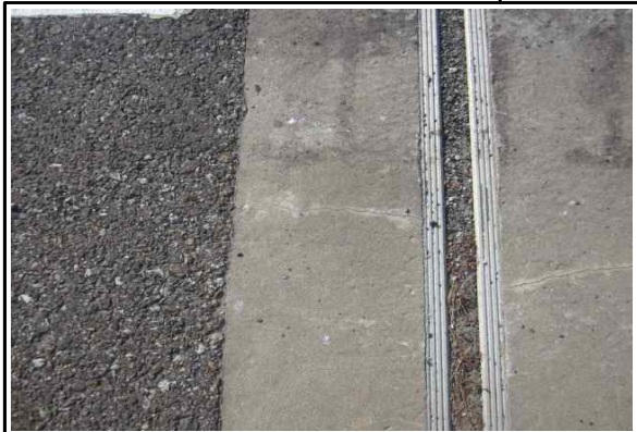
신축이음 후타재 균열(cw:0.3mm미만) (25년 하반기 정기안전점검)
