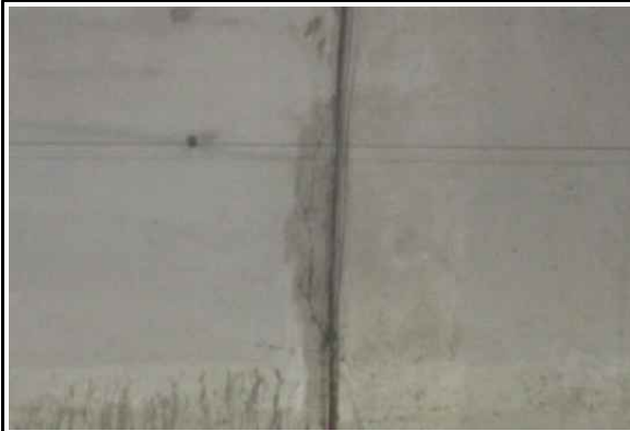
Span 14 중앙벽체-박리 (25년 상반기 정기안전점검)
