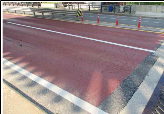
S1(서울) 교면포장-접속부 아스콘 망상균열 (25년 상반기 정기안전점검)
