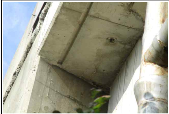
바닥판하면 백태, 유공관 길이부족 (25년 하반기 정기안전점검)
