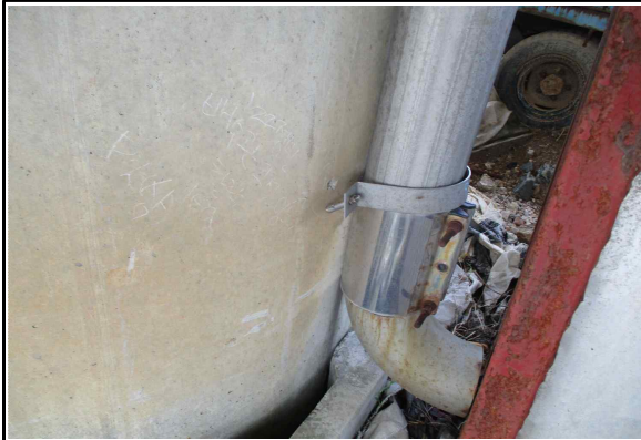
P2 배수시설-배수관 고정앵커 탈락 (25년 상반기 정기안전점검)
