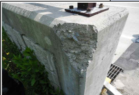
U-Type구간 옹벽 파손 (25년 상반기 정기안전점검)
