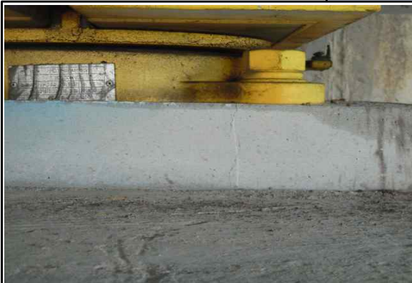
A1-Sh1 반침물탈-균열(cw:0.3mm미만) (25년 상반기 정기안전점검)
