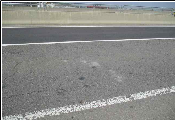
교면포장 아스콘 망상균열 (25년 상반기 정기안전점검)
