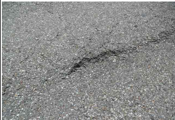
교면포장 포트홀 (25년 상반기 정기안전점검)
