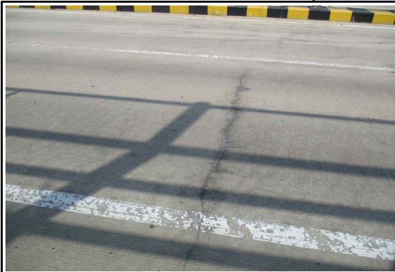
포장부 균열 (25년 상반기 정기안전점검)
