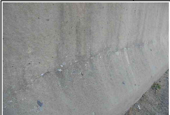
방호벽 균열(cw:0.3mm미만) (25년 하반기 정기안전점검)
