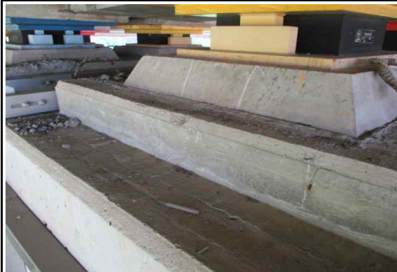
받침장치 받침콘크리트 균열(cw:0.3mm미만) (25년 상반기 정기안전점검)
