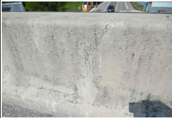
연석 균열(cw:0.3mm미만) (25년 상반기 정기안전점검)
