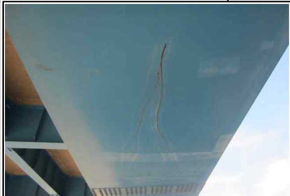
S3-G1 거더외부-균열 (25년 하반기 정기안전점검)
