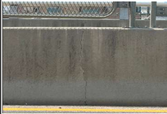
중앙분리대 균열(cw:0.3mm이상) (25년 상반기 정기안전점검)
