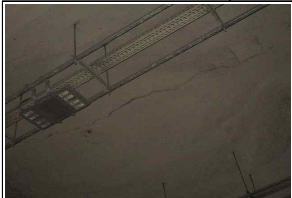
Sta. 074(Span 11) 천단부-균열(cw:0.3mm이상) (25년 하반기 정기안전점검)
