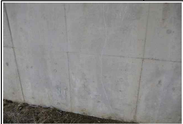
교대 균열(cw:0.3mm미만) (25년 하반기 정기안전점검)
