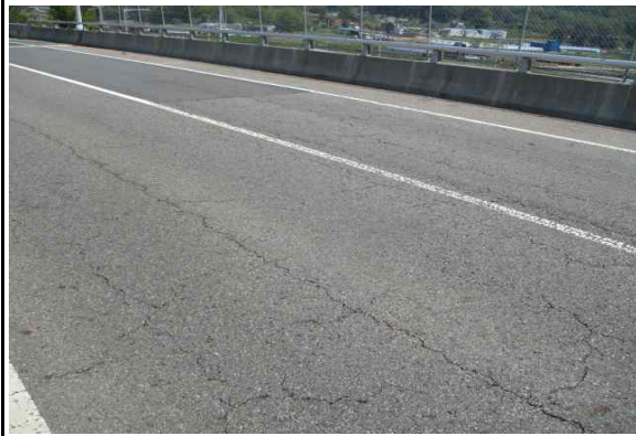
교면포장 포장 망상균열 (25년 상반기 정기안전점검)
