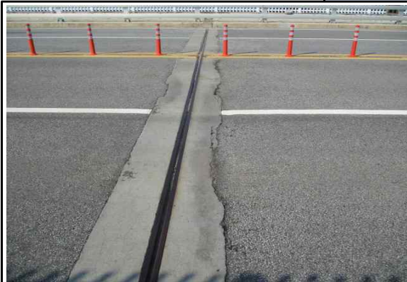
P9(서울) 신축이음-후타재 파손 (25년 상반기 정기안전점검)
