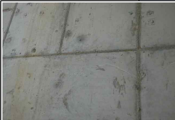
교대 균열(cw:0.3mm미만) (25년 상반기 정기안전점검)
