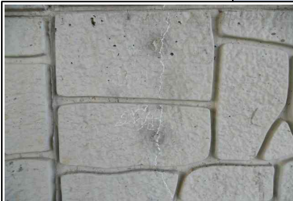
교대 균열(cw:0.3mm미만) (25년 상반기 정기안전점검)
