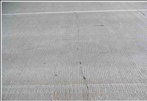
Sta. 021(Span 4~5) 포장부-균열 (25년 상반기 정기안전점검)
