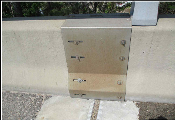
A1 신축이음-차수판 볼트 체결불량 (25년 상반기 정기안전점검)
