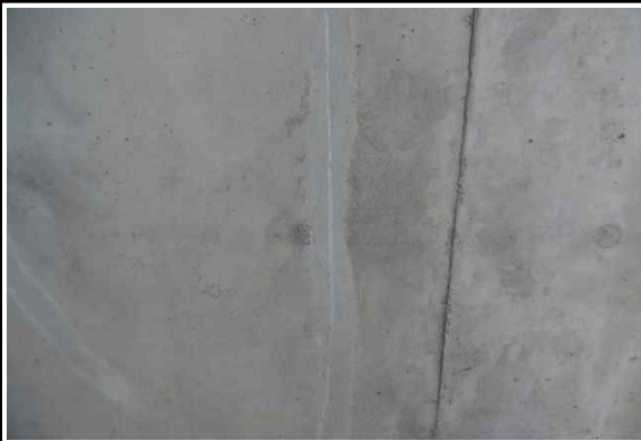
교대 보수부 재균열(cw:0.3mm미만) (25년 상반기 정기안전점검)
