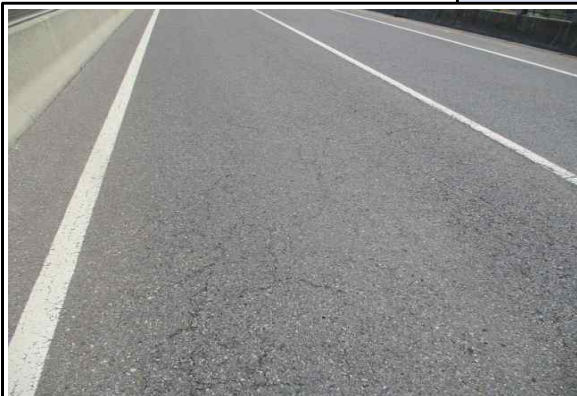
교면포장 아스콘 망상균열 (25년 상반기 정기안전점검)
