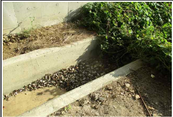
배수시설 배수로 토사퇴적 (25년 하반기 정기안전점검)
