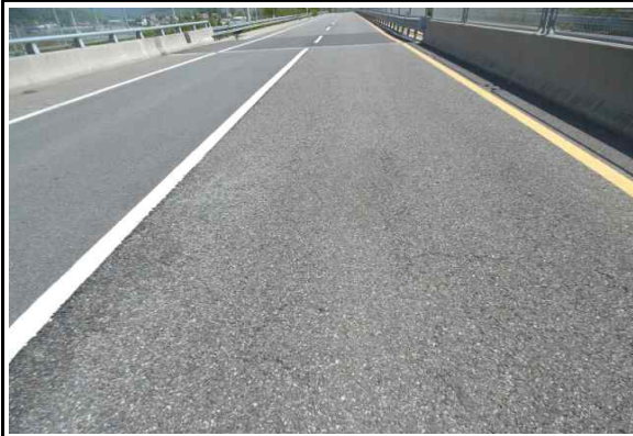
교면포장 포장 열화, 마모 (25년 상반기 정기안전점검)
