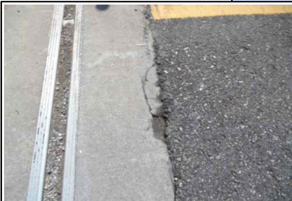
신축이음 후타재 파손 (25년 상반기 정기안전점검)
