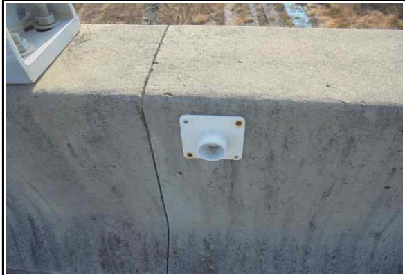
S3 방호벽-텔리네이트 파손 (25년 하반기 정기안전점검)
