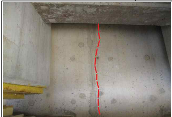
A2 흥벽-균열(cw:0.3mm미만) (25년 하반기 정기안전점검)
