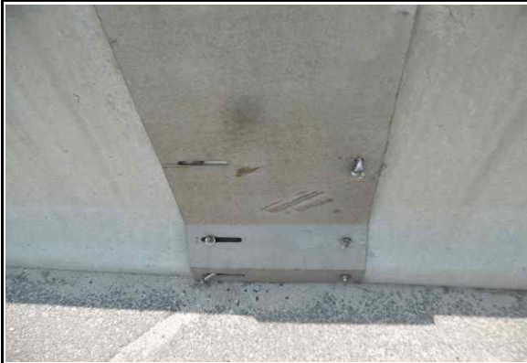
A2 신축이음-차수판 볼트 체결불량 (25년 상반기 정기안전점검)
