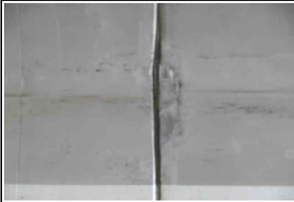
Sta. 209(Span 26) 중앙벽체-박리 (25년 상반기 정기안전점검)
