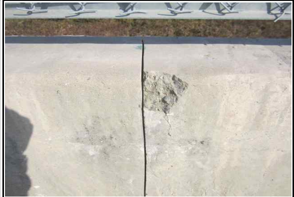
S1 방호울타리-파손 (25년 하반기 정기안전점검)
