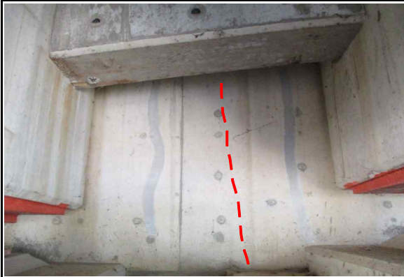
A1(G1~G2) 흥벽-균열(cw:0.3mm미만) (25년 상반기 정기안전점검)
