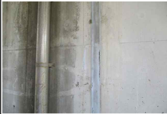
교대 실링재 파손 (25년 상반기 정기안전점검)
