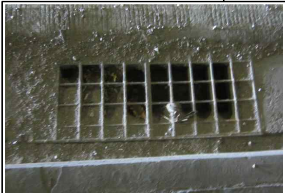
Span11 배수시설-배수구 막힘 (25년 하반기 정기안전점검)
