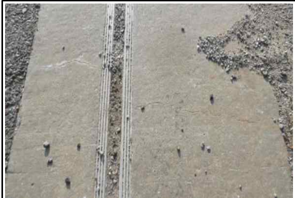
신축이음 후타재 균열(cw:0.3mm미만) (25년 하반기 정기안전점검)
