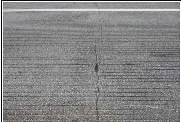
Sta. 015(강화) 시점옹벽-포장 균열 (25년 하반기 정기안전점검)
