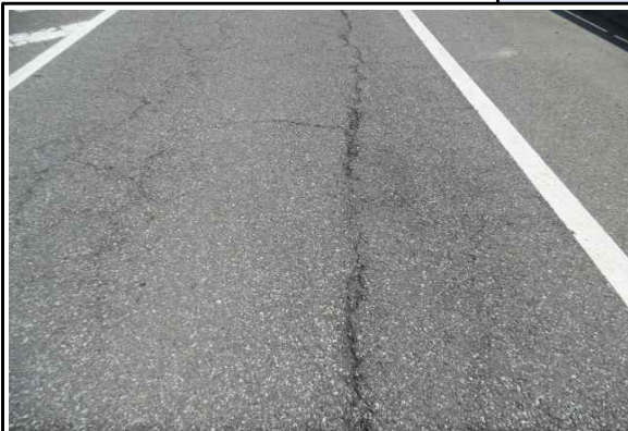
교면포장 포장 균열 (25년 상반기 정기안전점검)
