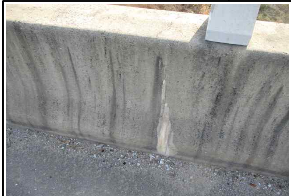
방호벽 균열부 백태(cw:0.3mm미만) (25년 하반기 정기안전점검)
