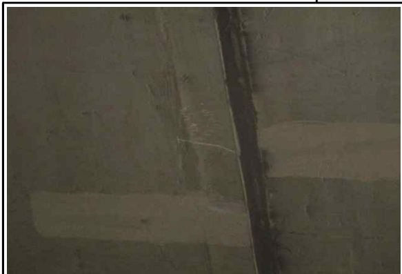
BOX 상부슬래브 하면-균열(cw:0.3mm미만) (25년 하반기 정기안전점검)
