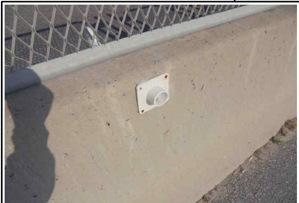
중앙분리대 텔리네이트 파손 (25년 하반기 정기안전점검)
