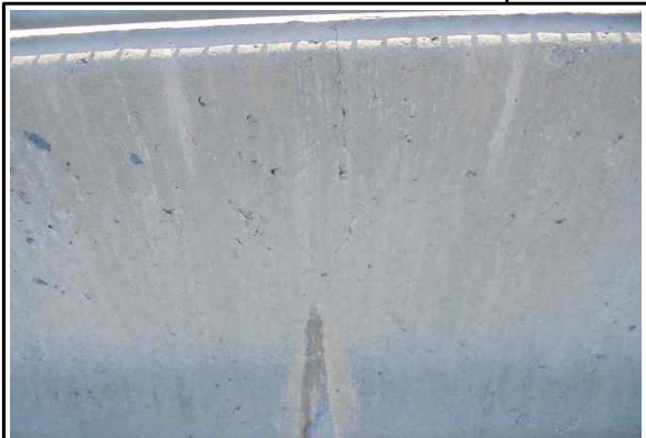
중앙분리대 균열부 백태(cw:0.3mm 미만) (25년 하반기 정기안전점검)
