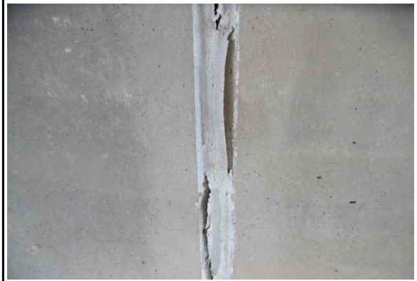
교대 전면부 실링재 파손 (25년 하반기 정기안전점검)
