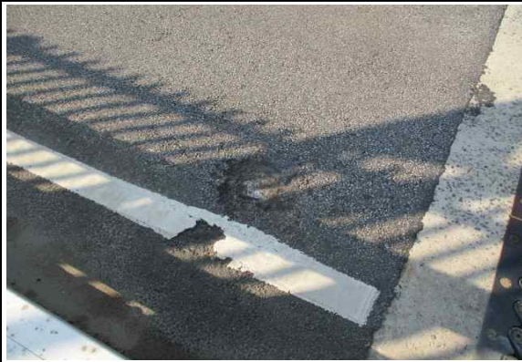
S12(서울) 교면포장-파손, 소성변형 (25년 상반기 정기안전점검)
