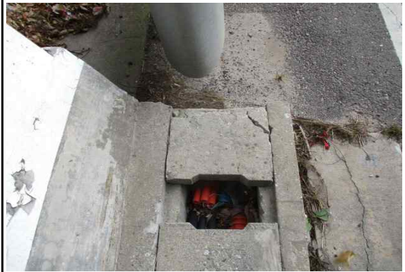
Sta. 235(중점 갭문) 공동구-덮개파손 (25년 하반기 정기안전점검)
