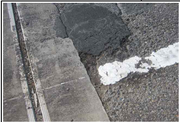
교면포장 포트홀 (25년 하반기 정기안전점검)
