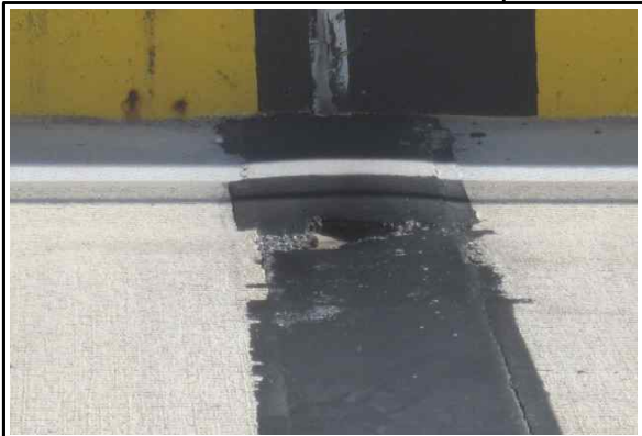
포장부 조인트 파손 (25년 하반기 정기안전점검)
