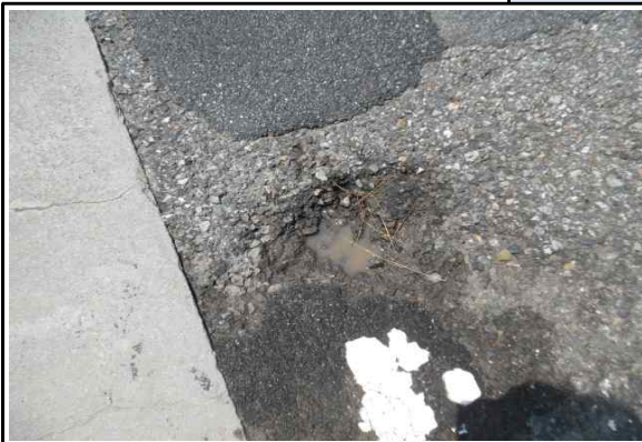
교면포장 포트홀 (25년 상반기 정기안전점검)
