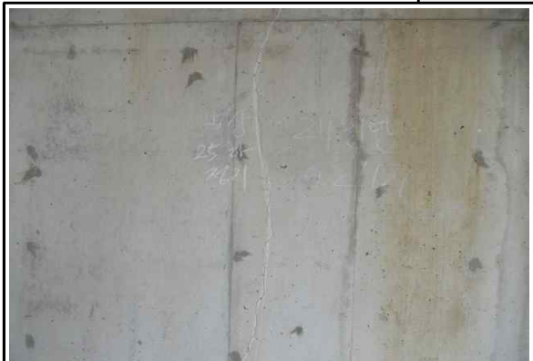
교대 균열(cw:0.3mm미만) (25년 하반기 정기안전점검)
