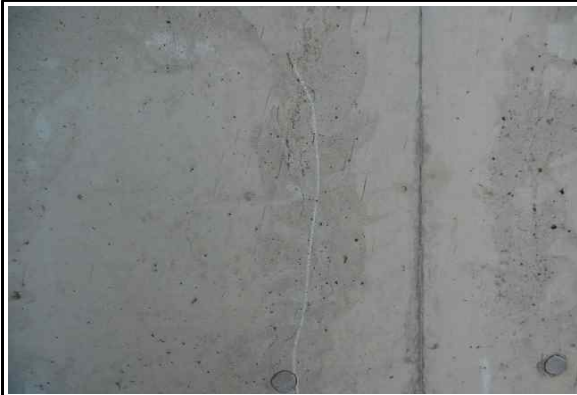
교대 균열(cw:0.3mm미만) (25년 상반기 정기안전점검)
