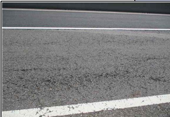
S2 교면포장-아스콘 망상균열 (25년 상반기 정기안전점검)
