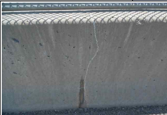
중앙분리대 균열부 백태(cw:0.3mm 미만) (25년 상반기 정기안전점검)
