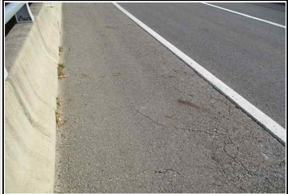
S4 교면포장-아스콘 균열 (25년 하반기 정기안전점검)
