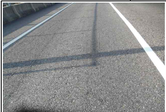
교면포장 포장 균열 (25년 하반기 정기안전점검)
