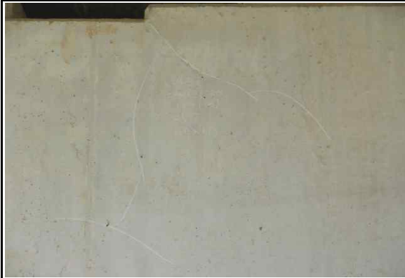
P3 코핑(배면)-망상균열(cw:0.3mm미만) (25년 상반기 정기안전점검)
