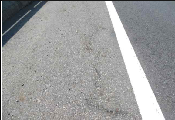
S4 교면포장-포장균열 (25년 상반기 정기안전점검)
