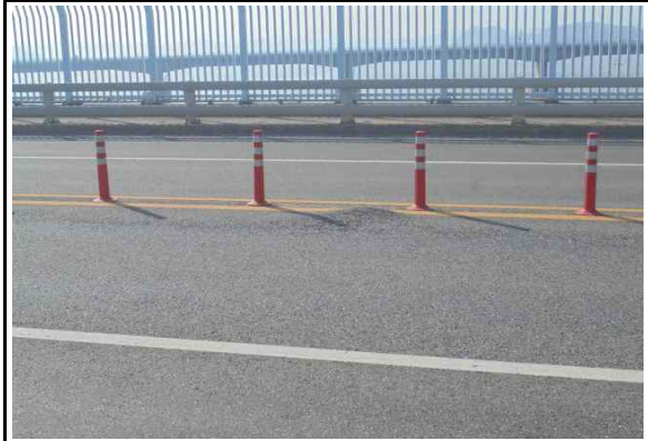
S6(강화) 교면포장-소성변형 (25년 하반기 정기안전점검)
