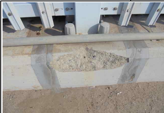
S10(강화) 연석-파손 (25년 하반기 정기안전점검)
