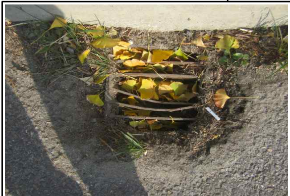
배수시설 배수구 막힘 (25년 하반기 정기안전점검)
