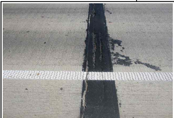
포장부 조인트 파손 (25년 하반기 정기안전점검)
