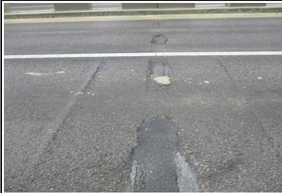
Sta. 060(서울) BOX-포장 파손 (25년 상반기 정기안전점검)
