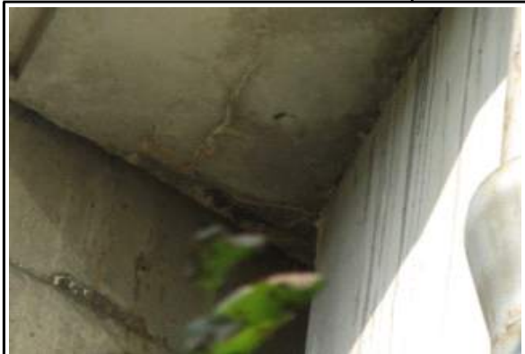
바닥판하면 균열부 백태(cw:0.3mm미만) (25년 하반기 정기안전점검)
