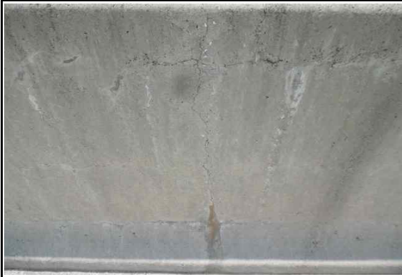
S3 방호울타리-균열(cw:0.3mm미만) (25년 상반기 정기안전점검)
