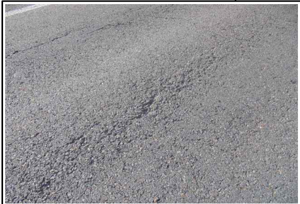
교면포장 포장 파손 (25년 하반기 정기안전점검)
