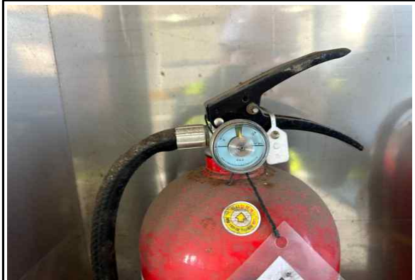
소화시설 소화기 상태양호 (25년 하반기 정기안전점검)
