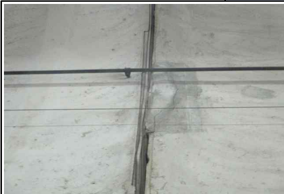
Sta. 137(Span 18) 좌측벽체-박리 (25년 상반기 정기안전점검)
