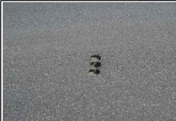
S6(강화) 교면포장-코어홀 미복구 (25년 상반기 정기안전점검)
