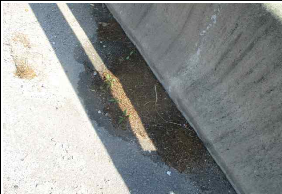
배수시설 배수구 막힘 (25년 상반기 정기안전점검)
