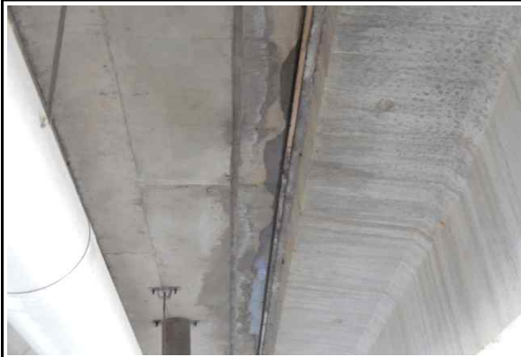
바닥판하면 종조인트 누수 (25년 상반기 정기안전점검)
