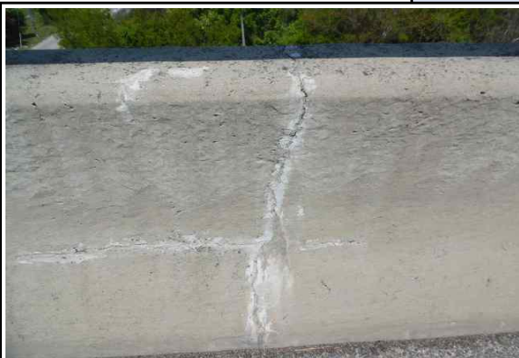
방호벽 균열부 백태(cw:0.3mm이상) (25년 상반기 정기안전점검)
