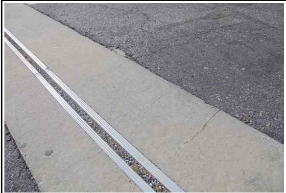
신축이음 후타재 균열(cw:0.3mm미만) (25년 하반기 정기안전점검)
