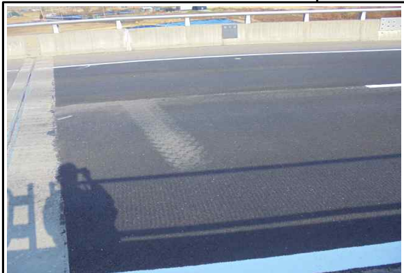
교면포장 접속부 망상균열 보수완료 (25년 하반기 정기안전점검)
