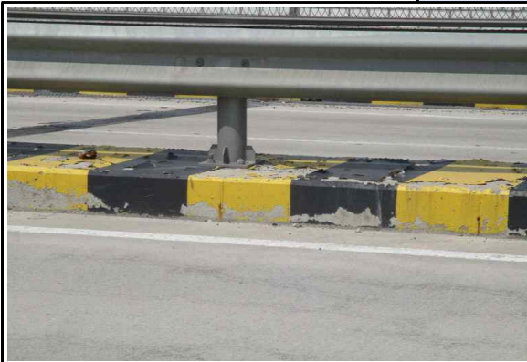
중앙분리대 연석 도장박리 (25년 상반기 정기안전점검)
