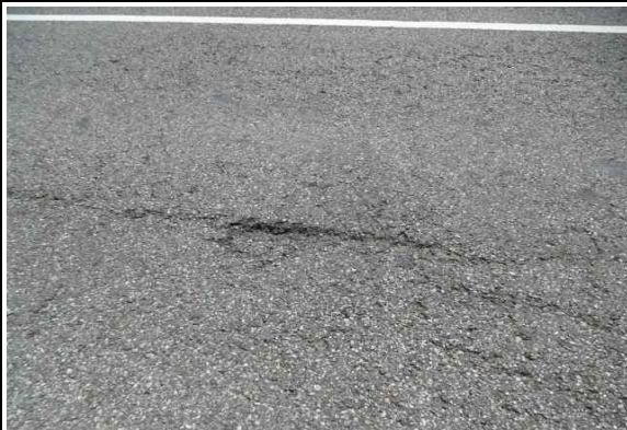
교면포장 포트홀 (25년 상반기 정기안전점검)
