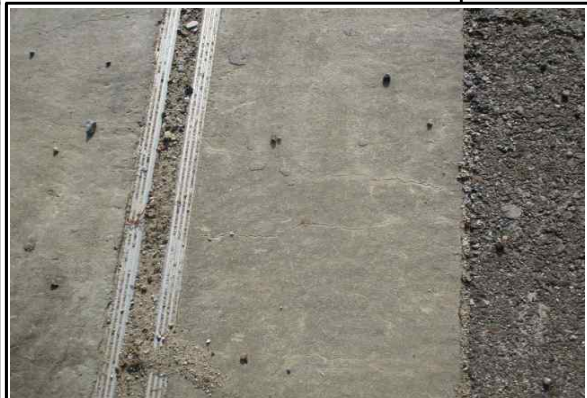
A1 신축이음-후타재 균열(cw:0.3mm미만) (25년 하반기 정기안전점검)
