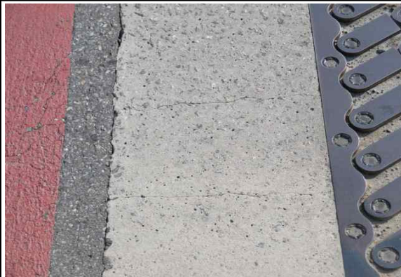
A2(강화) 신축이음-후타재 균열 (25년 상반기 정기안전점검)
