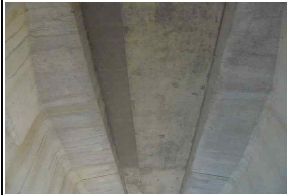
바닥판하면 망상균열(cw:0.3mm미만) (25년 하반기 정기안전점검)
