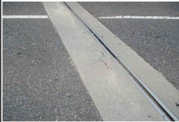
신축이음 후타재 파손 (25년 상반기 정기안전점검)
