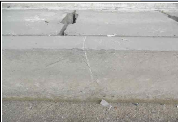
Sta. 112(Span 15) 공동구-균열(cw:0.3mm미만) (25년 상반기 정기안전점검)
