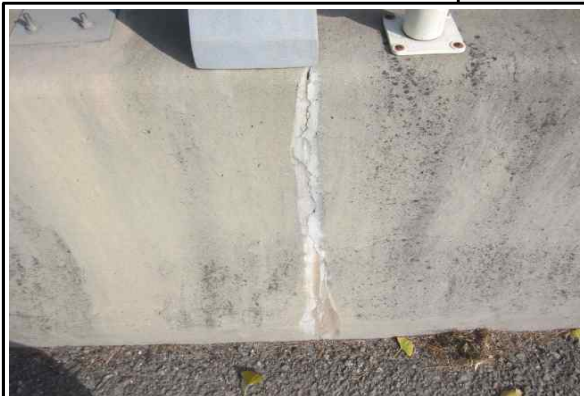
방호벽 균열(cw:0.3mm미만) (25년 하반기 정기안전점검)
