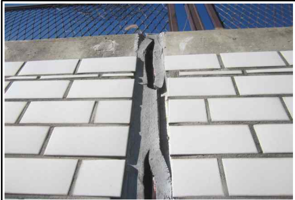
U-Type구간 실런트 파손 (25년 하반기 정기안전점검)
