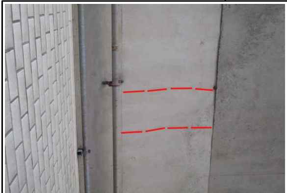
BOX구간 상부슬래브 하면 균열(cw:0.3mm미만) (25년 하반기 정기안전점검)
