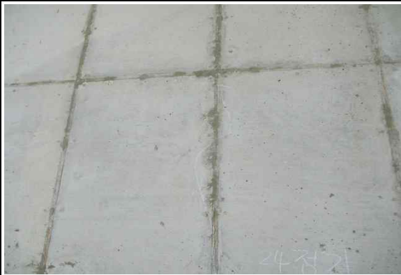
교대 균열(cw:0.3mm미만) (25년 상반기 정기안전점검)
