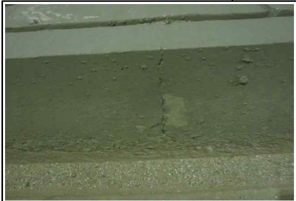
Sta. 112(Span 15) 공동구-균열(cw:0.3mm미만) (25년 하반기 정기안전점검)
