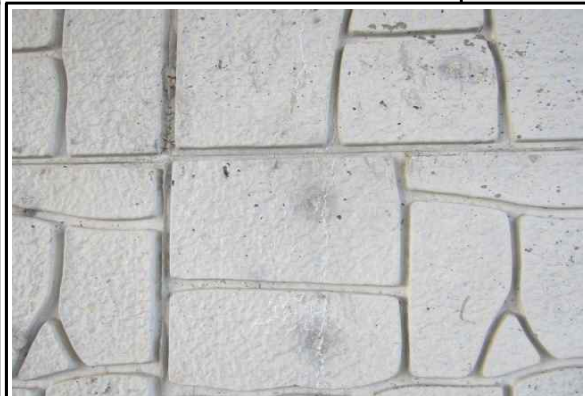
교대 균열(cw:0.3mm미만) (25년 하반기 정기안전점검)
