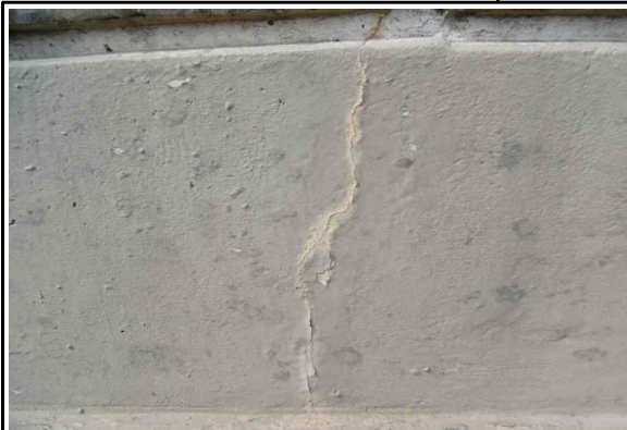
U-Type 옹벽-균열부 백태(cw:0.3mm미만) (25년 상반기 정기안전점검)
