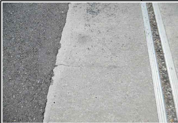
신축이음 후타재 균열(cw:0.3mm미만) (25년 상반기 정기안전점검)
