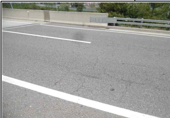
종점 접속부 교면포장-포장망상균열 (25년 상반기 정기안전점검)
