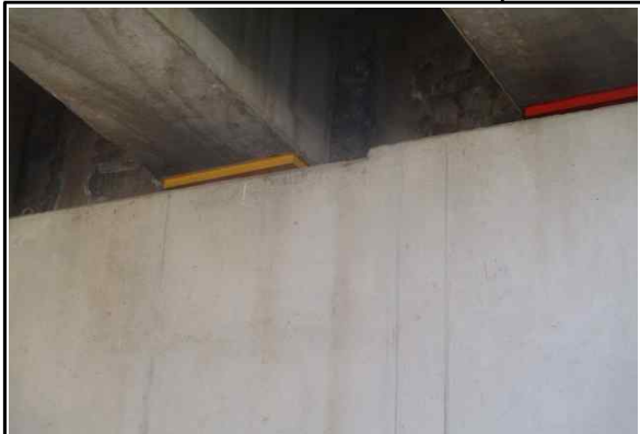
P3(G4~G5) 코핑(후면)-균열(cw:0.3mm미만) (25년 하반기 정기안전점검)
