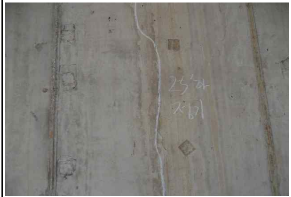
교대 균열(cw:0.3mm미만) (25년 하반기 정기안전점검)
