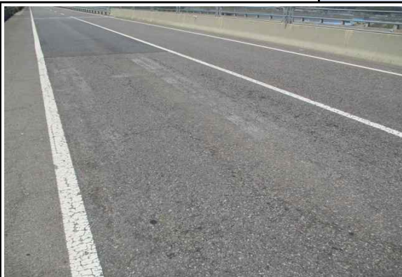
교면포장 포장 망상균열 (25년 상반기 정기안전점검)
