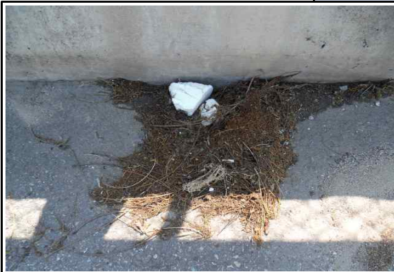
배수시설 배수구 막힘 (25년 상반기 정기안전점검)
