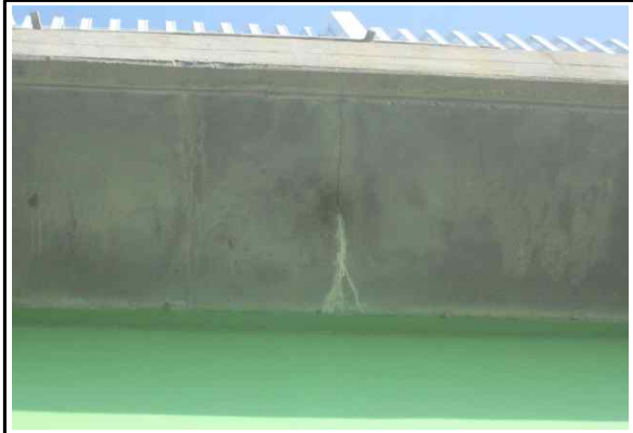
S1 캔틸레버-균열부 백태 (25년 하반기 정기안전점검)
