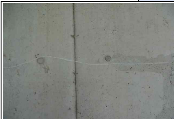
교대 균열(cw:0.3mm미만) (25년 상반기 정기안전점검)
