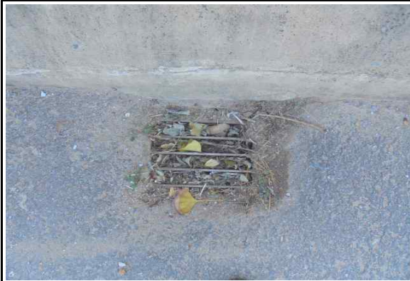
배수시설 배수구 막힘 (25년 하반기 정기안전점검)
