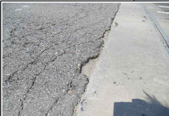
교면포장 접속부 포장 파손 (25년 상반기 정기안전점검)
