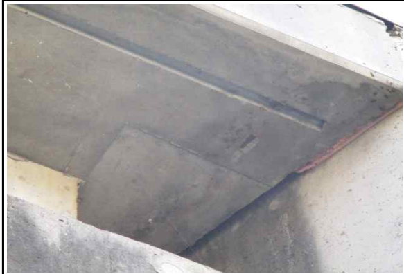
바닥판하면 철근노출 (25년 하반기 정기안전점검)
