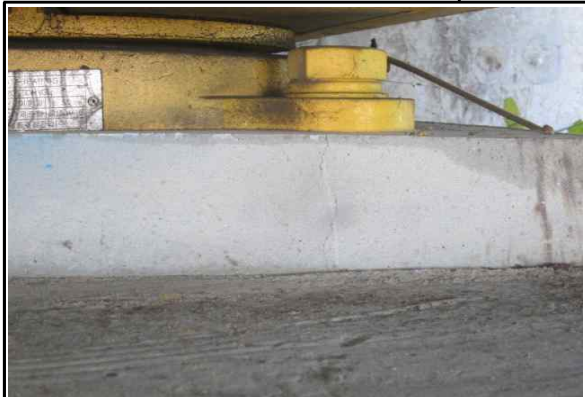
A1-Sh1 반침물탈-균열(cw:0.3mm미만) (25년 하반기 정기안전점검)
