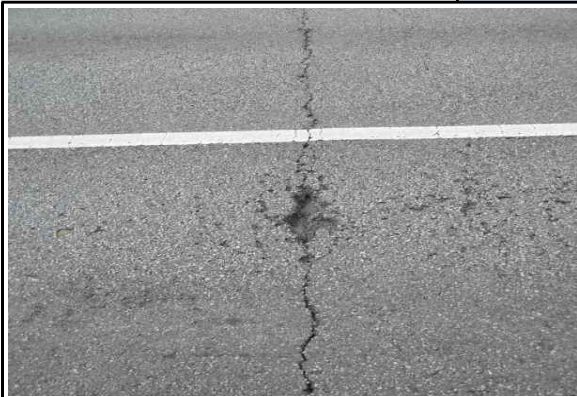
포장부-파손 (25년 상반기 정기안전점검)
