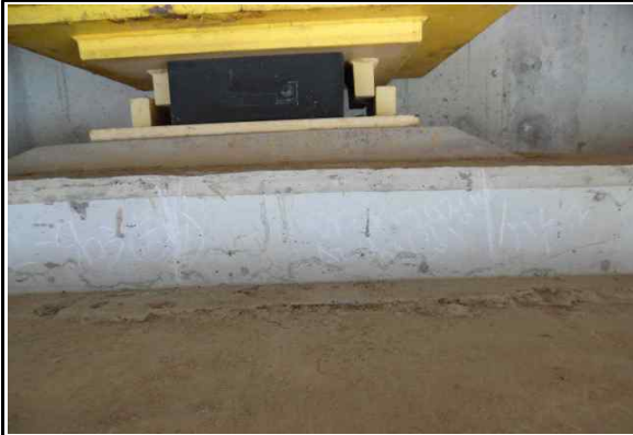
A2-Sh3 받침콘크리트 균열(cw:0.3mm미만) (25년 상반기 정기안전점검)
