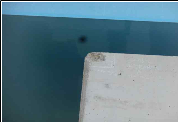
P1 코핑-파손 (25년 상반기 정기안전점검)
