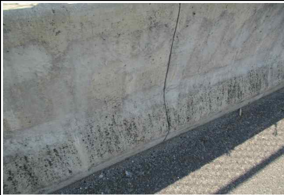
방호벽 균열(cw:0.3mm미만) (25년 상반기 정기안전점검)
