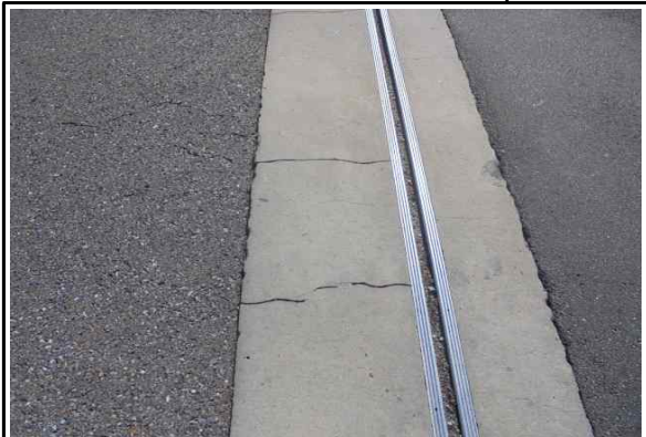
신축이음 후타재 균열(cw:0.3mm이상) (25년 하반기 정기안전점검)
