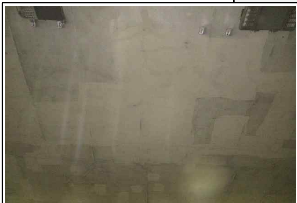
BOX 상부슬래브 하면-망상균열(cw:0.3mm미만) (25년 하반기 정기안전점검)
