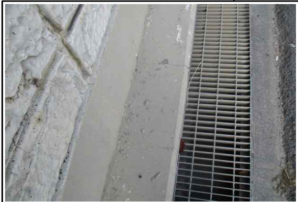
연석-균열(cw:0.3mm미만) (25년 하반기 정기안전점검)
