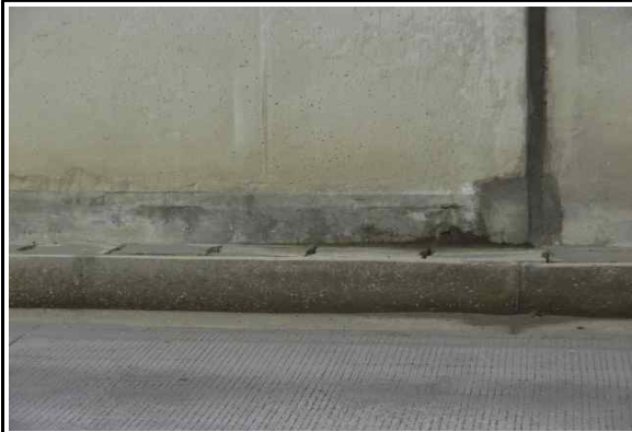
Sta. 109(Span 14) 중앙벽체-백태 (25년 상반기 정기안전점검)
