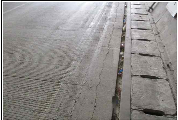
Sta. 011(Span 4) 포장부-균열 (25년 하반기 정기안전점검)
