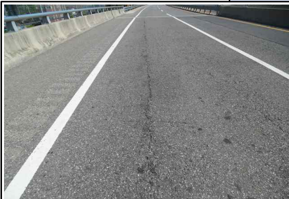
교면포장 포장 균열 (25년 상반기 정기안전점검)
