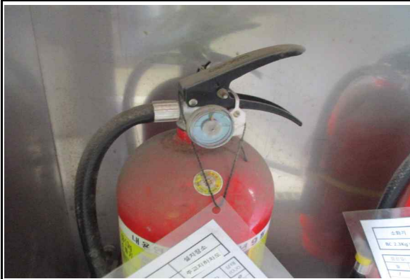
소화시설 소화기 상태양호 (25년 상반기 정기안전점검)
