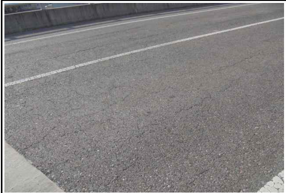
교면포장 포장 균열 (25년 하반기 정기안전점검)
