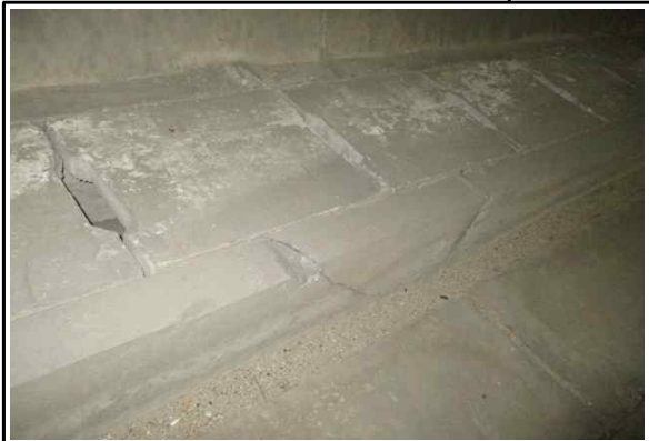
Sta. 83(Span 11) 공동구-파손 (25년 하반기 정기안전점검)
