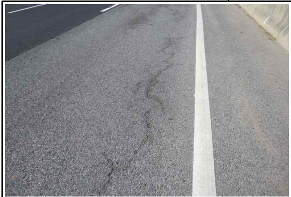
교면포장 포장균열 (25년 하반기 정기안전점검)
