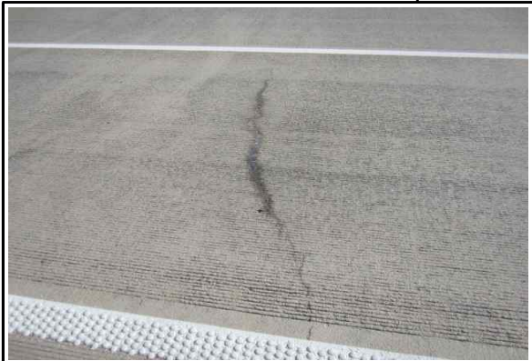
포장부 균열 (25년 하반기 정기안전점검)
