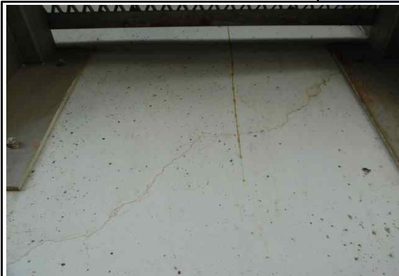
P12 교각-균열(cw:0.3mm미만) (25년 상반기 정기안전점검)
