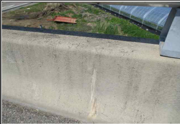
S3 방호울타리-균열(cw:0.3mm미만) (25년 상반기 정기안전점검)
