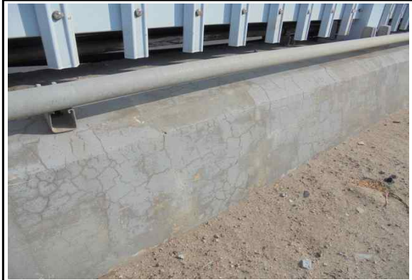
S7(강화) 연석 보수부-망상균열(cw:0.3mm미만) (25년 하반기 정기안전점검)
