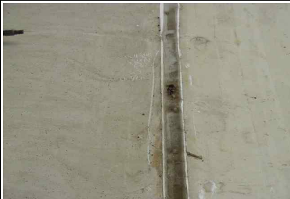
시점(Span 2) 갭문-박리 (25년 상반기 정기안전점검)
