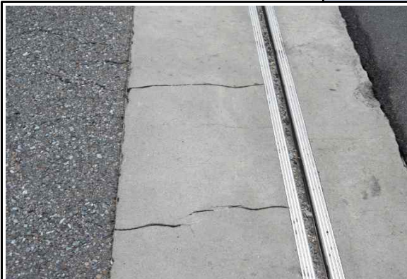
신축이음 후타재 균열(cw:0.3mm이상) (25년 상반기 정기안전점검)
