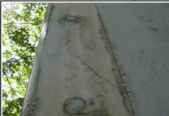
교대 균열(cw:0.3mm미만) (25년 상반기 정기안전점검)
