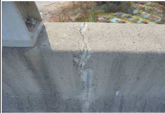
방호벽 균열(cw:0.3mm이상) (25년 하반기 정기안전점검)
