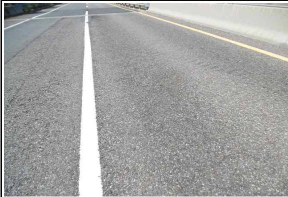
교면포장 포장 열화 (25년 상반기 정기안전점검)
