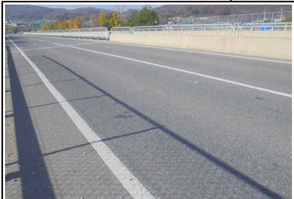
교면포장 아스콘 망상균열 (25년 하반기 정기안전점검)
