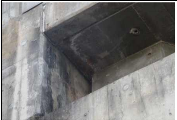
바닥판하면 백태 및 층분리 (25년 하반기 정기안전점검)
