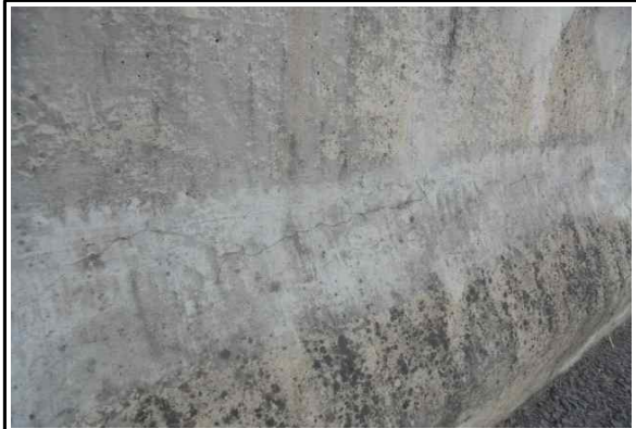
방호벽 균열(cw:0.3mm미만) (25년 하반기 정기안전점검)
