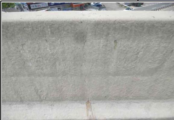
S2 방호울타리-균열(cw:0.3mm미만) (25년 상반기 정기안전점검)
