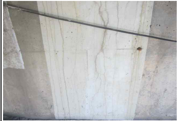
A1 교대-보수부 재균열(cw:0.3mm미만) (25년 하반기 정기안전점검)
