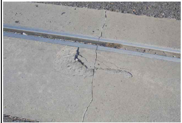
신축이음 후타재 파손 (25년 하반기 정기안전점검)
