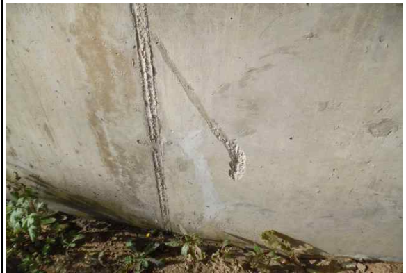
교대 파손 (25년 하반기 정기안전점검)
