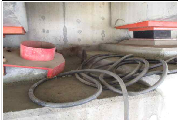
A1 교량받침면-채수흔적 (25년 하반기 정기안전점검)
