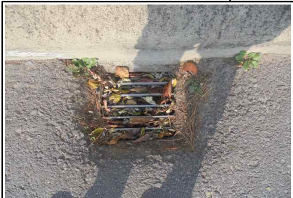
배수시설 배수구 막힘 (25년 하반기 정기안전점검)
