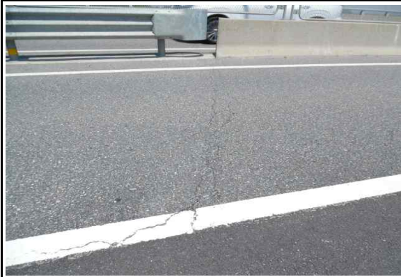
교면포장 접속부 균열 (25년 상반기 정기안전점검)
