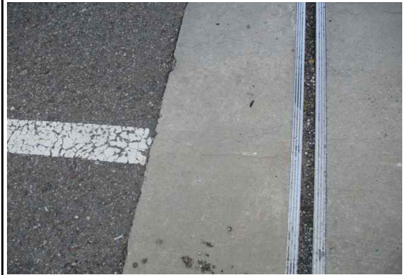
신축이음 후타재 균열(cw:0.3mm미만) (25년 하반기 정기안전점검)
