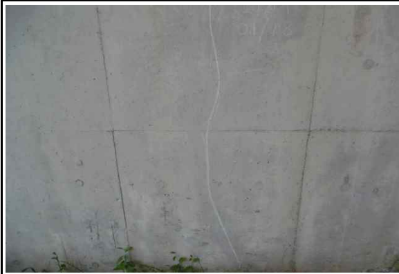
교대 균열(cw:0.3mm미만) (25년 상반기 정기안전점검)
