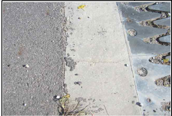
A1 신축이음-후타재 균열(cw:0.3mm미만) (25년 하반기 정기안전점검)
