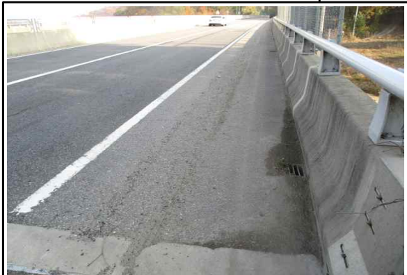
교면포장 토사퇴적 (25년 하반기 정기안전점검)
