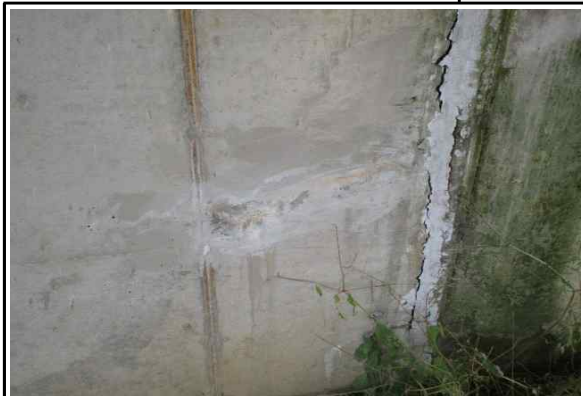
교대 균열부 백태(cw:0.3mm미만) (25년 하반기 정기안전점검)
