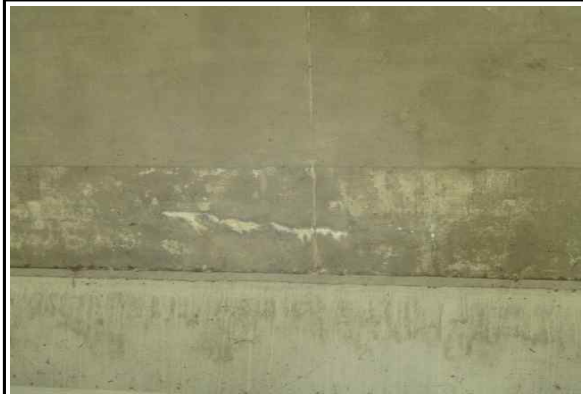
바닥판하면 균열부 백태(cw:0.3mm미만) (25년 하반기 정기안전점검)
