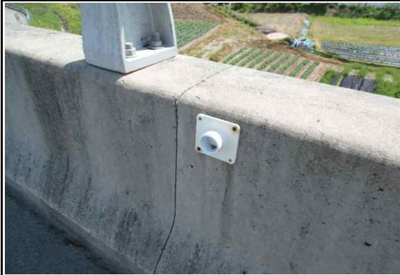
S3 방호벽-텔리네이트 파손 (25년 상반기 정기안전점검)
