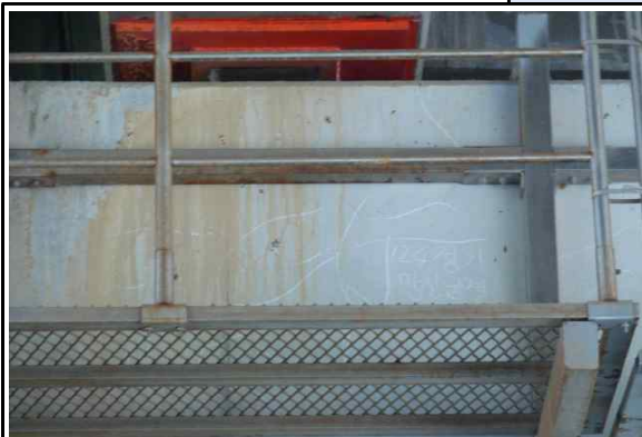
교각 망상균열(cw:0.3mm미만) (25년 상반기 정기안전점검)
