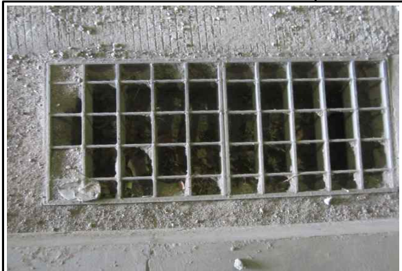
Sta. 022(Span 5) 배수구-토사퇴적 (25년 하반기 정기안전점검)
