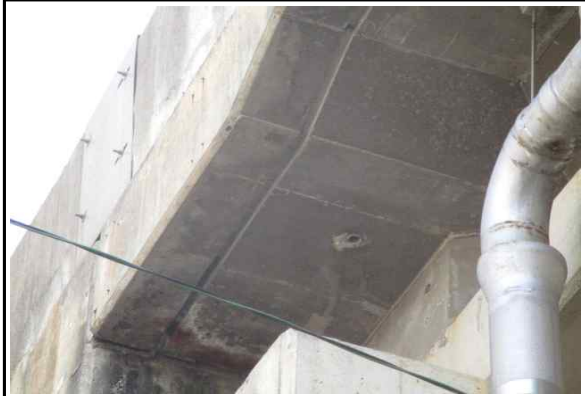
바닥판하면 백태, 유공관 길이부족 (25년 하반기 정기안전점검)
