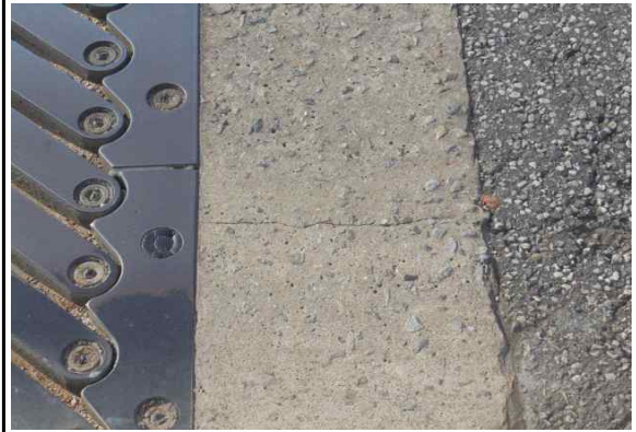
P12(강화) 신축이음-후타재 균열 (25년 하반기 정기안전점검)
