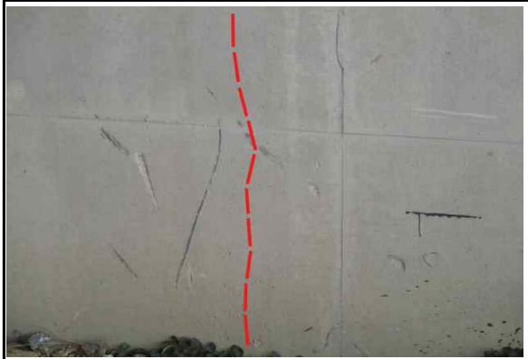
교대 균열(cw:0.3mm미만) (25년 하반기 정기안전점검)
