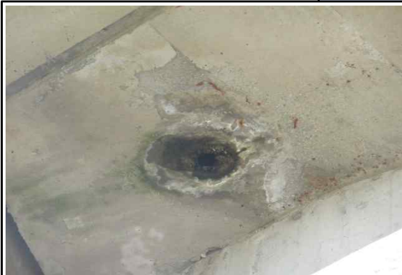
바닥판하면 백태, 유공관 길이부족 (25년 상반기 정기안전점검)
