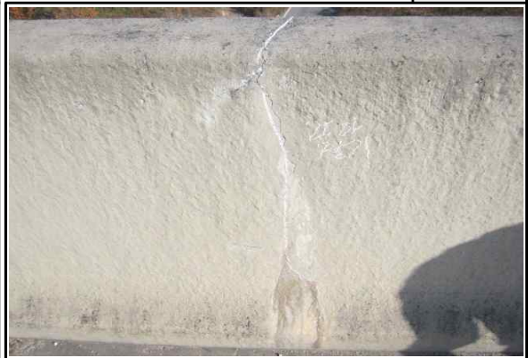
S1 방호울타리-균열부 백태(cw:0.3mm미만) (25년 하반기 정기안전점검)
