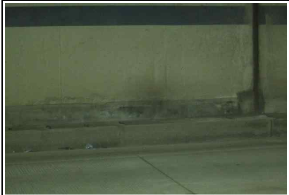
Sta. 109(Span 14) 중앙벽체-백태 (25년 하반기 정기안전점검)
