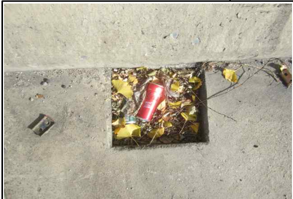
S1 배수시설-배수구 막힘 (25년 하반기 정기안전점검)
