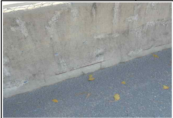
방호벽 철근노출 (25년 하반기 정기안전점검)
