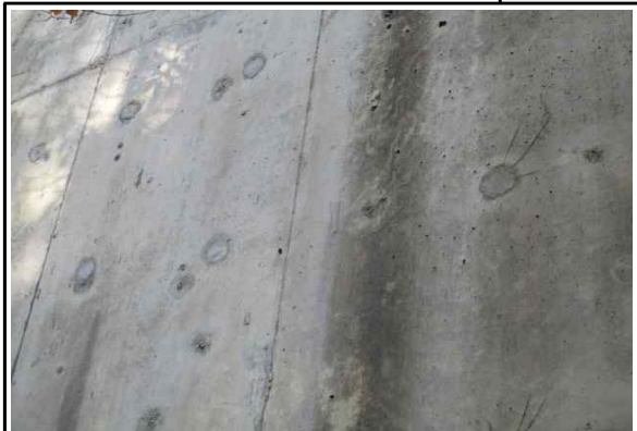
교대 균열(cw:0.3mm미만) (25년 하반기 정기안전점검)
