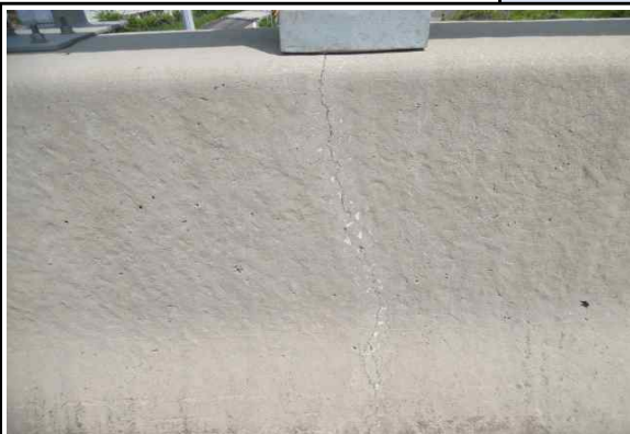
연석 균열(cw:0.3mm미만) (25년 상반기 정기안전점검)
