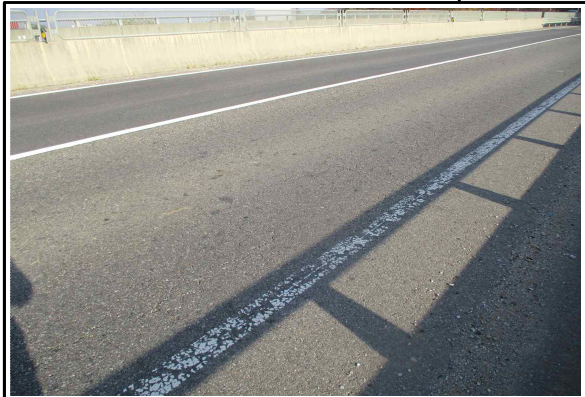
교면포장 아스콘 망상균열 (25년 하반기 정기안전점검)
