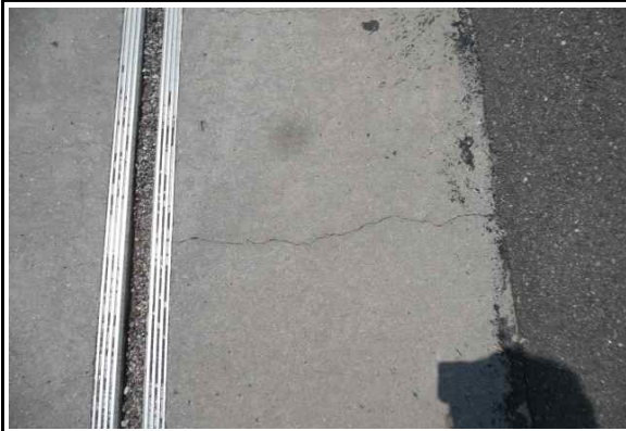
신축이음 후타재 균열(cw:0.3mm미만) (25년 상반기 정기안전점검)
