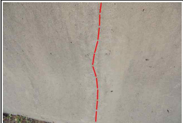
방호벽 균열(cw:0.3mm미만) (25년 하반기 정기안전점검)
