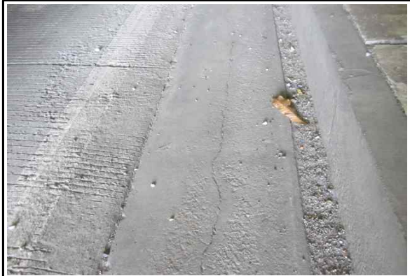
Sta. 011(Span 4) 포장부-균열 (25년 하반기 정기안전점검)
