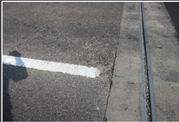
교면포장 포장 파손 (25년 하반기 정기안전점검)
