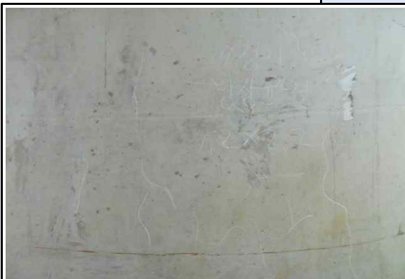
교각 망상균열(cw:0.3mm미만) (25년 상반기 정기안전점검)
