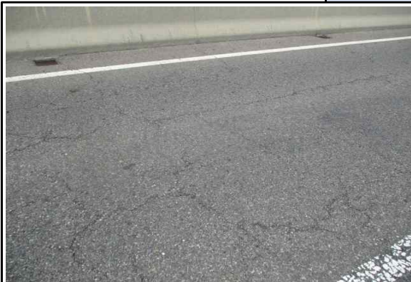
교면포장 포장 망상균열 (25년 상반기 정기안전점검)
