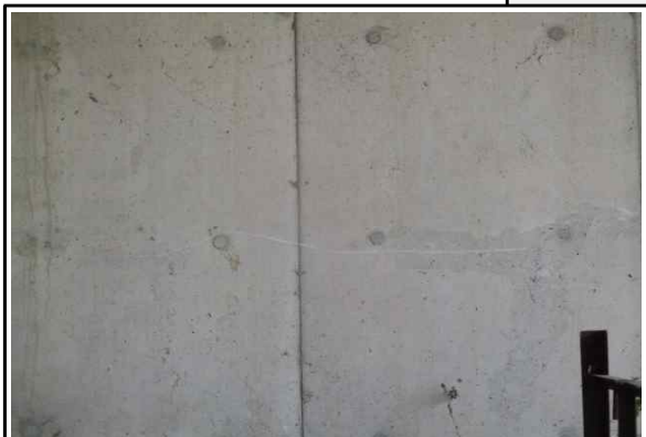
교대 균열(cw:0.3mm미만) (25년 하반기 정기안전점검)
