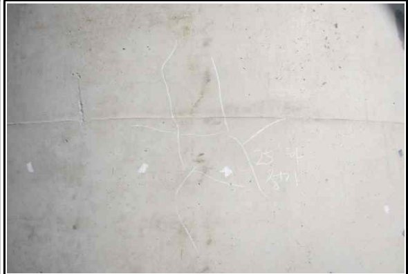
P1 기둥-망상균열(cw:0.3mm미만) (25년 하반기 정기안전점검)
