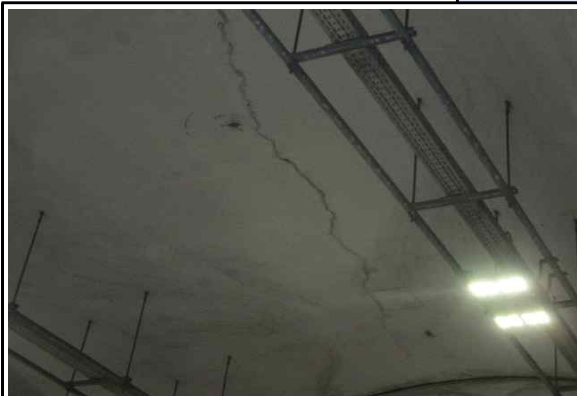
Sta. 074(Span 11) 천단부-균열(cw:0.3mm이상) (25년 상반기 정기안전점검)
