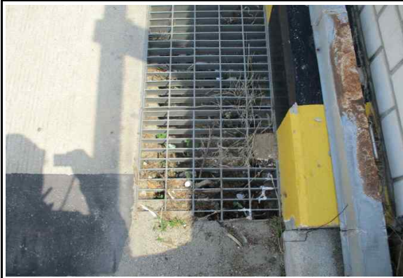
배수로 토사퇴적 (25년 상반기 정기안전점검)
