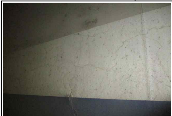
Sta. 175(Span 22) 좌측벽체-망상균열(cw:0.3mm미만) (25년 하반기 정기안전점검)
