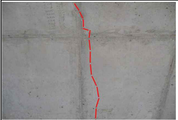
교대 균열(cw:0.3mm미만) (25년 하반기 정기안전점검)
