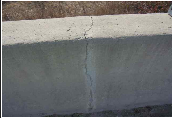
방호벽 균열(cw:0.3mm이상) (25년 하반기 정기안전점검)
