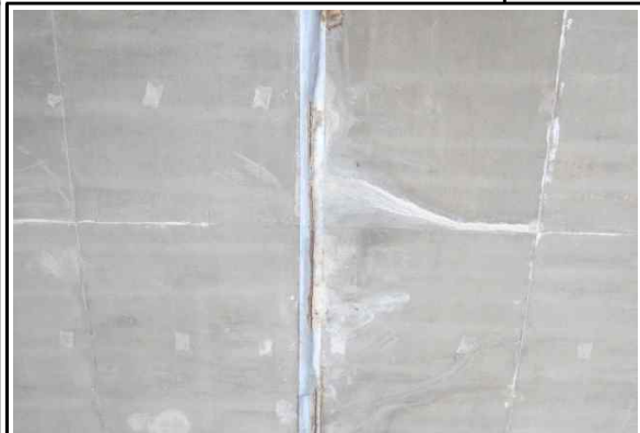
바닥판하면 실런트 누수 (25년 하반기 정기안전점검)
