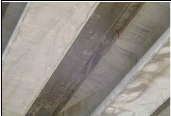
S2 바닥판하면-완충재 탈락 (25년 하반기 정기안전점검)
