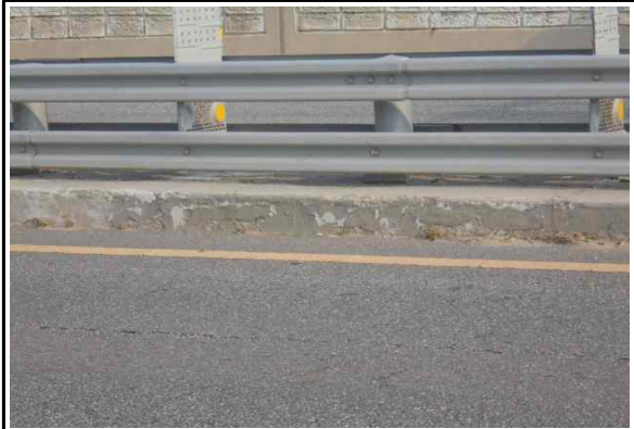
Sta. 100(강화) 연석-중앙분리대 보수재 박리 (25년 하반기 정기안전점검)
