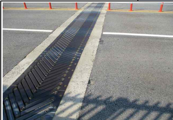
S9(서울) 교면포장-파손 (25년 상반기 정기안전점검)
