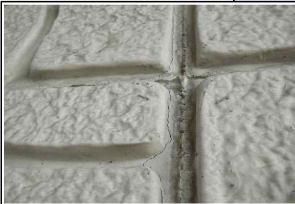
교대 균열(cw:0.3mm미만) (25년 상반기 정기안전점검)
