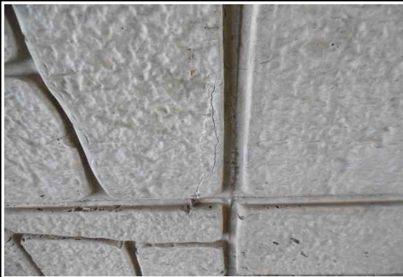
교대 균열(cw:0.3mm미만) (25년 상반기 정기안전점검)
