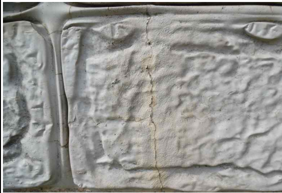
U-Type 옹벽-균열(cw:0.3mm미만) (25년 상반기 정기안전점검)
