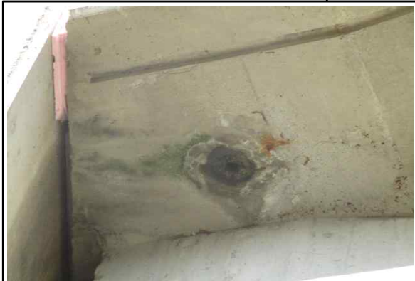
바닥판하면 백태, 유공관 길이부족 (25년 하반기 정기안전점검)
