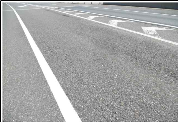
교면포장 포장 마모 (25년 상반기 정기안전점검)
