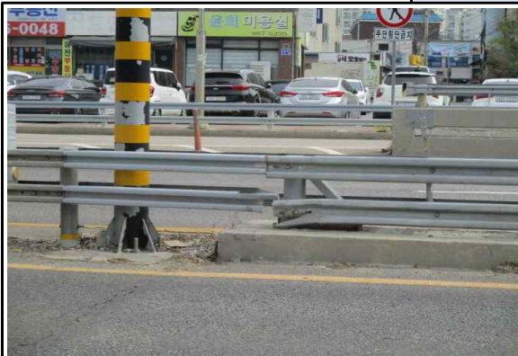
Sta. 000(서울) 난간-중앙분리대 파손 (25년 상반기 정기안전점검)
