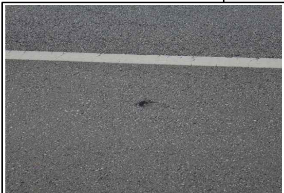
S5(강화) 교면포장-포트홀 (25년 하반기 정기안전점검)
