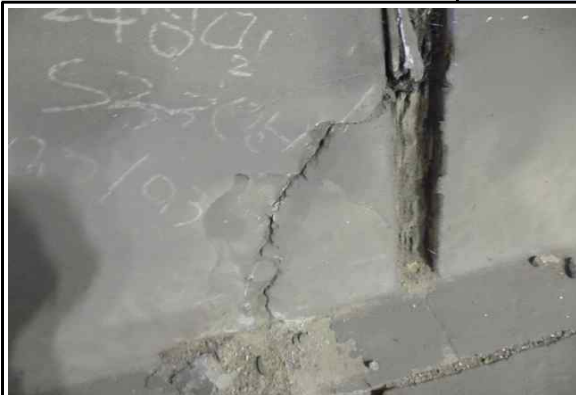
Span23 벽체-균열(cw:0.3mm이상) (25년 상반기 정기안전점검)
