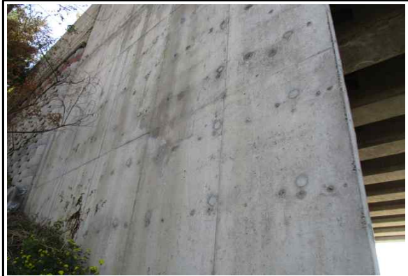
교대 망상균열(cw:0.3mm미만) (25년 하반기 정기안전점검)
