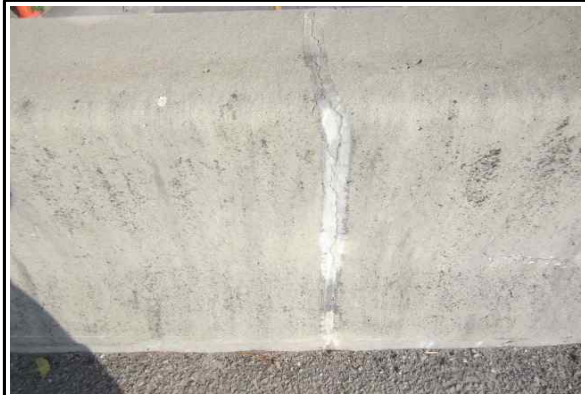
방호벽 균열(cw:0.3mm미만) (25년 하반기 정기안전점검)
