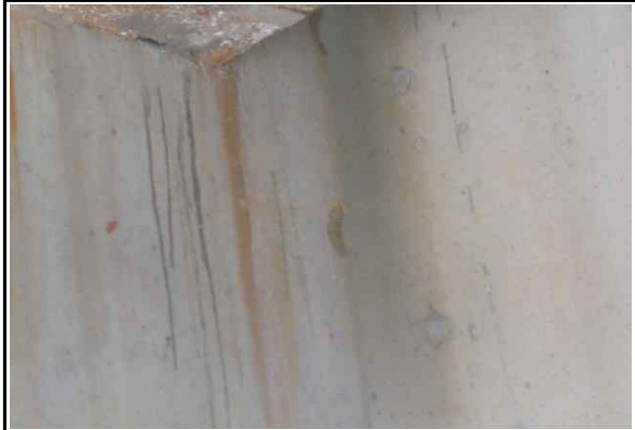
S1-G5 거더-파손 (25년 하반기 정기안전점검)
