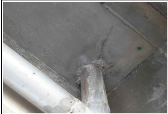
바닥판하면 균열부 백태(cw:0.3mm미만) (25년 하반기 정기안전점검)
