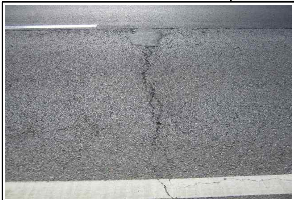
교면포장 포장균열 (25년 하반기 정기안전점검)
