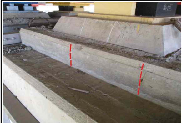
받침장치 받침콘크리트 균열(cw:0.3mm미만) (25년 하반기 정기안전점검)
