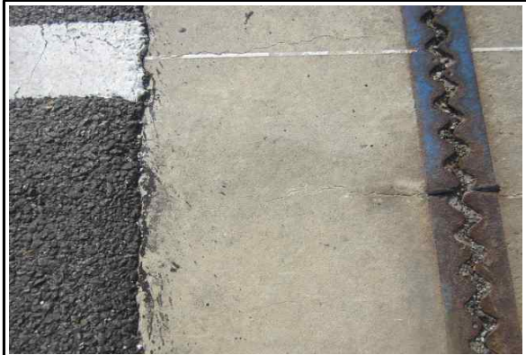
신축이음 후타재 균열(cw:0.3mm미만) (25년 하반기 정기안전점검)
