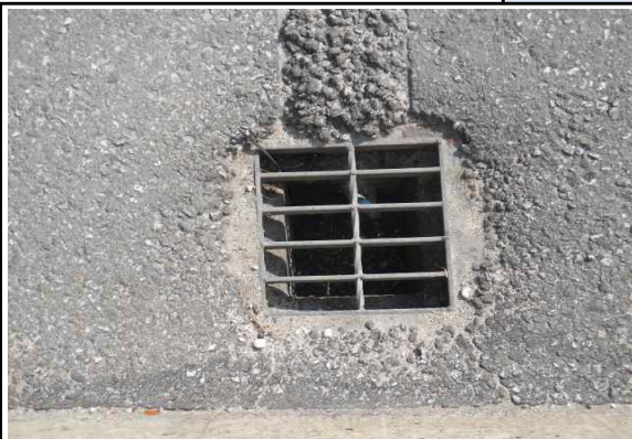
S1(강화) 배수시설-배수구 막힘 (25년 상반기 정기안전점검)
