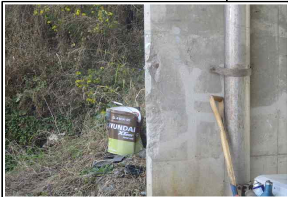
교대 파손 (25년 하반기 정기안전점검)
