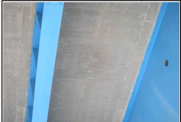
S2(C88~C89) 바닥판-균열(cw:0.3mm미만) (25년 하반기 정기안전점검)
