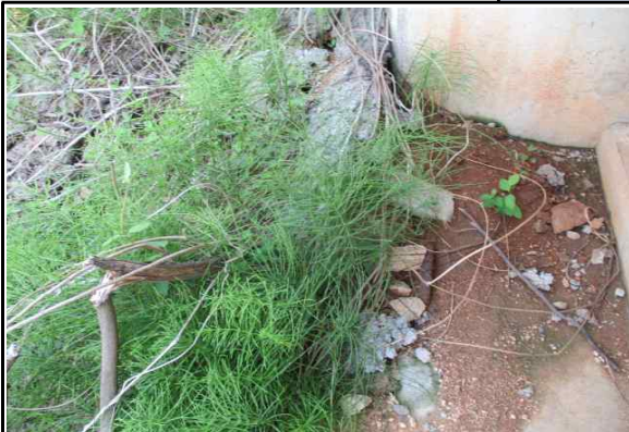
A2 교량받침면-토사퇴적 및 폐콘크리트 적치 (25년 상반기 정기안전점검)
