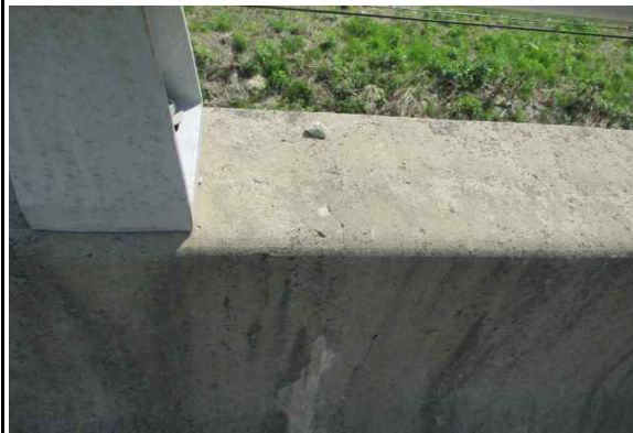
방호벽 균열(cw:0.3mm미만) (25년 상반기 정기안전점검)
