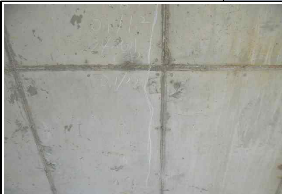
교대 균열(cw:0.3mm미만) (25년 상반기 정기안전점검)
