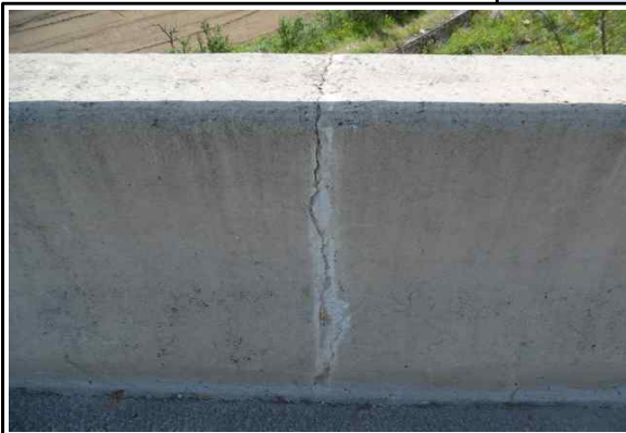
방호벽 균열부 백태(cw:0.3mm이상) (25년 상반기 정기안전점검)
