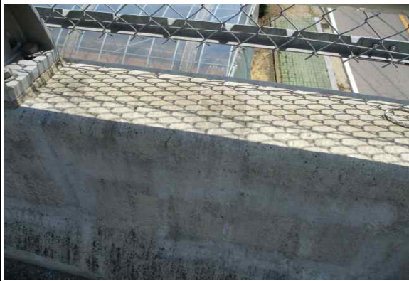
방호벽 균열(cw:0.3mm미만) (25년 상반기 정기안전점검)
