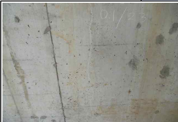
교대 균열(cw:0.3mm미만) (25년 상반기 정기안전점검)
