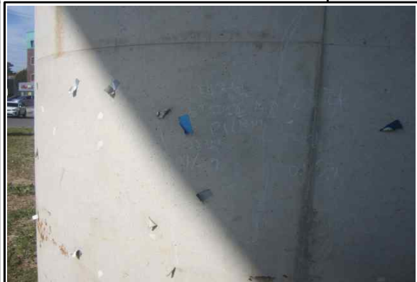
P1 기둥-균열(cw:0.3mm미만) (25년 하반기 정기안전점검)
