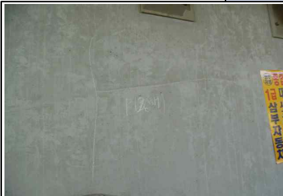
P12 교각-균열(cw:0.3mm미만) (25년 상반기 정기안전점검)
