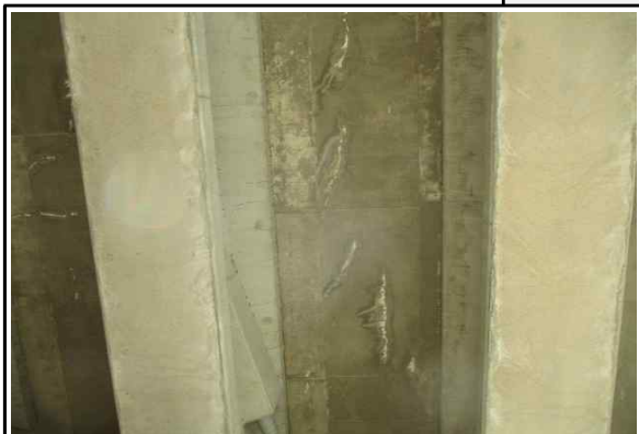
바닥판하면 균열부 백태(cw:0.3mm미만) (25년 하반기 정기안전점검)
