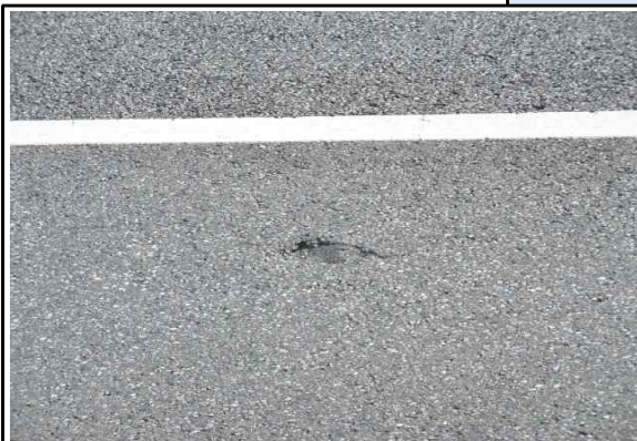
S5(강화) 교면포장-포트홀 (25년 상반기 정기안전점검)
