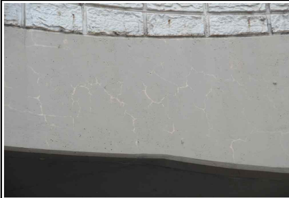
입·출구부-망상균열(cw:0.3mm미만) (25년 상반기 정기안전점검)
