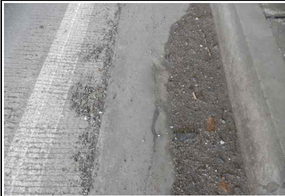
Sta. 011(Span 4) 포장부-균열 (25년 상반기 정기안전점검)
