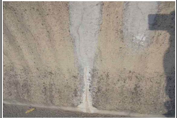
방호벽 균열부 백태(cw:0.3mm미만) (25년 하반기 정기안전점검)
