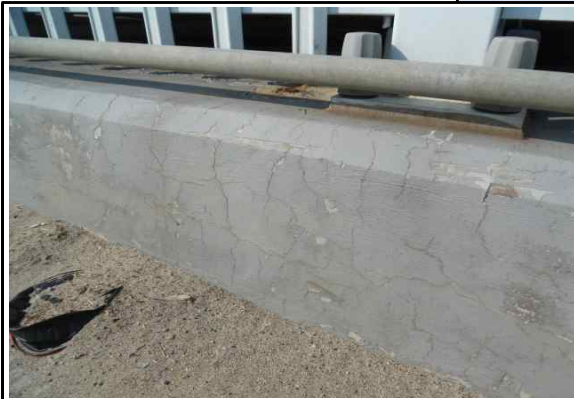
S3(강화) 연석 보수부-망상균열 (25년 상반기 정기안전점검)
