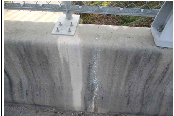
방호벽 균열(cw:0.3mm미만) (25년 하반기 정기안전점검)
