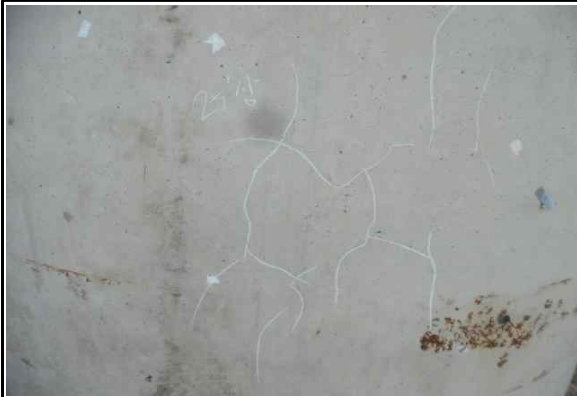
P1 기둥-망상균열(cw:0.3mm미만) (25년 상반기 정기안전점검)
