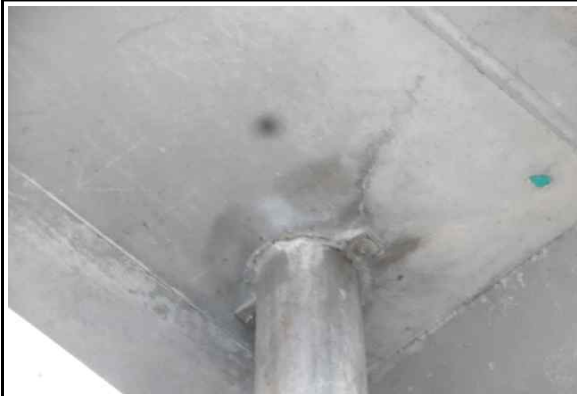
바닥판하면 균열부 백태(cw:0.3mm미만) (25년 상반기 정기안전점검)
