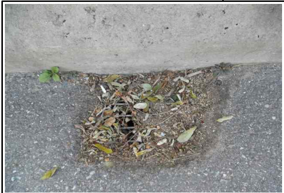
배수시설 배수구 막힘 (25년 하반기 정기안전점검)
