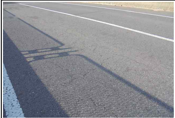
교면포장 포장 망상균열 (25년 하반기 정기안전점검)
