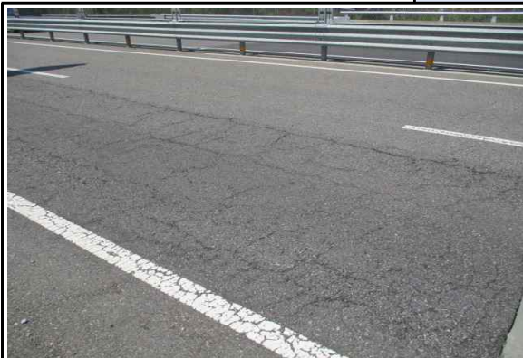
교면포장 접속부 망상균열 (25년 상반기 정기안전점검)
