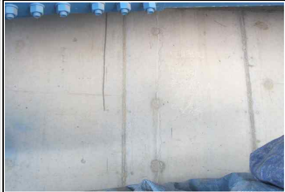
A2 흉벽-균열(cw:0.3mm미만) (25년 하반기 정기안전점검)
