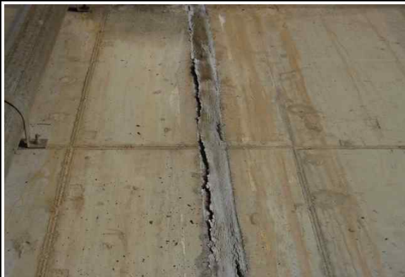
교대 실링재 파손 (25년 상반기 정기안전점검)
