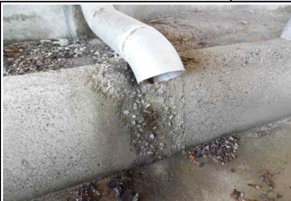
배수시설 배수로 박리 (25년 상반기 정기안전점검)
