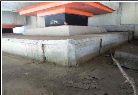
받침장치 받침콘크리트 잡철근 노출 (25년 상반기 정기안전점검)
