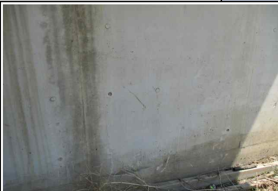
교대 균열(cw:0.3mm미만) (25년 상반기 정기안전점검)
