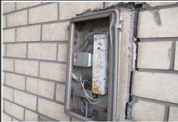
Sta. 150(강화) BOX-소화전 표시등 파손 (25년 상반기 정기안전점검)
