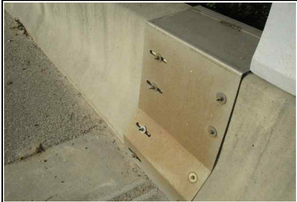
A1 신축이음-차수판 볼트 상태양호 (25년 하반기 정기안전점검)
