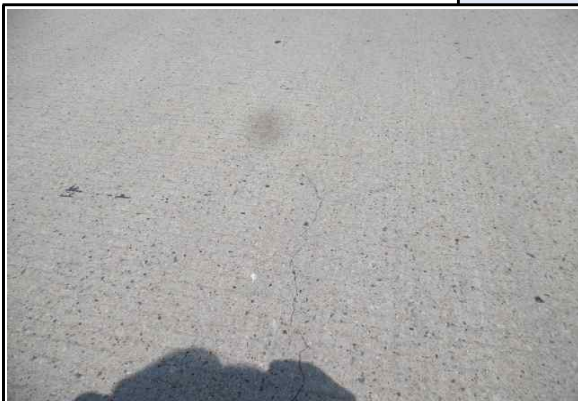
S1 교면포장-포장균열 (25년 상반기 정기안전점검)
