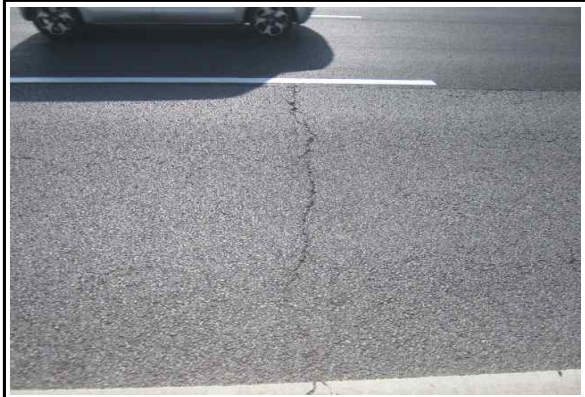
교면포장 포장균열 (25년 하반기 정기안전점검)
