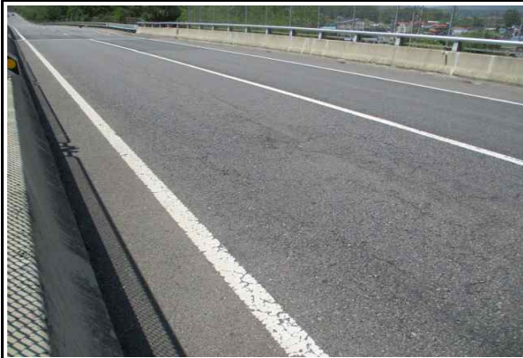
교면포장 포장 망상균열 (25년 상반기 정기안전점검)
