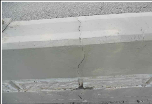
U-Type 옹벽-균열(cw:0.3mm미만) (25년 상반기 정기안전점검)
