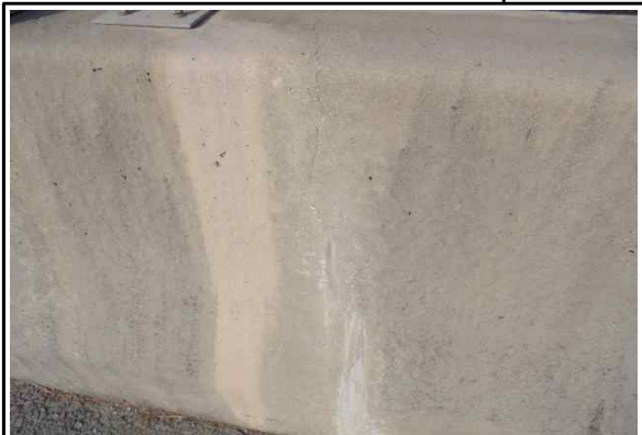
방호벽 균열부 백태(cw:0.3mm미만) (25년 하반기 정기안전점검)
