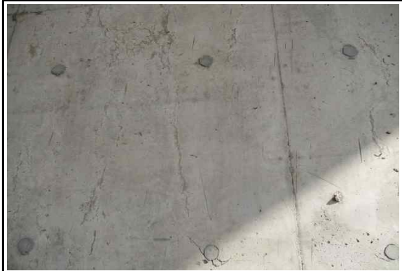
교대 균열(cw:0.3mm미만) (25년 하반기 정기안전점검)
