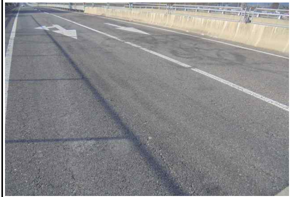
교면포장 포장 망상균열 (25년 하반기 정기안전점검)
