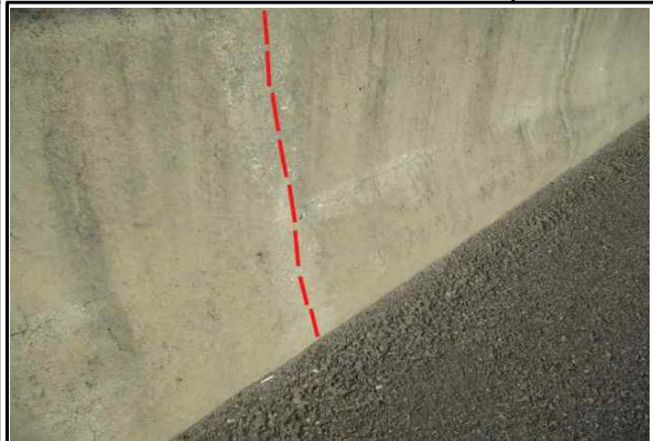
S4 방호울타리-균열(cw:0.3mm미만) (25년 하반기 정기안전점검)
