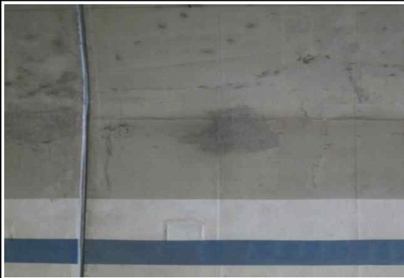
Span 23 벽체-균열(cw:0.3mm미만) (25년 하반기 정기안전점검)
