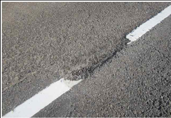
교면포장 포장 파손 (25년 하반기 정기안전점검)
