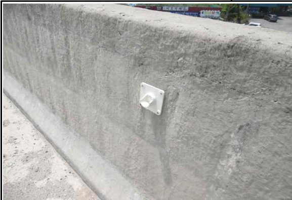
S1 방호울타리-텔리네이트 파손 (25년 상반기 정기안전점검)
