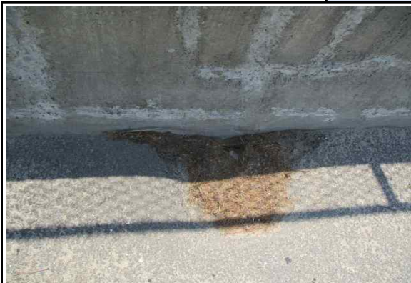
배수시설 배수구 막힘 (25년 상반기 정기안전점검)
