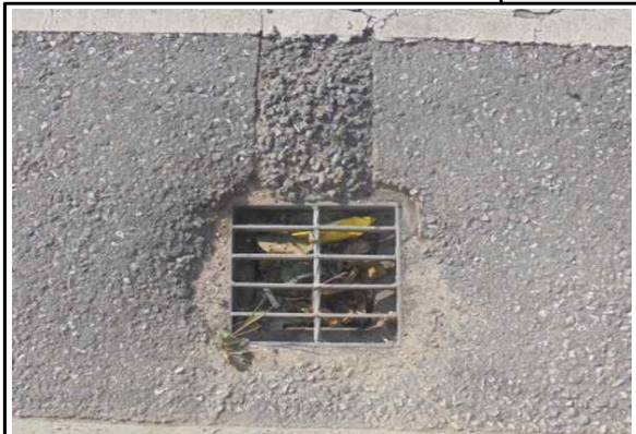
S1(강화) 배수시설-배수구 막힘 (25년 하반기 정기안전점검)
