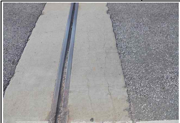
P9(강화) 신축이음-후타재 망상균열 (25년 하반기 정기안전점검)
