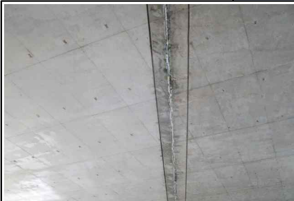
바닥판하면 실링재 열화 (25년 상반기 정기안전점검)
