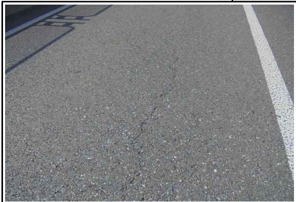
교면포장 아스콘 균열 (25년 하반기 정기안전점검)
