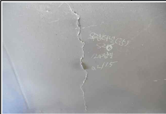
Span26 벽체-균열(cw:0.3mm미만) (25년 상반기 정기안전점검)
