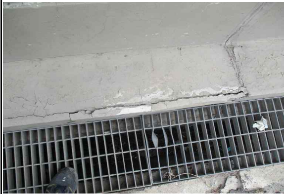
배수시설-그레이팅 변형 (25년 상반기 정기안전점검)
