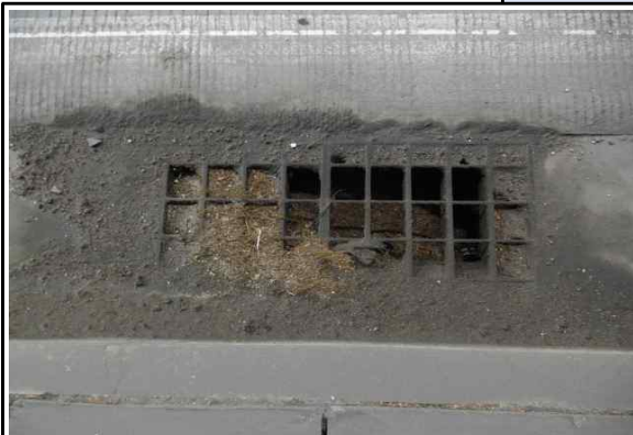
Span11 배수시설-배수구 막힘 (25년 상반기 정기안전점검)
