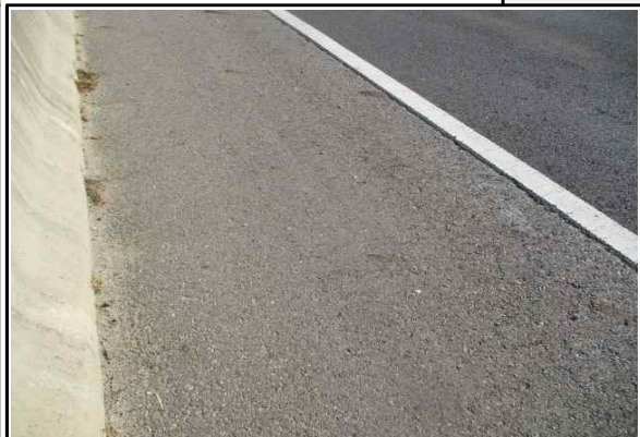
S3 교면포장-아스콘 망상균열 (25년 하반기 정기안전점검)
