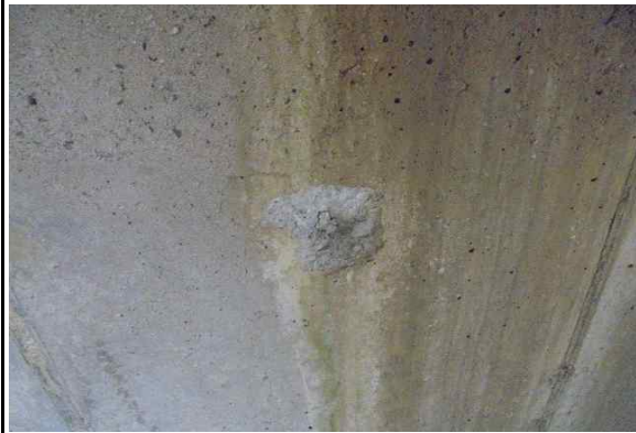
교대 파손 (25년 하반기 정기안전점검)
