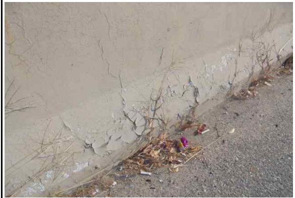
U-Type 옹벽 시점부-탄산화방지재 박리 (25년 하반기 정기안전점검)
