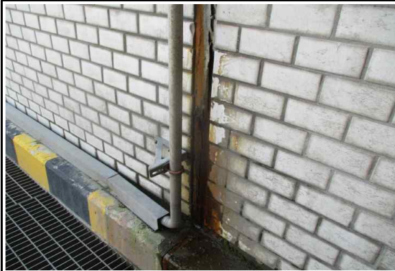
U-Type구간 실린트 파손, 누수 (25년 상반기 정기안전점검)
