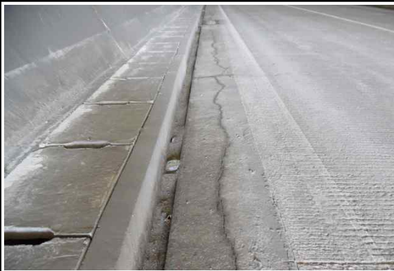
Sta. 011(Span 4) 포장부-균열 (25년 상반기 정기안전점검)
