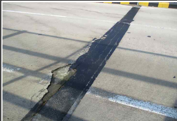
포장부 아스콘 파손 (25년 상반기 정기안전점검)
