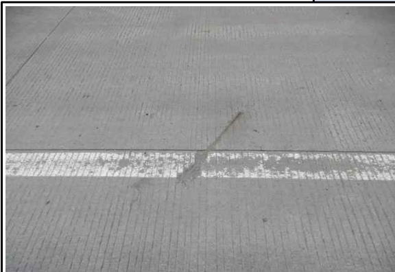
Sta. 097(Span 13) 포장부-잡철근 노출 (25년 상반기 정기안전점검)
