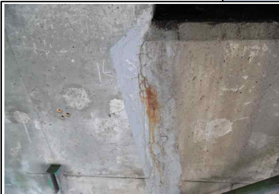
A2 교대-균열(cw:0.3mm미만) (25년 상반기 정기안전점검)
