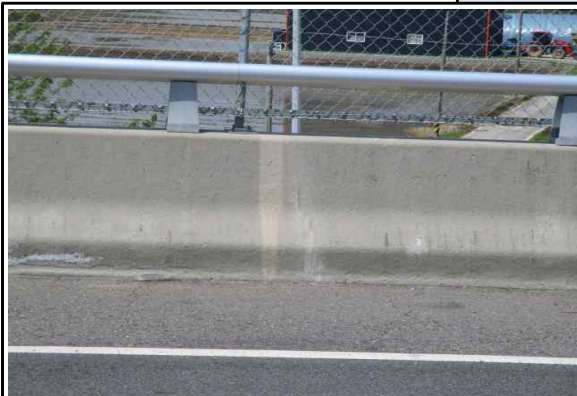
방호벽 균열부 백태(cw:0.3mm미만) (25년 상반기 정기안전점검)
