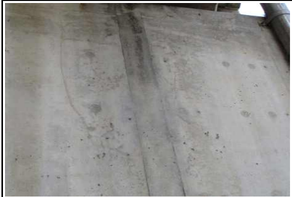
교대 망상균열(cw:0.3mm미만) (25년 하반기 정기안전점검)
