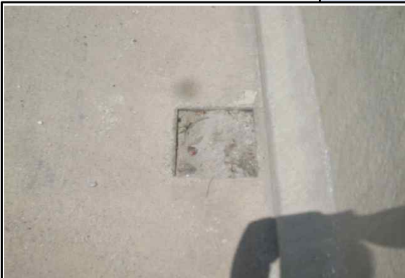
S2 배수시설-배수구 막힘 (25년 상반기 정기안전점검)
