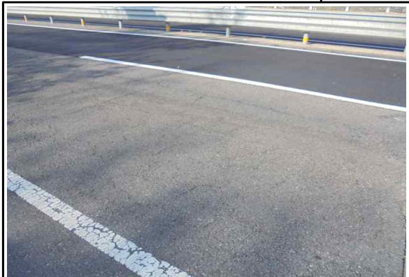
교면포장 접속부 망상균열 (25년 하반기 정기안전점검)
