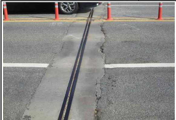
P9(서울) 신축이음-후타재 파손 (25년 하반기 정기안전점검)
