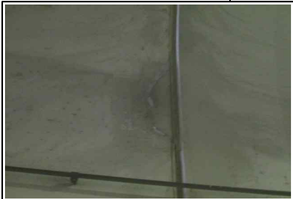
Span21 벽체-박리 (25년 하반기 정기안전점검)
