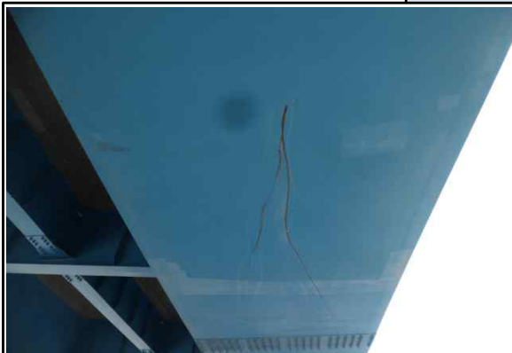
S3-G1 거더외부-균열 (25년 상반기 정기안전점검)
