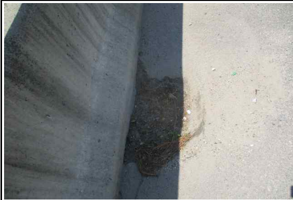
배수시설 배수구 막힘 (25년 상반기 정기안전점검)
