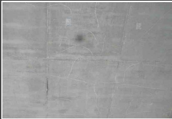
바닥판하면 망상균열(cw:0.3mm미만) (25년 상반기 정기안전점검)
