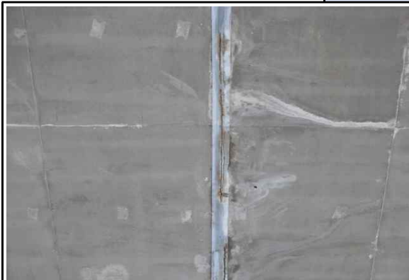
바닥판하면 실런트 누수 (25년 상반기 정기안전점검)
