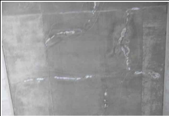
바닥판하면 균열부 백태(cw:0.3mm미만) (25년 상반기 정기안전점검)
