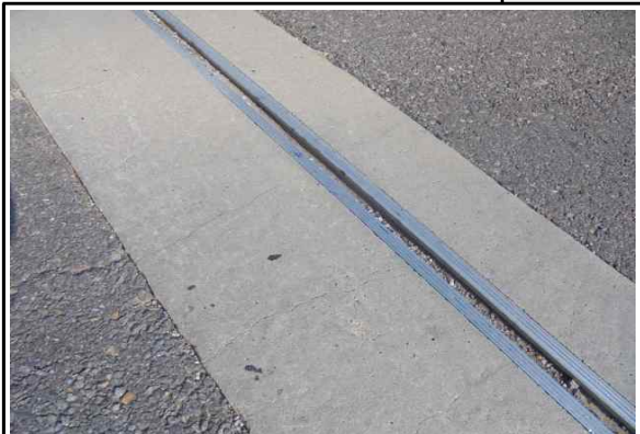
신축이음 후타재 균열(cw:0.3mm미만) (25년 하반기 정기안전점검)
