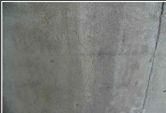
교대 균열(cw:0.3mm미만) (25년 상반기 정기안전점검)
