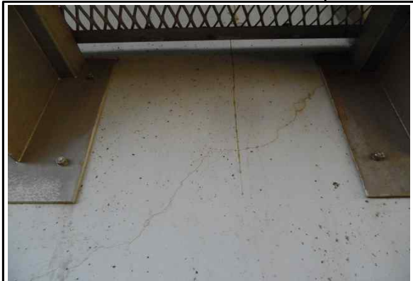
P12 교각-균열(cw:0.3mm미만) (25년 하반기 정기안전점검)
