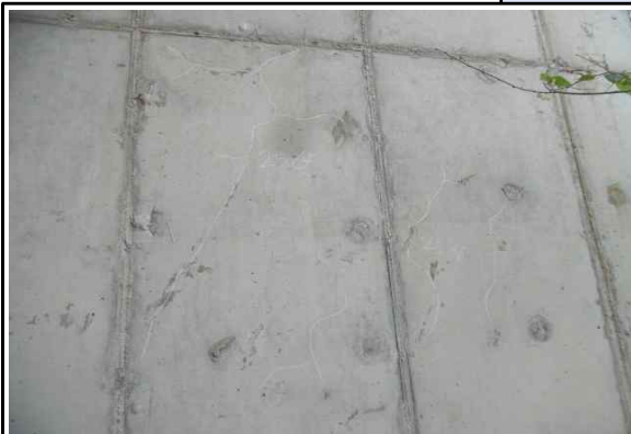
교대 망상균열(cw:0.3mm미만) (25년 상반기 정기안전점검)
