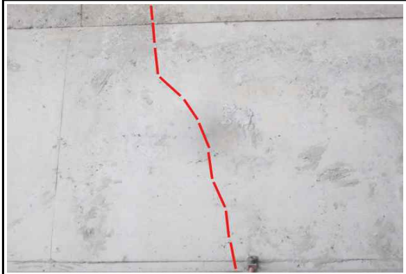
BOX구간 상부슬래브 하면 균열(cw:0.3mm미만) (25년 하반기 정기안전점검)
