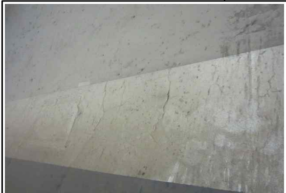
Sta. 052(Span 8) 우측벽체-망상균열 (25년 하반기 정기안전점검)
