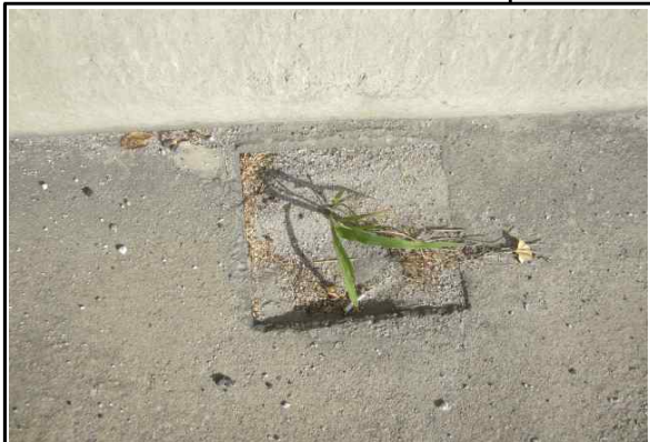
S2 배수시설-배수구 막힘 (25년 하반기 정기안전점검)
