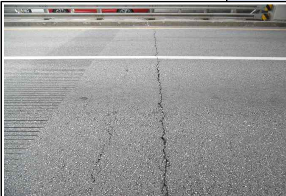
포장부-균열 (25년 상반기 정기안전점검)
