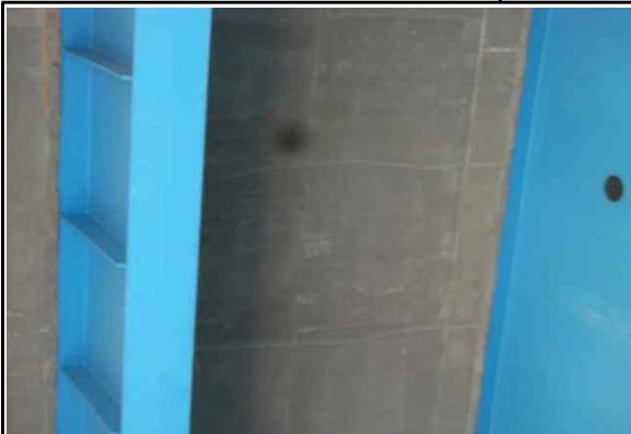
S2(C88~C89) 바닥판-균열(cw:0.3mm미만) (25년 상반기 정기안전점검)
