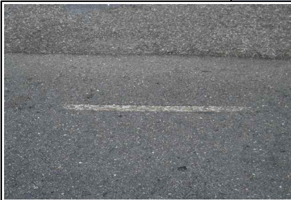
교면포장 포장 패임 (25년 상반기 정기안전점검)
