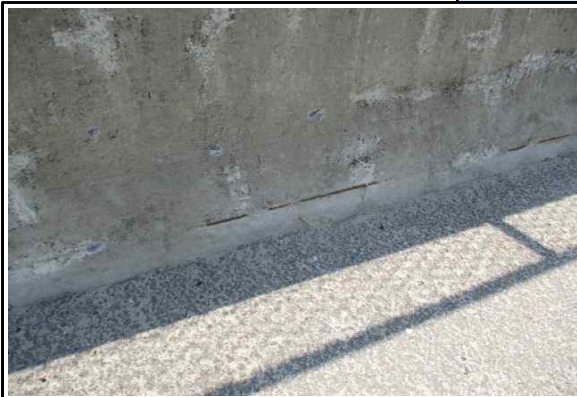
방호벽 철근노출 (25년 상반기 정기안전점검)
