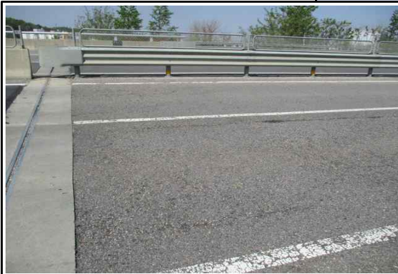
교면포장 접속부 아스콘 망상균열 (25년 상반기 정기안전점검)
