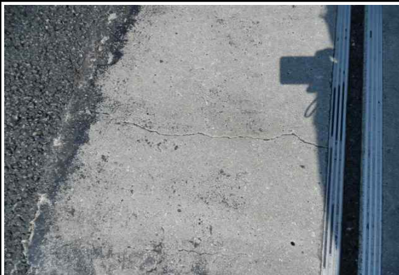
신축이음 후타재 균열(cw:0.3mm미만) (25년 상반기 정기안전점검)
