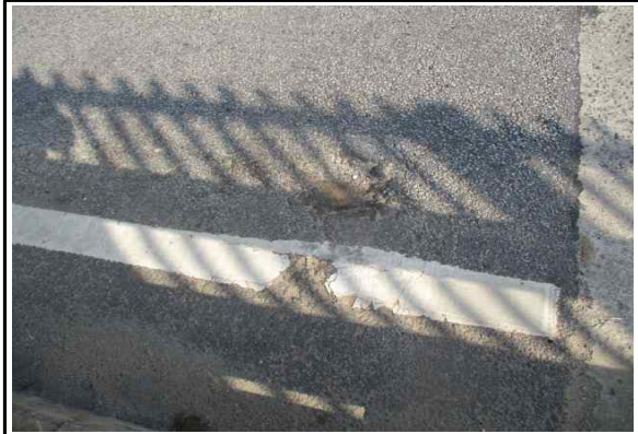
S12(서울) 교면포장-파손, 소성변형 (25년 하반기 정기안전점검)
