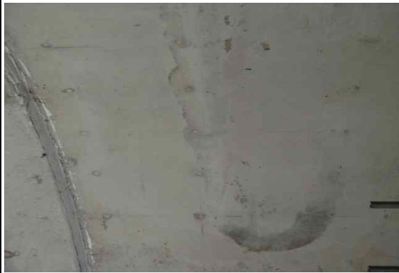
시점(Span 2) 갭문-균열(cw:0.3mm미만) (25년 상반기 정기안전점검)
