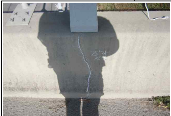
연석 균열(cw:0.3mm미만) (25년 하반기 정기안전점검)
