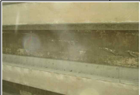
바닥판하면 균열부 백태(cw:0.3mm미만) (25년 하반기 정기안전점검)
