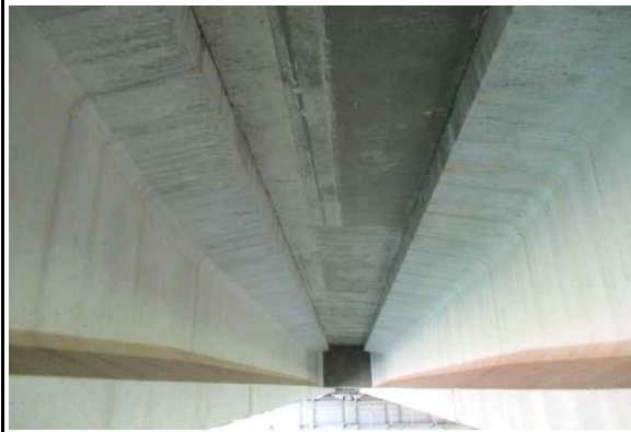
바닥판하면 망상균열(cw:0.3mm미만) (25년 상반기 정기안전점검)
