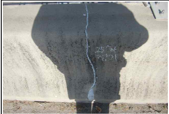
연석 균열(cw:0.3mm미만) (25년 하반기 정기안전점검)
