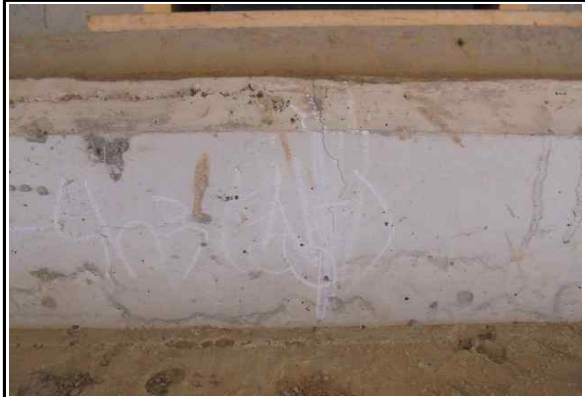
A2-Sh3 받침콘크리트 균열(cw:0.3mm미만) (25년 하반기 정기안전점검)
