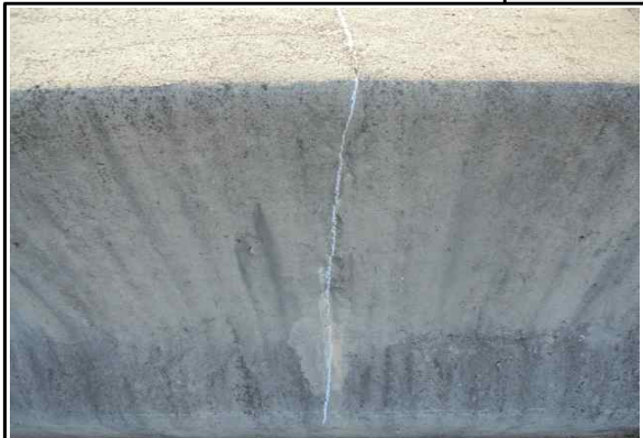
S2 방호벽-균열(cw:0.3mm미만) (25년 하반기 정기안전점검)
