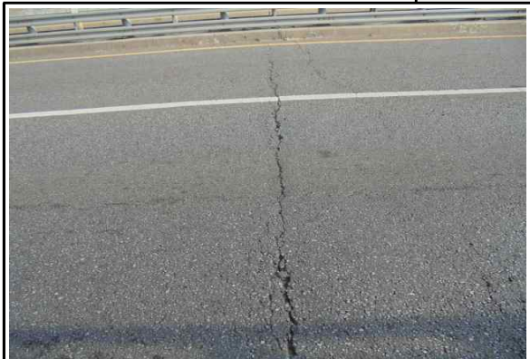
포장부-균열 (25년 하반기 정기안전점검)
