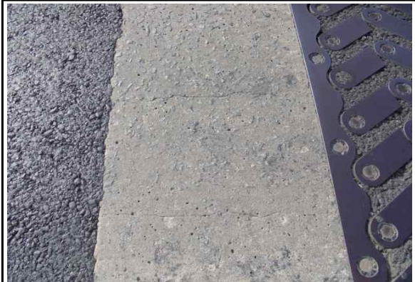
A2(강화) 신축이음-후타재 균열 (25년 하반기 정기안전점검)
