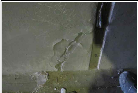
Span23 벽체-균열(cw:0.3mm이상) (25년 하반기 정기안전점검)
