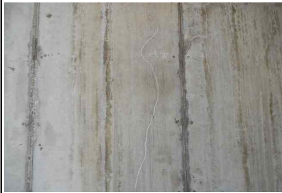
교대 균열(cw:0.3mm미만) (25년 상반기 정기안전점검)
