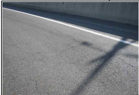
종점 접속부 교면포장-포장망상균열 (25년 하반기 정기안전점검)
