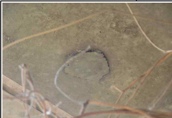
바닥판하면 들뜸 (25년 상반기 정기안전점검)
