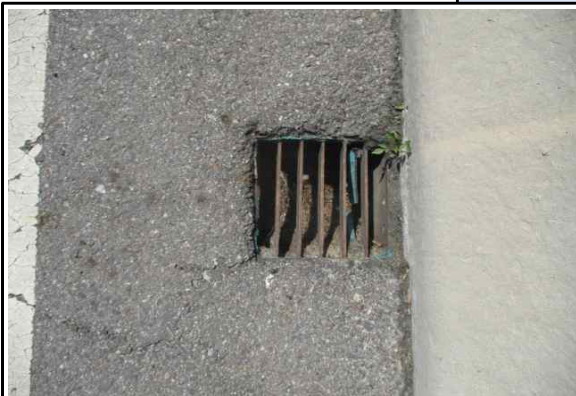
배수시설 배수구 막힘 (25년 상반기 정기안전점검)
