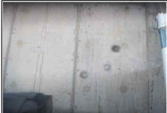
A2 흉벽-균열(cw:0.3mm이상) (25년 하반기 정기안전점검)
