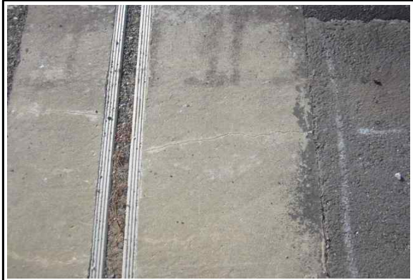
신축이음 후타재 균열(cw:0.3mm미만) (25년 하반기 정기안전점검)
