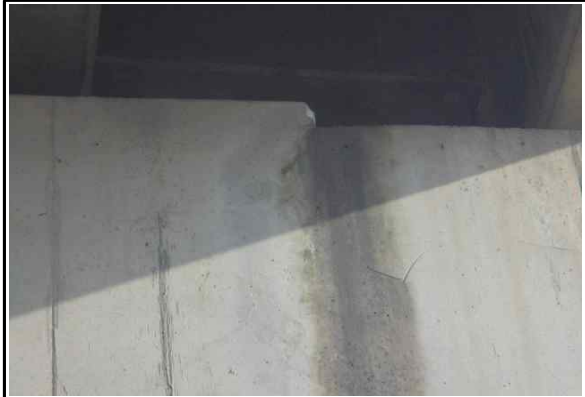
P2(G4~G5) 코핑(전면)-균열(cw:0.3mm미만) (25년 하반기 정기안전점검)
