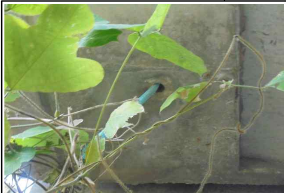
바닥판하면 백태, 유공관 마감미흡 (25년 하반기 정기안전점검)
