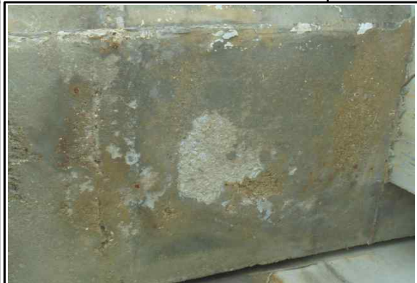
S1 바닥판하면-표면박리 (25년 하반기 정기안전점검)
