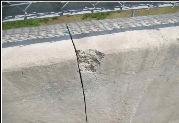
S1 방호울타리-파손 (25년 상반기 정기안전점검)
