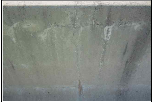
S3 방호울타리-균열(cw:0.3mm미만) (25년 하반기 정기안전점검)
