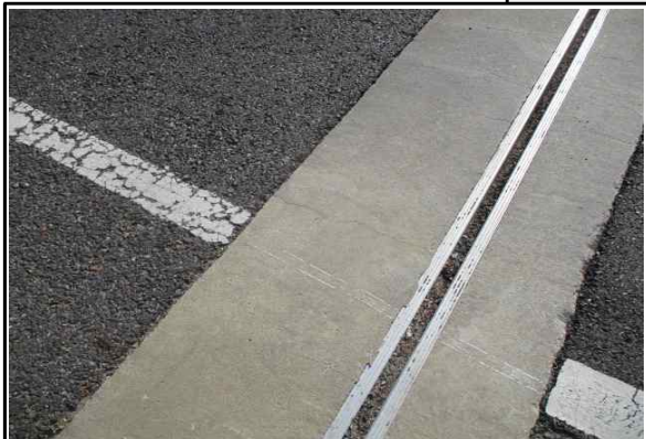
A2 신축이음-후타재 균열(cw:0.3mm미만) (25년 하반기 정기안전점검)
