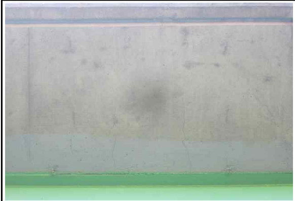
S12 캔틸레버-균열(cw:0.3mm미만) (25년 하반기 정기안전점검)
