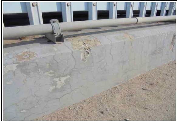
S3(강화) 연석 보수부-망상균열, 보수재 박리 (25년 하반기 정기안전점검)
