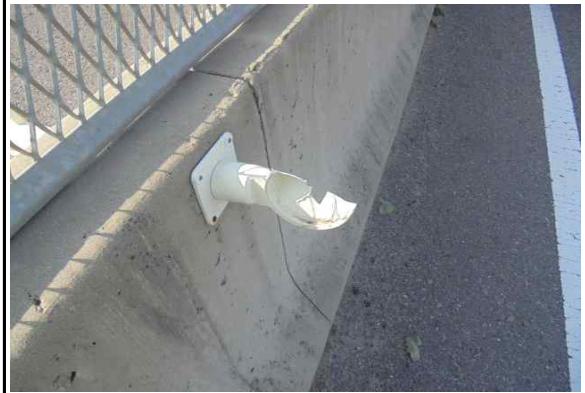
방호벽 텔리네이트 파손 (25년 하반기 정기안전점검)
