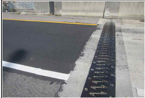
시점 접속부 교면포장-보수완료 (25년 하반기 정기안전점검)
