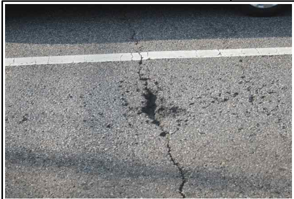
포장부-파손 (25년 하반기 정기안전점검)
