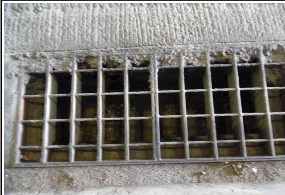
Sta. 025(Span 5) 배수구-토사퇴적 (25년 상반기 정기안전점검)
