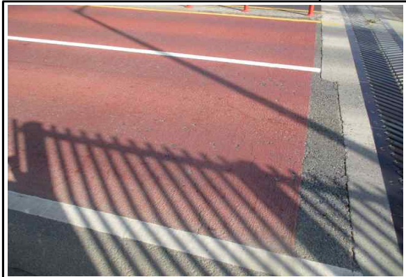
S1(서울) 교면포장-접속부 아스콘 망상균열 (25년 하반기 정기안전점검)
