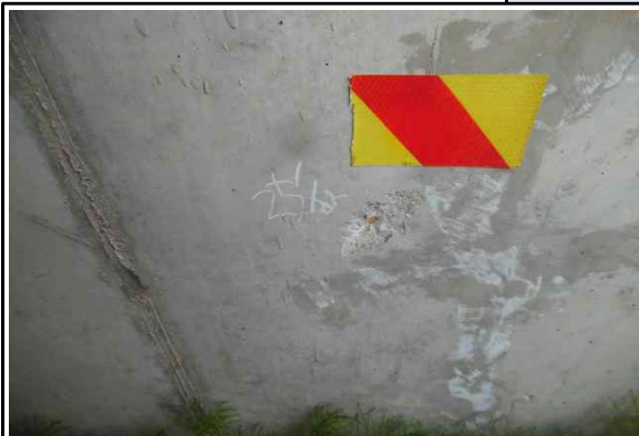
교대 파손 (25년 상반기 정기안전점검)
