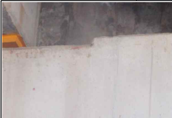
P3(G4~G5) 코핑(후면)-균열(cw:0.3mm미만) (25년 상반기 정기안전점검)
