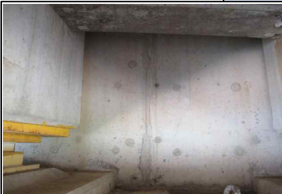
A2 흥벽-균열(cw:0.3mm미만) (25년 상반기 정기안전점검)
