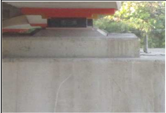
P3-Sh6 받침콘크리트-균열(cw:0.3mm미만) (25년 하반기 정기안전점검)
