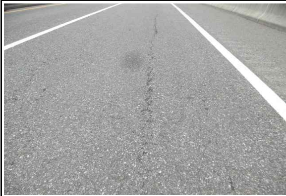
교면포장 포장 균열 (25년 상반기 정기안전점검)
