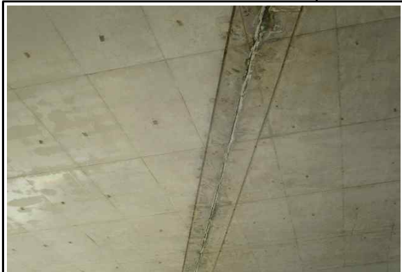
바닥판하면 실링재 열화 (25년 하반기 정기안전점검)
