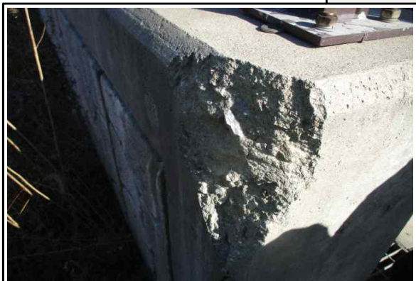
U-Type구간 옹벽 파손 (25년 하반기 정기안전점검)
