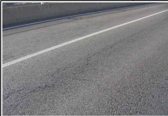
교면포장 포장 균열 (25년 하반기 정기안전점검)
