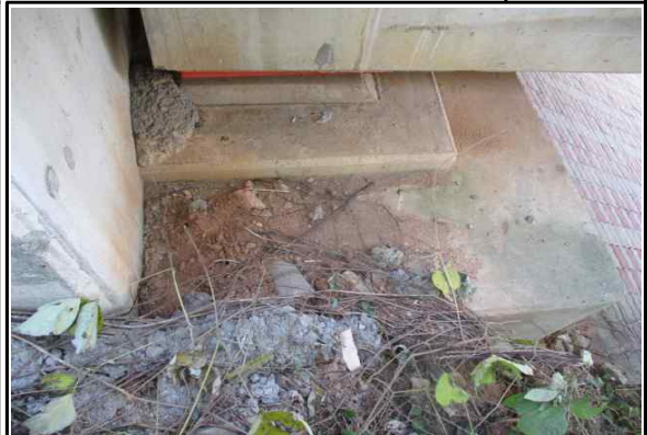
A2 교량받침면-토사퇴적 및 폐콘크리트 적치 (25년 하반기 정기안전점검)
