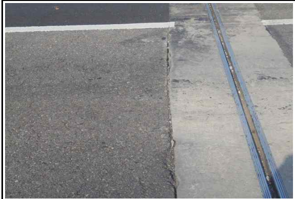
신축이음 후타재 파손 (25년 하반기 정기안전점검)
