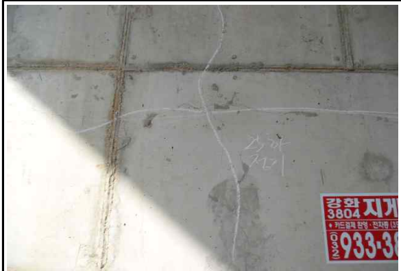
교대 균열(cw:0.3mm미만) (25년 하반기 정기안전점검)
