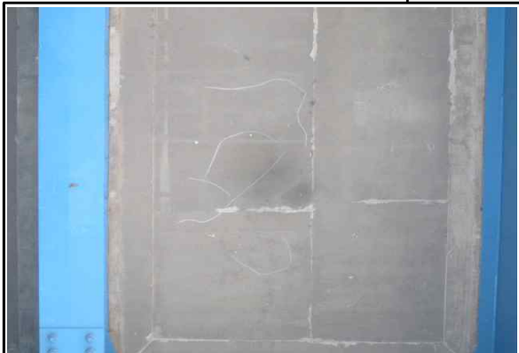
S2 바닥판하면-망상균열(cw:0.3mm미만) (25년 하반기 정기안전점검)
