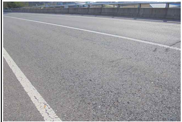
교면포장 포장 마모 (25년 하반기 정기안전점검)
