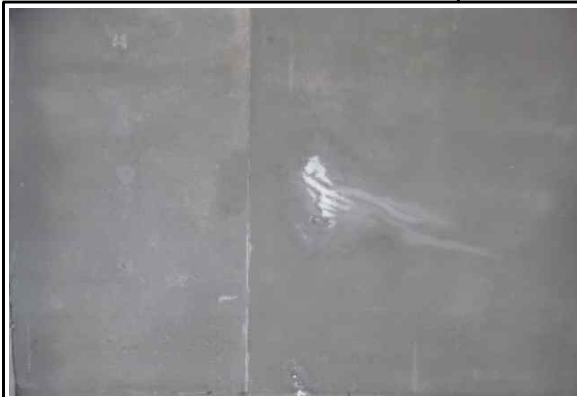
바닥판하면 백태 (25년 상반기 정기안전점검)
