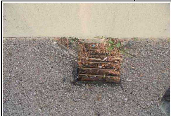
배수시설 배수구 막힘 (25년 하반기 정기안전점검)
