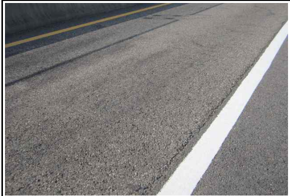
교면포장 포장 열화 (25년 하반기 정기안전점검)
