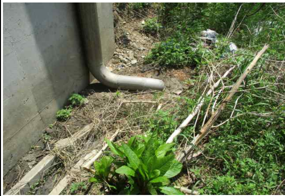
배수시설 배수로 토사퇴적 (25년 상반기 정기안전점검)
