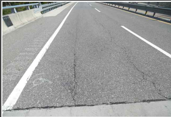
교면포장 접속부 포장 균열 (25년 상반기 정기안전점검)
