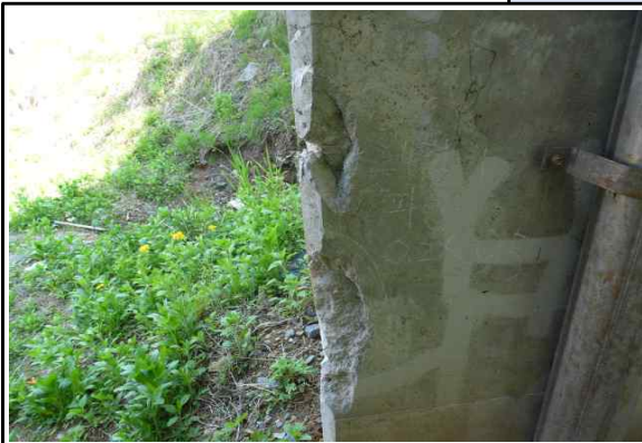
교대 파손 (25년 상반기 정기안전점검)
