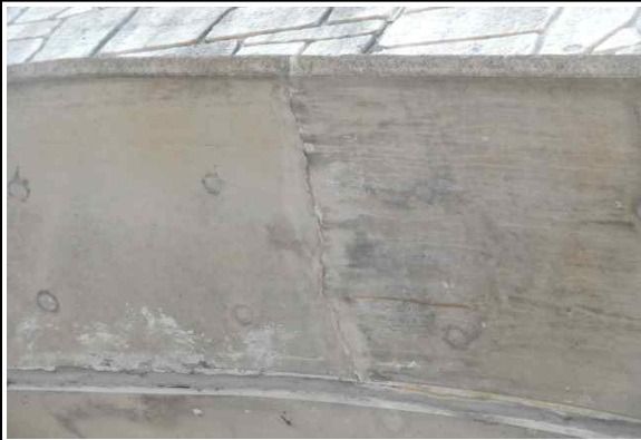
종점 갭문-균열(cw:0.3mm 이상) (25년 상반기 정기안전점검)
