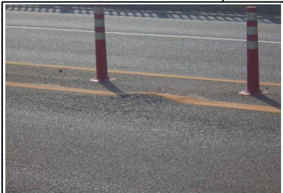
S1(강화) 교면포장-소성변형 (25년 하반기 정기안전점검)
