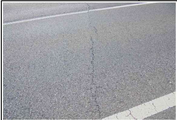
교면포장 접속부 균열 (25년 하반기 정기안전점검)
