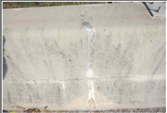
방호벽 균열(cw:0.3mm미만) (25년 하반기 정기안전점검)
