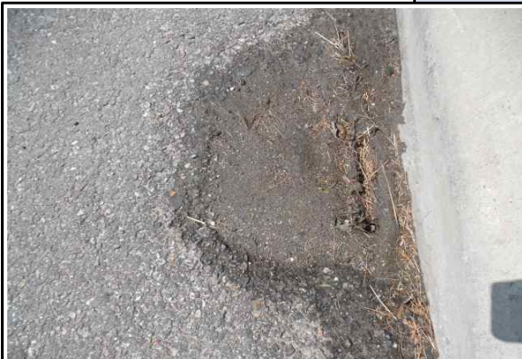
배수시설 배수구 막힘 (25년 상반기 정기안전점검)
