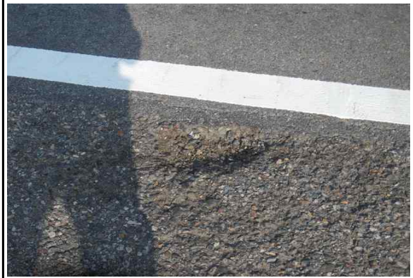
교면포장 포트홀 (25년 하반기 정기안전점검)
