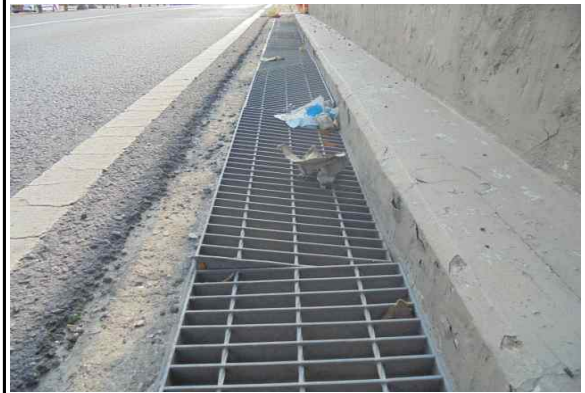
배수시설-그레이팅 변형 (25년 하반기 정기안전점검)
