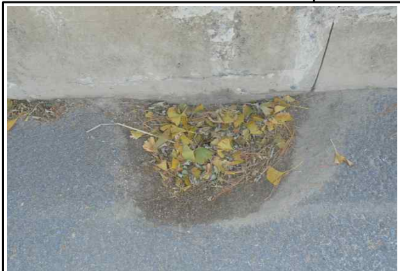
배수시설 배수구 막힘 (25년 하반기 정기안전점검)
