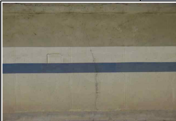
Span12 벽체-균열(cw:0.3mm이상) (25년 상반기 정기안전점검)
