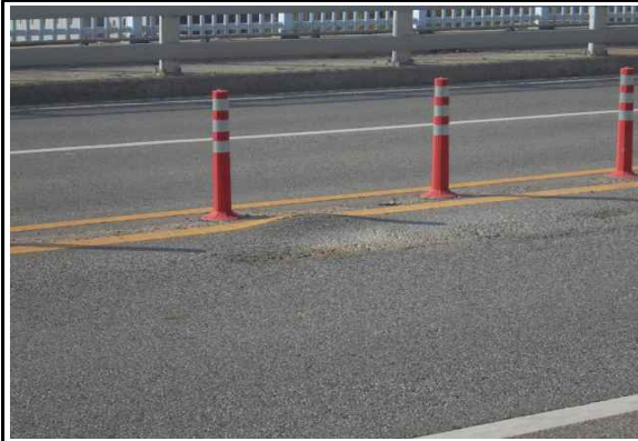
S2(강화) 교면포장-소성변형 (25년 하반기 정기안전점검)
