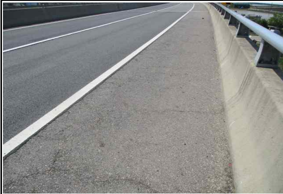
S4 교면포장-아스콘 균열 (25년 상반기 정기안전점검)
