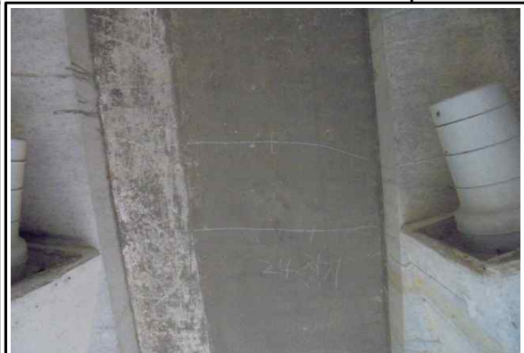
바닥판하면 균열(cw:0.3mm미만) (25년 하반기 정기안전점검)
