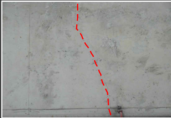
BOX구간 상부슬래브 하면 균열(cw:0.3mm미만) (25년 상반기 정기안전점검)
