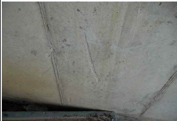
교대 파손 (25년 상반기 정기안전점검)
