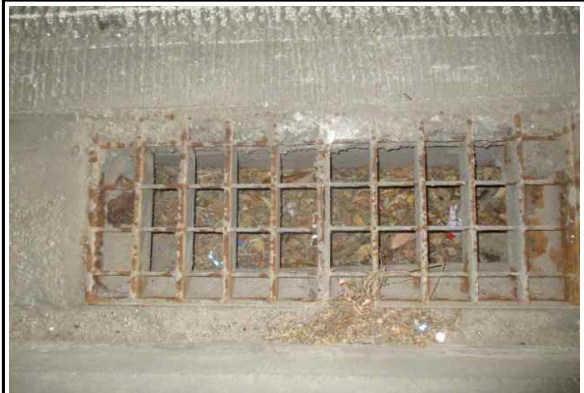
Sta. 025(Span 5) 배수구-토사퇴적 (25년 하반기 정기안전점검)
