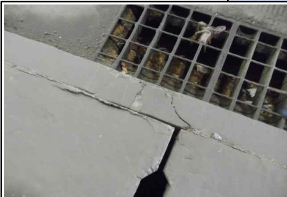
Sta. 175(Span 22) 공동구-파손 (25년 상반기 정기안전점검)
