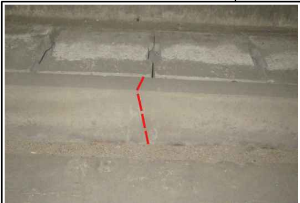
Sta. 112(Span 15) 공동구-균열(cw:0.3mm미만) (25년 하반기 정기안전점검)
