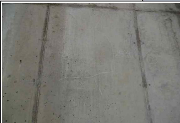
교대 균열(cw:0.3mm미만) (25년 상반기 정기안전점검)
