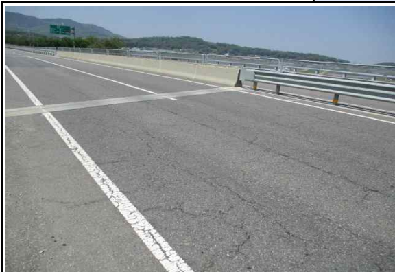
교면포장 접속부 망상균열 (25년 상반기 정기안전점검)
