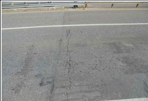
포장부-파손 (25년 하반기 정기안전점검)
