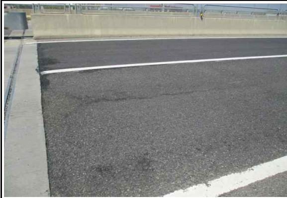
교면포장 아스콘 균열 (25년 상반기 정기안전점검)
