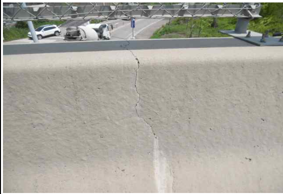
연석 균열(cw:0.3mm이상) (25년 상반기 정기안전점검)
