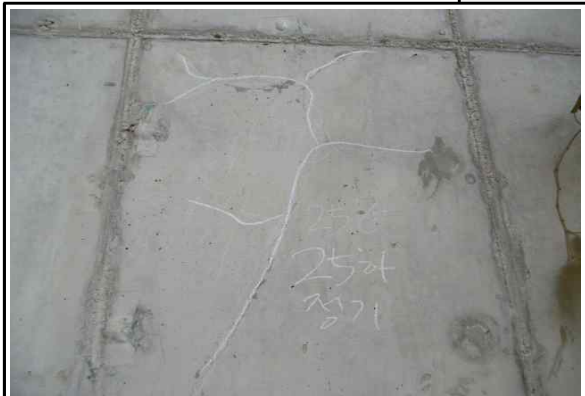
교대 망상균열(cw:0.3mm미만) (25년 하반기 정기안전점검)
