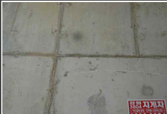
교대 균열(cw:0.3mm미만) (25년 상반기 정기안전점검)
