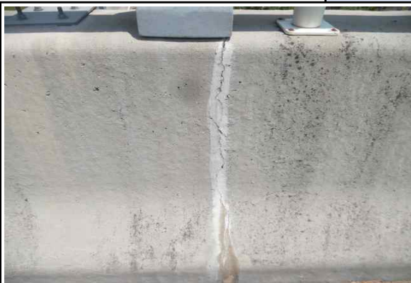
방호벽 균열(cw:0.3mm미만) (25년 상반기 정기안전점검)
