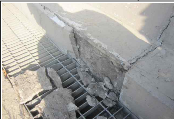
연석-파손 (25년 하반기 정기안전점검)
