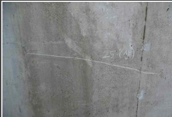
교대 균열(cw:0.3mm미만) (25년 상반기 정기안전점검)
