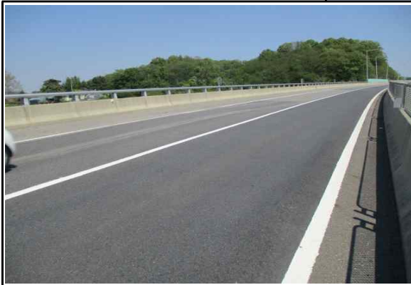
S1 교면포장-아스콘 망상균열(보수완료) (25년 상반기 정기안전점검)
