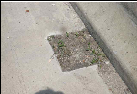
S1 배수시설-배수구 막힘 (25년 상반기 정기안전점검)
