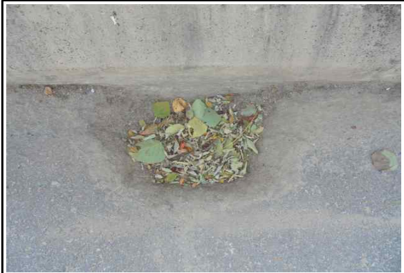
배수시설 배수구 막힘 (25년 하반기 정기안전점검)
