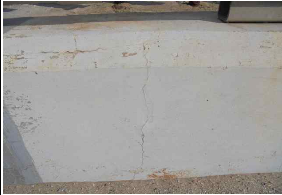
S11(강화) 연석-균열(cw:0.3mm미만) (25년 하반기 정기안전점검)
