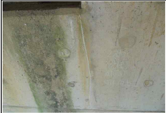
A1 구체-균열(cw:0.3mm미만) (25년 하반기 정기안전점검)
