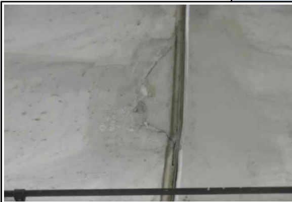
Span21 벽체-박리 (25년 상반기 정기안전점검)
