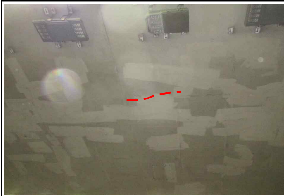
Sta. 013(강화) 슬래브-균열(cw:0.3mm미만) (25년 상반기 정기안전점검)
