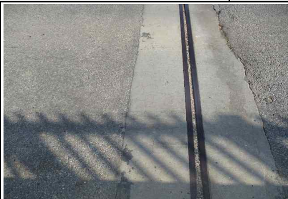
P9(서울) 신축이음-후타재 균열 (25년 하반기 정기안전점검)
