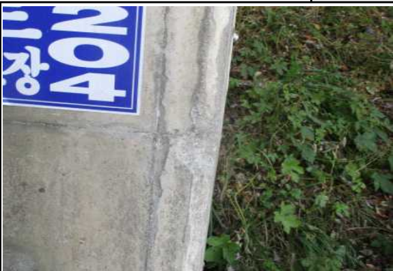
교대 파손 (25년 하반기 정기안전점검)
