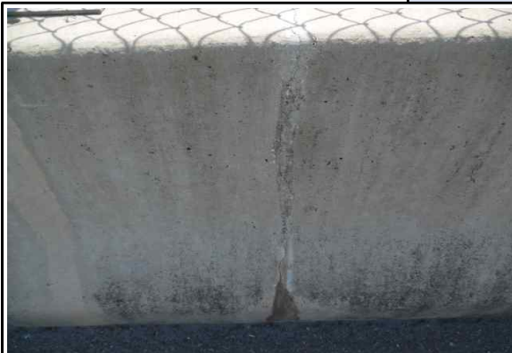
연석 균열(cw:0.3mm미만) (25년 상반기 정기안전점검)
