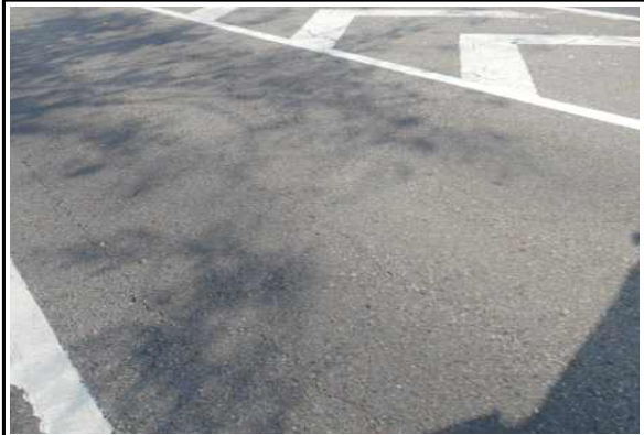
교면포장 포장 망상균열 (25년 하반기 정기안전점검)
