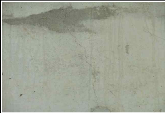
교대 균열(cw:0.3mm미만) (25년 상반기 정기안전점검)
