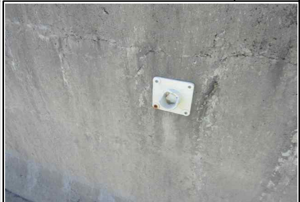
S1 방호울타리-텔리네이트 파손 (25년 하반기 정기안전점검)
