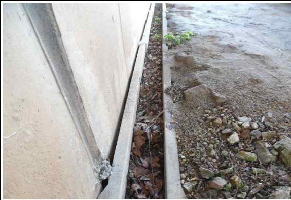
배수시설 배수로 토사퇴적 (25년 상반기 정기안전점검)
