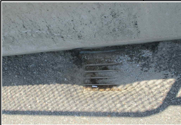
S1 배수시설-배수구 막힘 (25년 상반기 정기안전점검)
