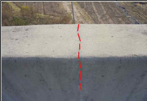
S3 방호벽-균열(cw:0.3mm미만) (25년 하반기 정기안전점검)
