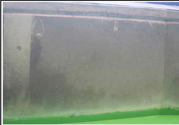
S13 캔틸레버-망상균열(cw:0.3mm미만) (25년 하반기 정기안전점검)
