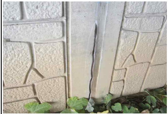
교대 실링재 파손 (25년 하반기 정기안전점검)
