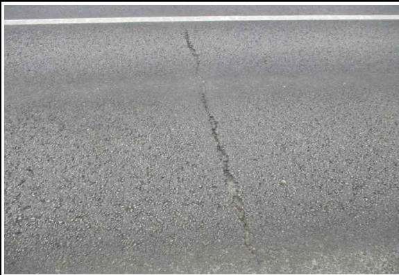
Sta. 015(강화) 시점옹벽-포장 균열 (25년 상반기 정기안전점검)
