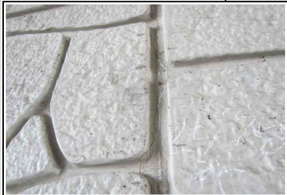
교대 균열(cw:0.3mm미만) (25년 하반기 정기안전점검)
