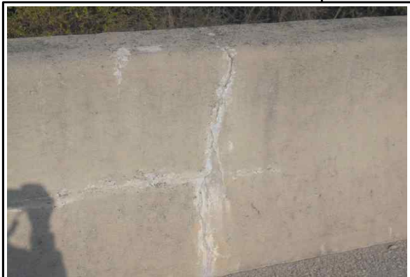
방호벽 균열부 백태(cw:0.3mm이상) (25년 하반기 정기안전점검)
