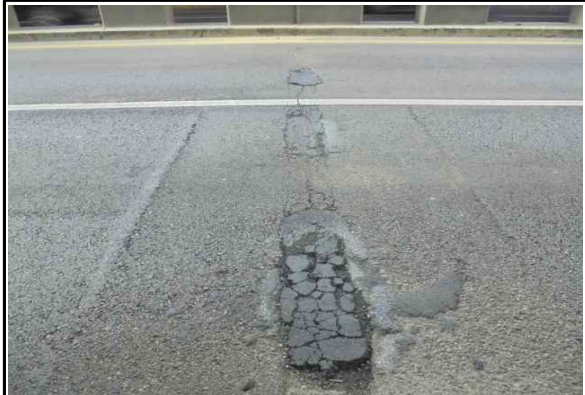
Sta. 060(서울) BOX-포장 파손 (25년 하반기 정기안전점검)
