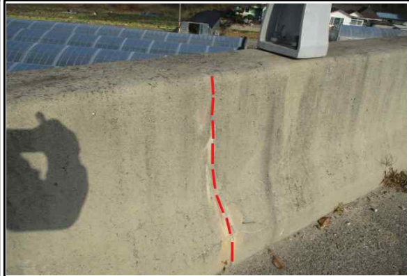
S3 방호울타리-균열(cw:0.3mm미만) (25년 하반기 정기안전점검)
