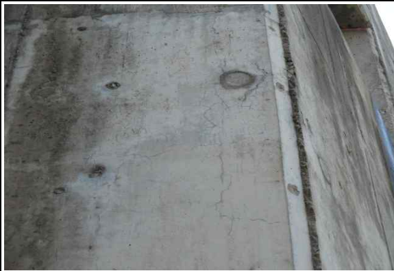
교대 망상균열(cw:0.3mm미만) (25년 상반기 정기안전점검)
