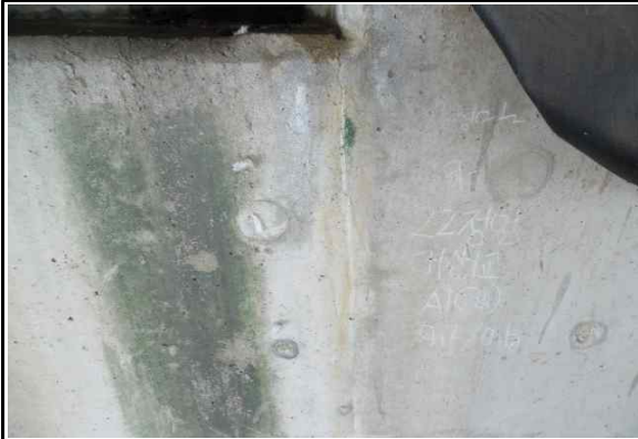
A1 구체-균열(cw:0.3mm미만) (25년 상반기 정기안전점검)
