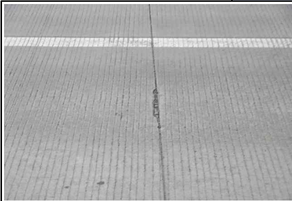
Span12 포장부-파손 (25년 상반기 정기안전점검)
