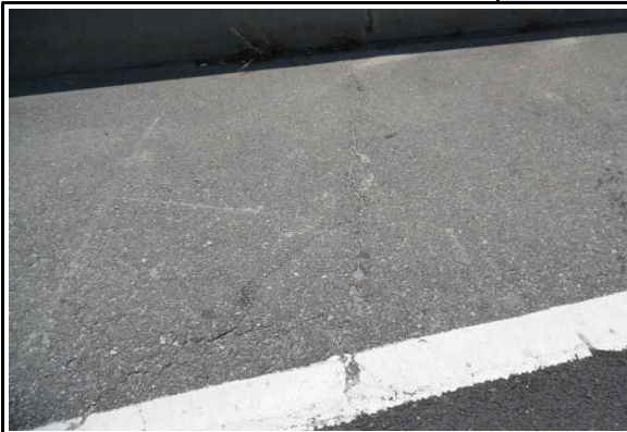
교면포장 접속부 균열 (25년 상반기 정기안전점검)
