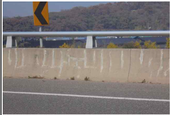
방호벽 보수부 균열(cw:0.3mm 이상) (25년 하반기 정기안전점검)
