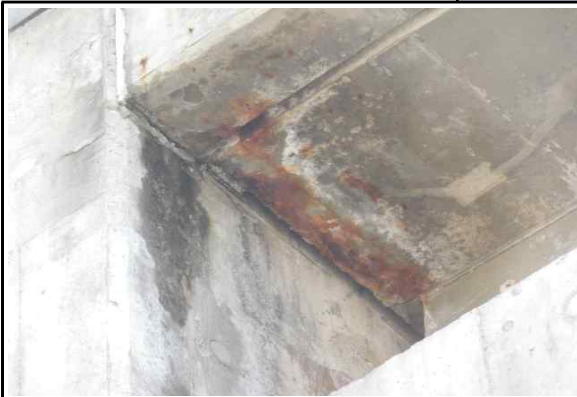
바닥판하면 백태 및 층분리 (25년 상반기 정기안전점검)
