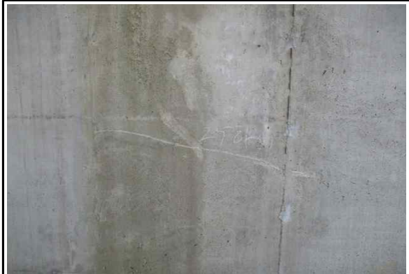
교대 균열(cw:0.3mm미만) (25년 하반기 정기안전점검)
