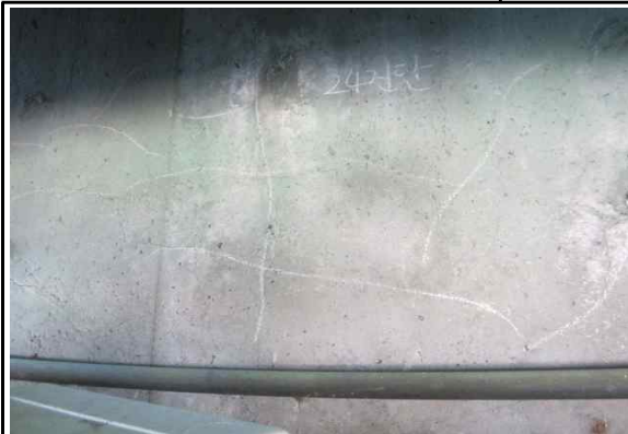
A2 홍벽-망상균열(cw:0.3mm미만) (25년 하반기 정기안전점검)
