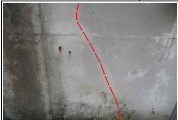
교대 균열(cw:0.3mm미만) (25년 하반기 정기안전점검)
