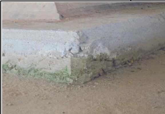
A1-Sh4 받침콘크리트 재료분리 (25년 하반기 정기안전점검)
