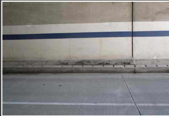
Sta. 011(Span 4) 중앙벽체-백태 및 누수흔적 (25년 상반기 정기안전점검)
