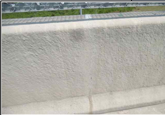
S1 방호울타리-균열부 백태(cw:0.3mm미만) (25년 상반기 정기안전점검)
