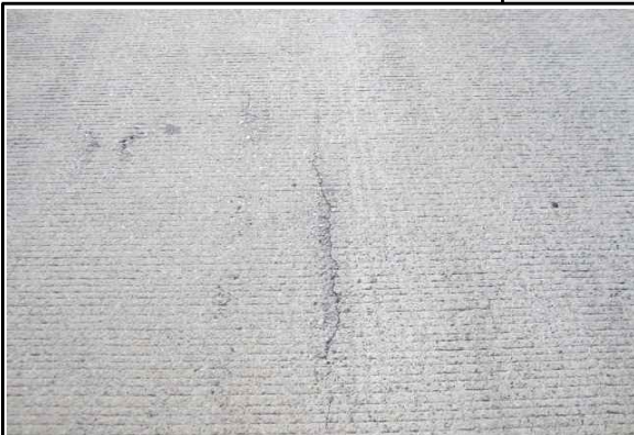
S3 교면포장-포장균열 (25년 하반기 정기안전점검)
