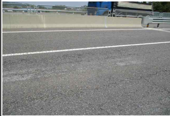
교면포장 포장 마모 (25년 상반기 정기안전점검)
