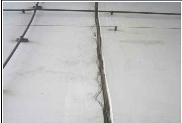
Span 29 벽체-박리 (25년 하반기 정기안전점검)
