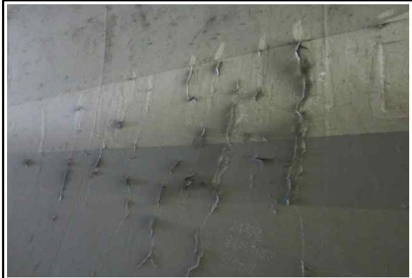
Span22 벽체-망상균열(cw:0.3mm미만) (25년 하반기 정기안전점검)
