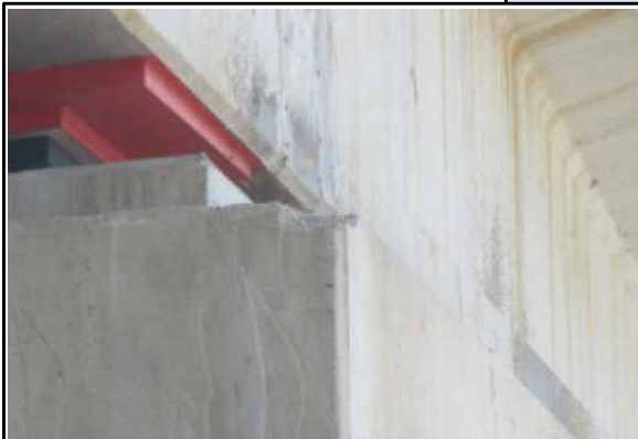
P3 코핑-파손 (25년 상반기 정기안전점검)
