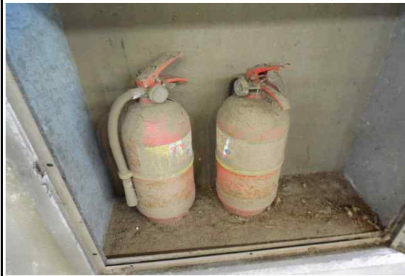
소화시설-점검상태 불량 (25년 상반기 정기안전점검)
