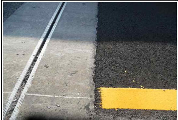
신축이음 접속부 단차 보수완료 (25년 하반기 정기안전점검)
