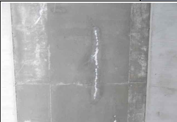
바닥판하면 균열부 백태(cw:0.3mm미만) (25년 상반기 정기안전점검)
