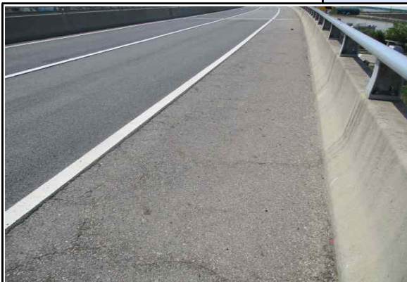
S3 교면포장-아스콘 망상균열 (25년 상반기 정기안전점검)
