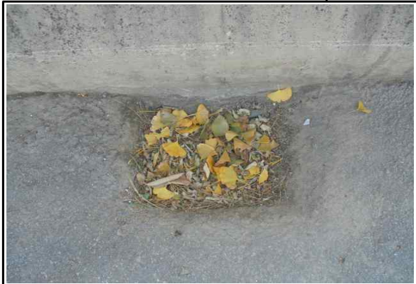
S1 배수시설-배수구 막힘 (25년 하반기 정기안전점검)
