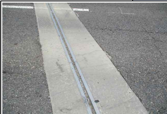
신축이음 후타재 균열(cw:0.3mm미만) (25년 상반기 정기안전점검)
