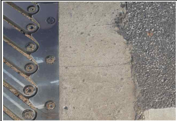
P8(강화) 신축이음-후타재 균열 (25년 하반기 정기안전점검)
