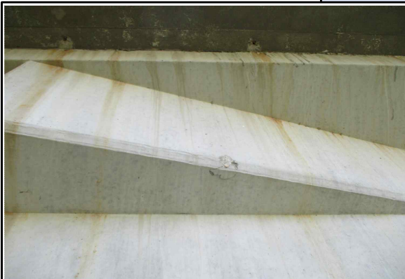
S4-G5 거더-파손 (25년 상반기 정기안전점검)
