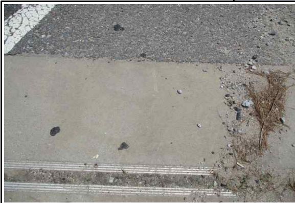
신축이음 후타재 균열(cw:0.3mm미만) (25년 상반기 정기안전점검)
