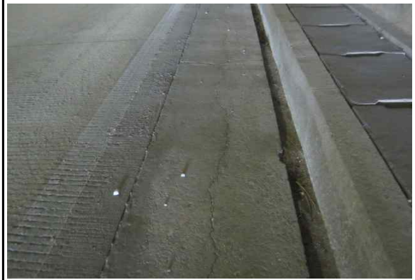
Span23 포장부-균열 (25년 하반기 정기안전점검)
