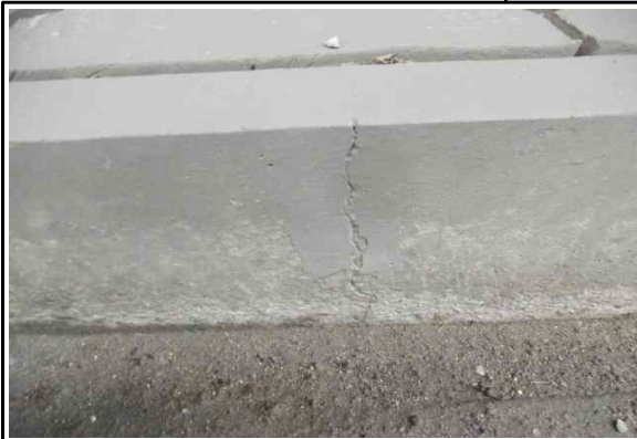
Sta. 112(Span 15) 공동구-균열(cw:0.3mm미만) (25년 상반기 정기안전점검)
