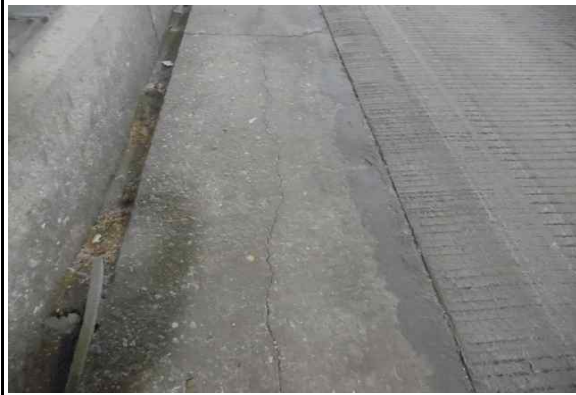
Span23 포장부-균열 (25년 상반기 정기안전점검)
