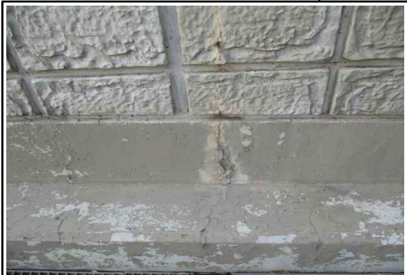
U-Type 옹벽-균열부 백태(cw:0.3mm미만) (25년 하반기 정기안전점검)
