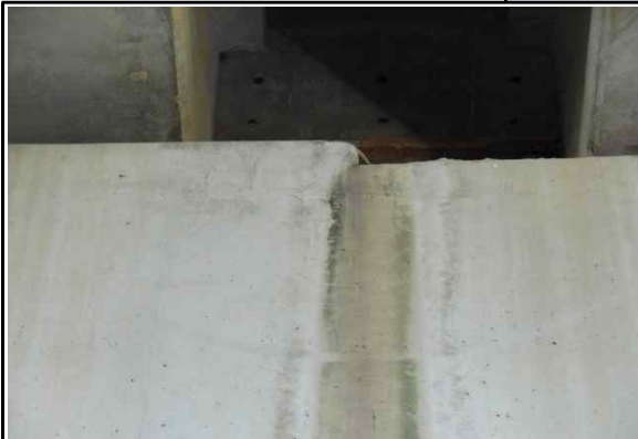
P2(G1~G2) 코핑(전면)-균열부 백태(cw:0.3mm미만) (25년 상반기 정기안전점검)
