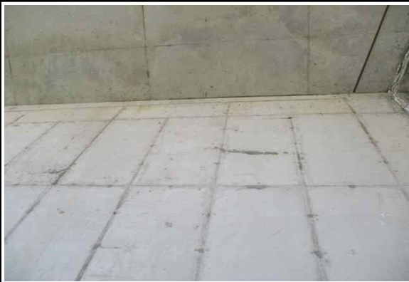
교대 망상균열(cw:0.3mm미만) (25년 상반기 정기안전점검)
