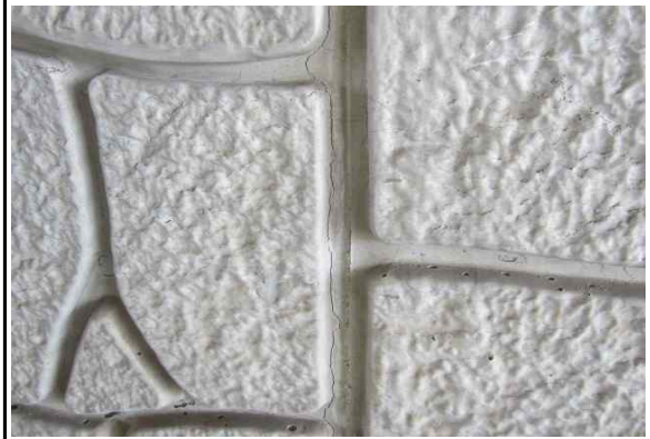
교대 균열(cw:0.3mm미만) (25년 하반기 정기안전점검)
