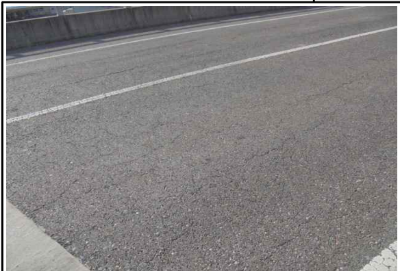
교면포장 포장 망상균열 (25년 하반기 정기안전점검)
