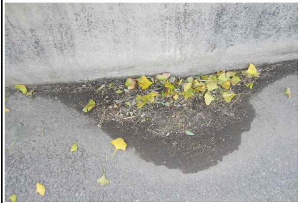
배수시설 배수구 막힘 (25년 하반기 정기안전점검)
