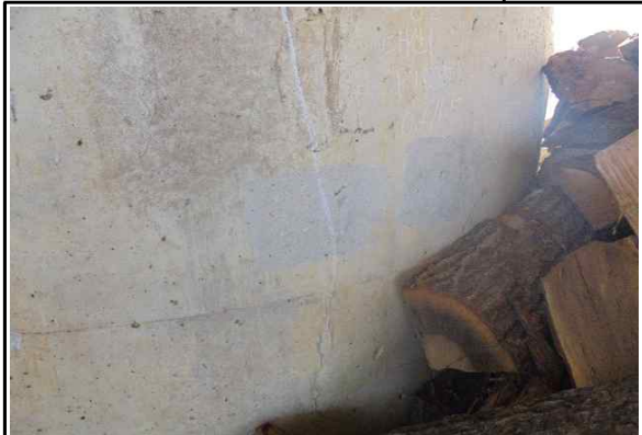
P1 기둥(전면)-균열(cw:0.3mm미만) (25년 하반기 정기안전점검)
