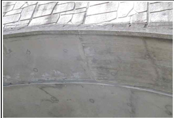
종점 갭문-균열(cw:0.3mm 이상) (25년 하반기 정기안전점검)
