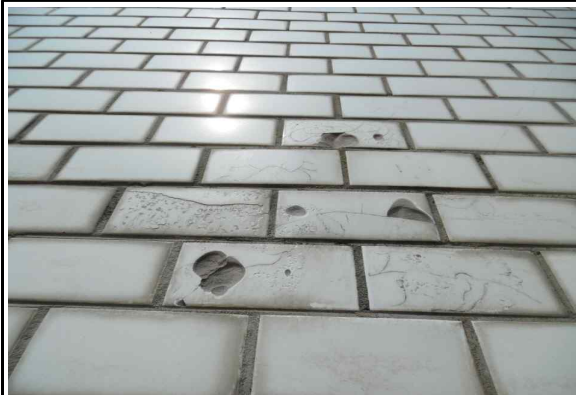
U-Type구간 옹벽 타일파손 (25년 상반기 정기안전점검)
