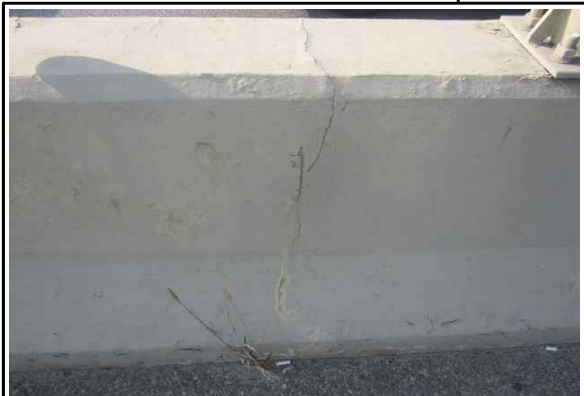
U-Type 옹벽-균열(cw:0.3mm이상) (25년 하반기 정기안전점검)
