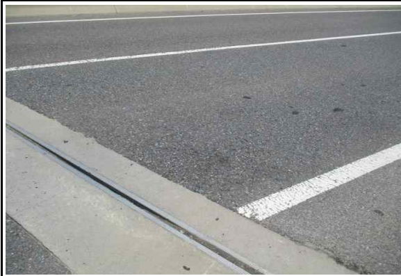
교면포장 아스콘 패임 (25년 상반기 정기안전점검)
