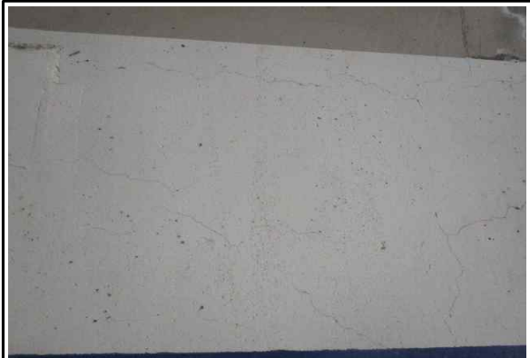
종점 갭문-망상균열(cw:0.3mm미만) (25년 하반기 정기안전점검)
