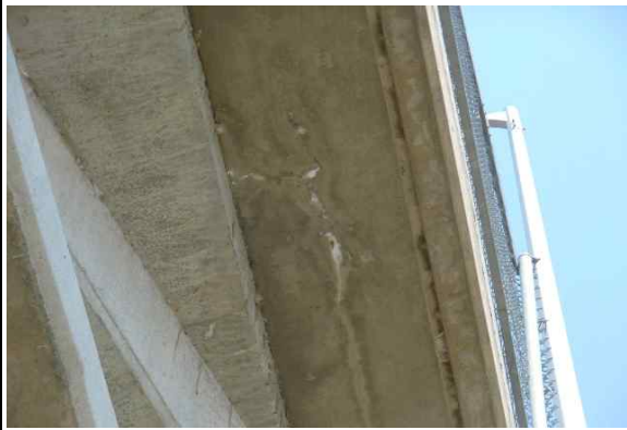
바닥판하면 균열부 백태(cw:0.3mm미만) (25년 상반기 정기안전점검)
