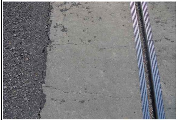
신축이음 후타재 균열(cw:0.3mm미만) (25년 하반기 정기안전점검)
