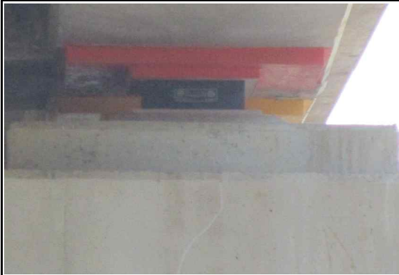
P3-Sh6 받침콘크리트-균열(cw:0.3mm미만) (25년 상반기 정기안전점검)
