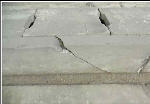
Sta. 83(Span 11) 공동구-파손 (25년 상반기 정기안전점검)
