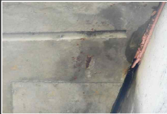
바닥판하면 철근노출 (25년 상반기 정기안전점검)
