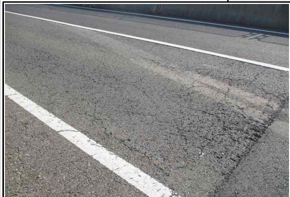
S2 교면포장-아스콘 망상균열 (25년 하반기 정기안전점검)
