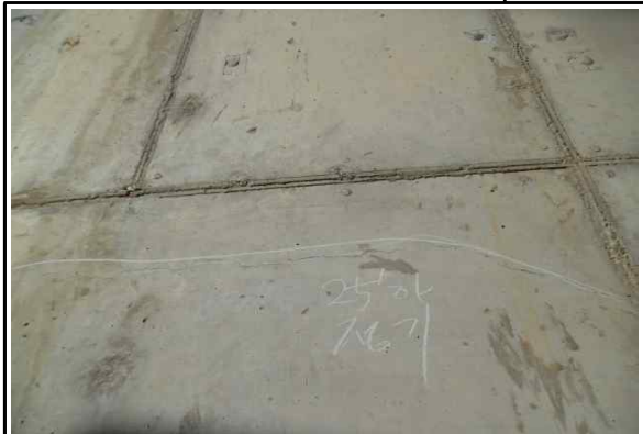
교대 균열(cw:0.3mm미만) (25년 하반기 정기안전점검)
