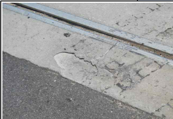
신축이음 후타재 파손 (25년 상반기 정기안전점검)
