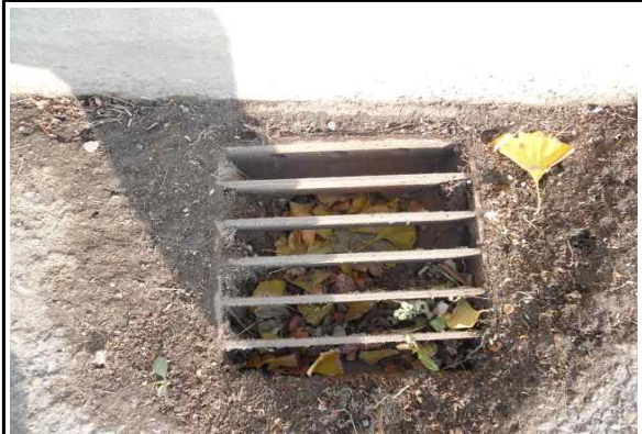
배수시설 배수구 막힘 (25년 하반기 정기안전점검)
