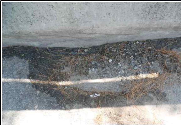
S1 배수시설-배수구 막힘 (25년 상반기 정기안전점검)
