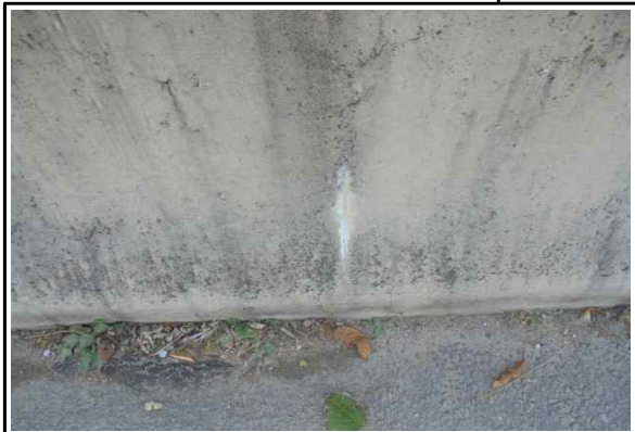
방호벽 균열부 백태(cw:0.3mm미만) (25년 하반기 정기안전점검)
