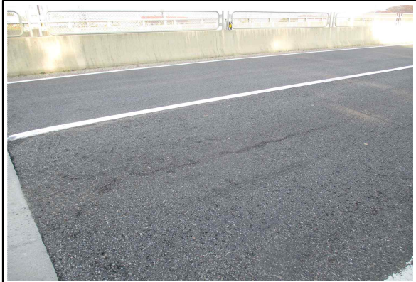
교면포장 아스콘 균열 (25년 하반기 정기안전점검)
