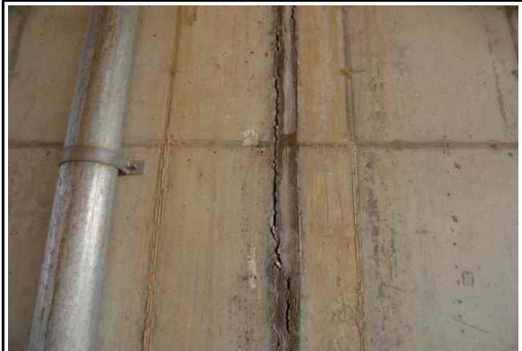
교대 실링재 파손 (25년 하반기 정기안전점검)
