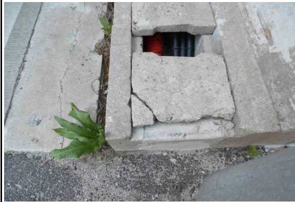
Sta. 235(중점 갭문) 공동구-덮개파손 (25년 상반기 정기안전점검)
