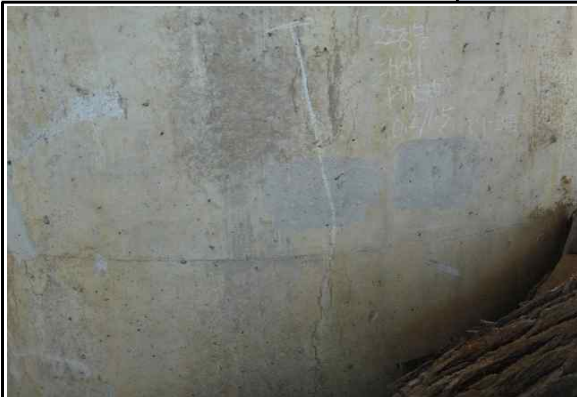
P1 기둥(전면)-균열(cw:0.3mm미만) (25년 상반기 정기안전점검)
