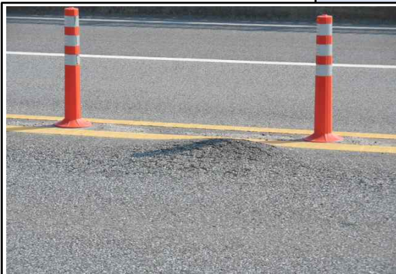
S1(강화) 교면포장-소성변형 (25년 상반기 정기안전점검)
