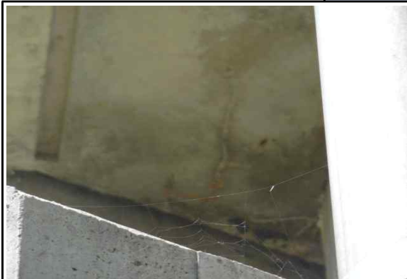
바닥판하면 균열부 백태(cw:0.3mm미만) (25년 상반기 정기안전점검)
