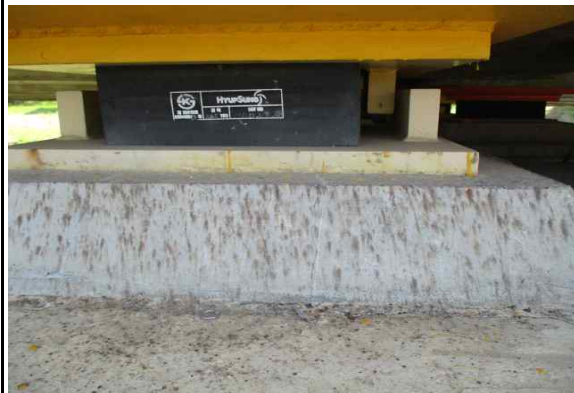
받침장치 받침몰탈 균열(cw:0.3mm미만) (25년 상반기 정기안전점검)
