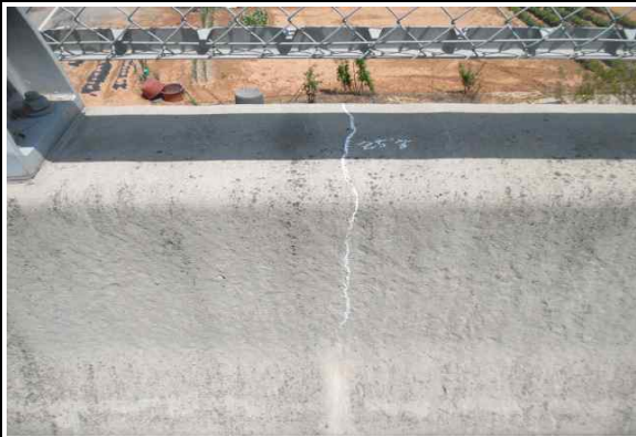
방호벽 균열(cw:0.3mm미만) (25년 상반기 정기안전점검)
