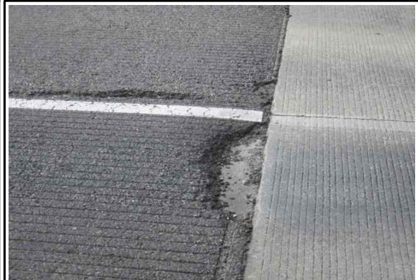
시점부 접속포장-파손 (25년 하반기 정기안전점검)
