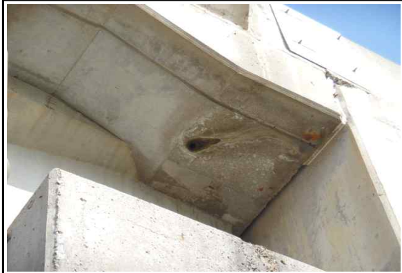
바닥판하면 누수흔적, 백태 (25년 하반기 정기안전점검)
