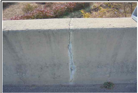
방호벽 균열부 백태(cw:0.3mm이상) (25년 하반기 정기안전점검)
