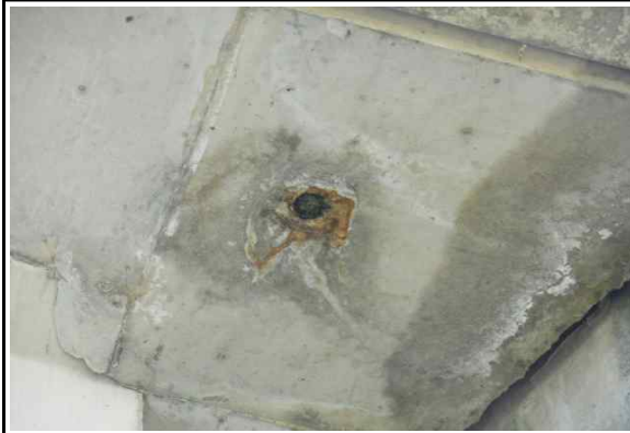
바닥판하면 백태, 유공관 길이부족 (25년 상반기 정기안전점검)
