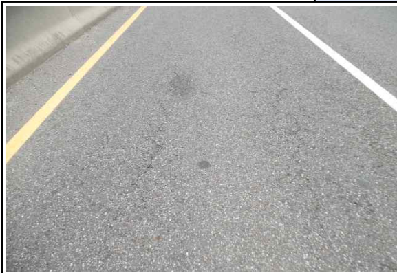
교면포장 포장 균열 (25년 상반기 정기안전점검)
