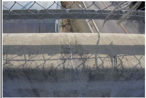
방호벽 균열(cw:0.3mm미만) (25년 하반기 정기안전점검)
