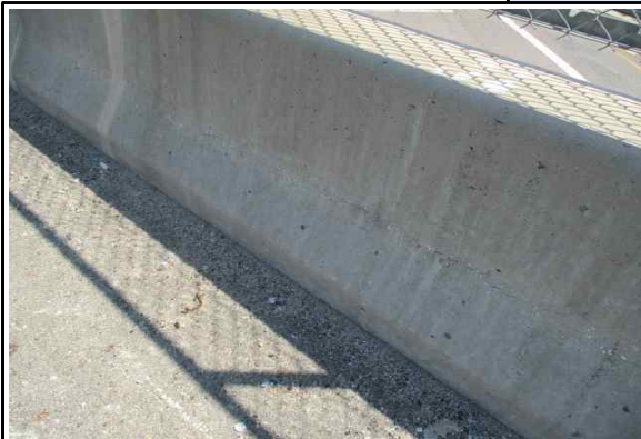
방호벽 균열(cw:0.3mm미만) (25년 상반기 정기안전점검)
