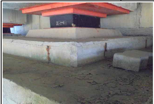
받침장치 받침콘크리트 잡철근 노출 (25년 하반기 정기안전점검)
