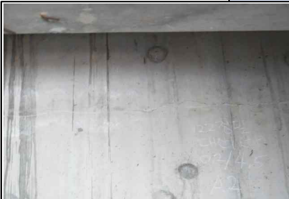
A2(G2~G3) 홍벽-균열(cw:0.3mm미만) (25년 상반기 정기안전점검)
