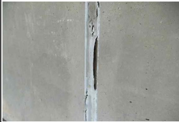
교대 전면부 실링재 파손 (25년 상반기 정기안전점검)
