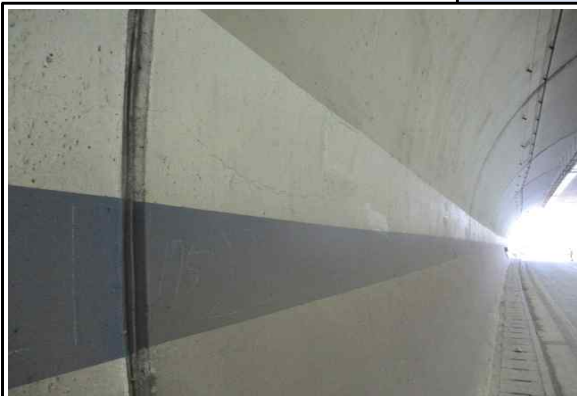
Sta. 175(Span 22) 좌측벽체-망상균열(cw:0.3mm미만) (25년 상반기 정기안전점검)
