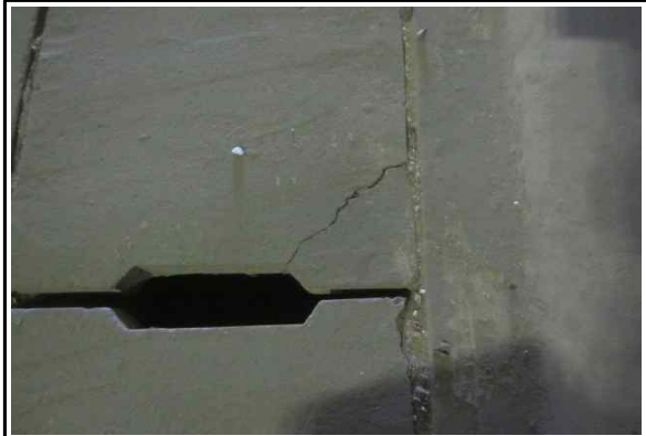
Sta. 177(Span 22) 공동구-덮개파손 (25년 하반기 정기안전점검)
