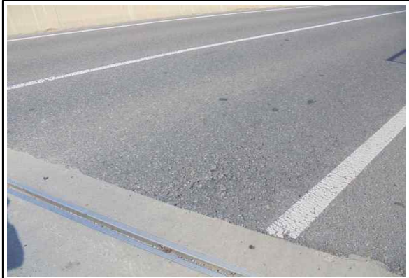
교면포장 아스콘 패임 (25년 하반기 정기안전점검)
