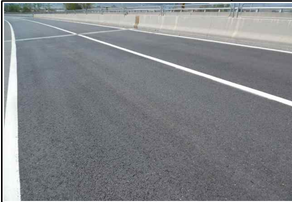
S3 교면포장-포장균열(보수완료) (25년 상반기 정기안전점검)
