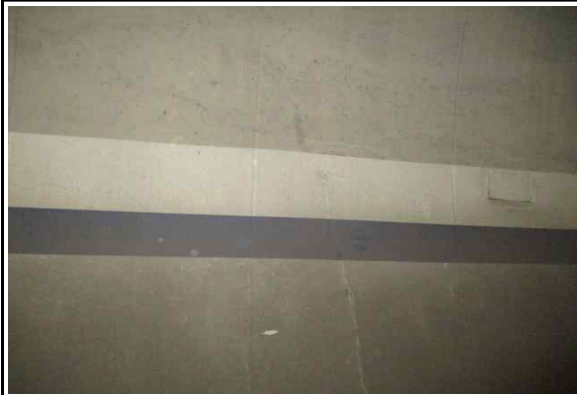
Span8 벽체-균열(cw:0.3mm이상) (25년 하반기 정기안전점검)
