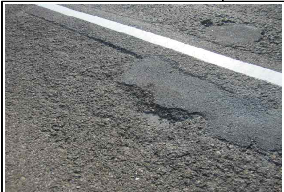
교면포장 포장 열화, 패임 (25년 하반기 정기안전점검)
