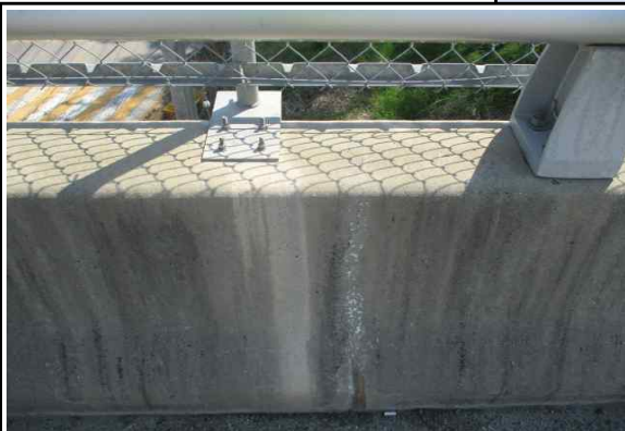
방호벽 균열(cw:0.3mm미만) (25년 상반기 정기안전점검)
