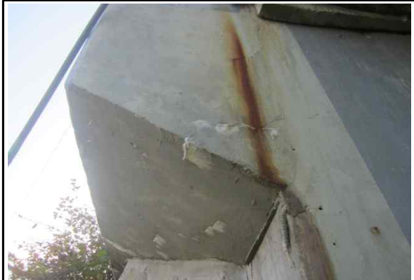
A2 교대 보수부-균열부 백태 (25년 하반기 정기안전점검)
