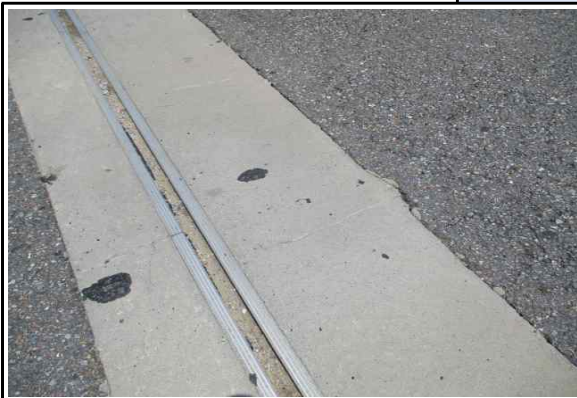
신축이음 후타재 균열(cw:0.3mm미만) (25년 상반기 정기안전점검)
