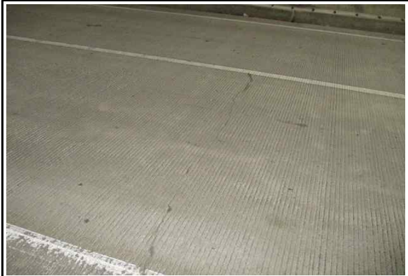
Sta. 021(Span 4~5) 포장부-균열 (25년 하반기 정기안전점검)
