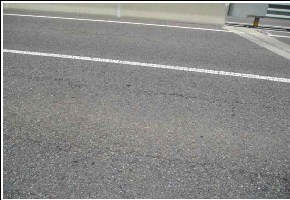
교면포장 포장 균열 (25년 상반기 정기안전점검)
