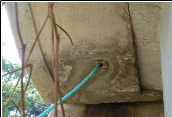
바닥판하면 백태, 유공관 마감미흡 (25년 상반기 정기안전점검)
