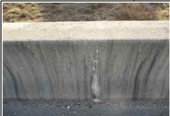
방호벽 균열(cw:0.3mm미만) (25년 하반기 정기안전점검)
