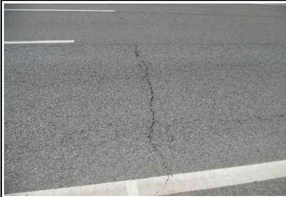
교면포장 포장균열 (25년 상반기 정기안전점검)
