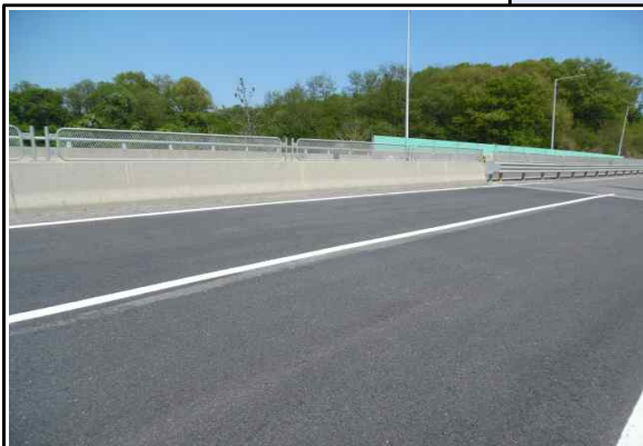
S4(1차로) 교면포장 - 포장패임(보수완료) (25년 상반기 정기안전점검)
