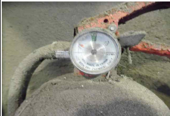
소화시설 4개소-상태불량 (25년 상반기 정기안전점검)
