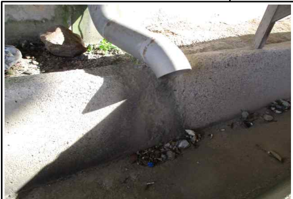
배수시설 배수로 박리 (25년 하반기 정기안전점검)
