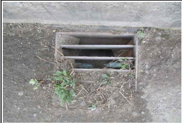
배수시설 배수구 막힘 (25년 하반기 정기안전점검)
