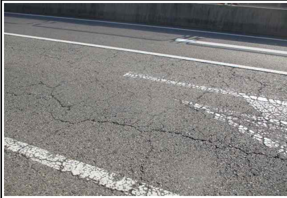
교면포장 아스콘 망상균열 (25년 하반기 정기안전점검)
