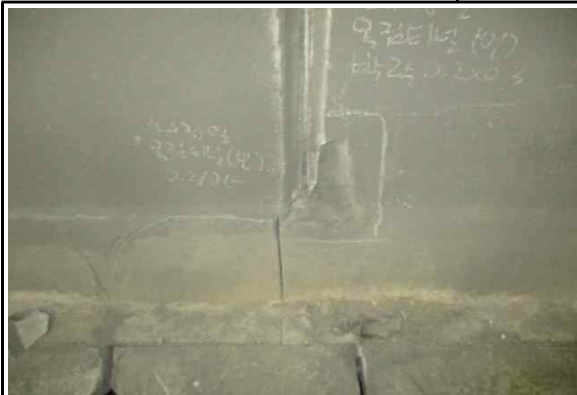
Sta. 047(Span 8) 좌측벽체-박락 (25년 상반기 정기안전점검)
