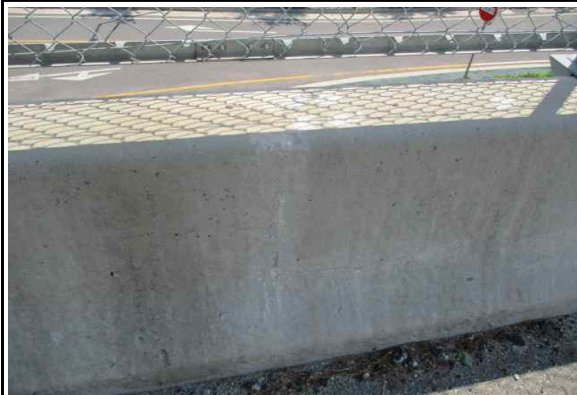
방호벽 균열(cw:0.3mm미만) (25년 상반기 정기안전점검)
