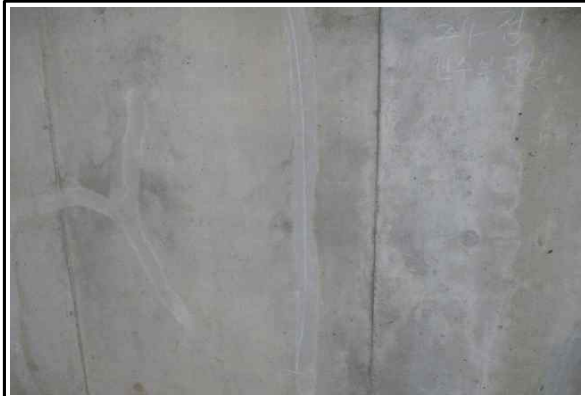
교대 보수부 재균열(cw:0.3mm미만) (25년 하반기 정기안전점검)
