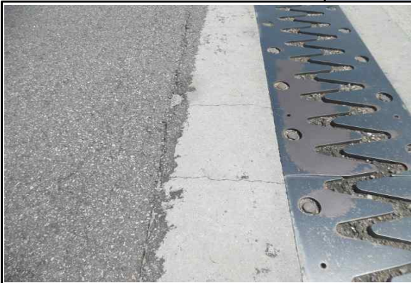
A1 신축이음-후타재 균열(cw:0.3mm미만) (25년 상반기 정기안전점검)
