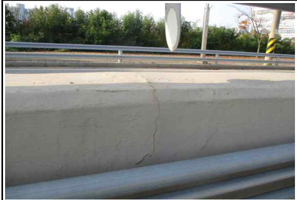
U-Type 옹벽-균열(cw:0.3mm미만) (25년 하반기 정기안전점검)
