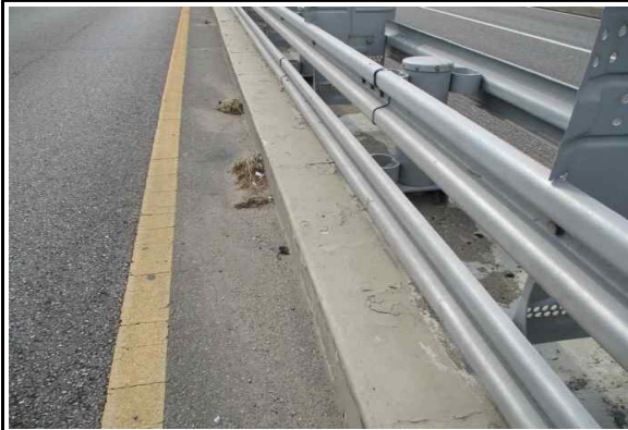
Sta. 100(강화) 연석-중앙분리대 보수재 박리 (25년 상반기 정기안전점검)
