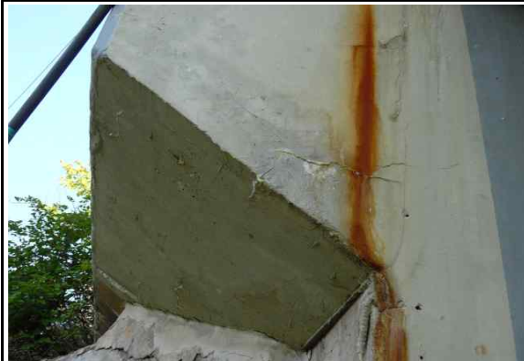
A2 교대 보수부-균열부 백태 (25년 상반기 정기안전점검)
