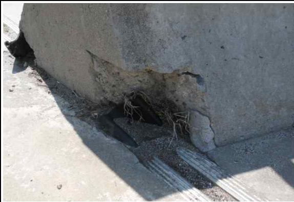
중앙분리대 파손 (25년 상반기 정기안전점검)
