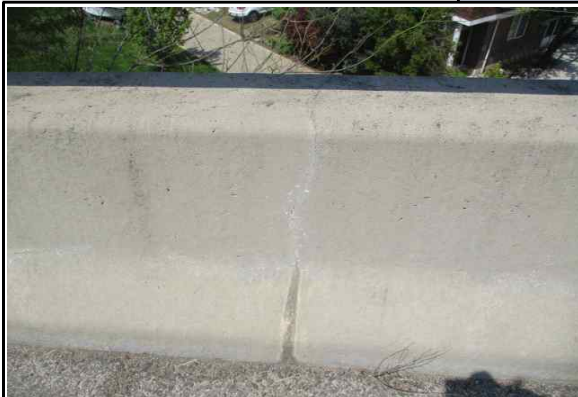
S1 방호울타리-균열(cw:0.3mm미만) (25년 상반기 정기안전점검)
