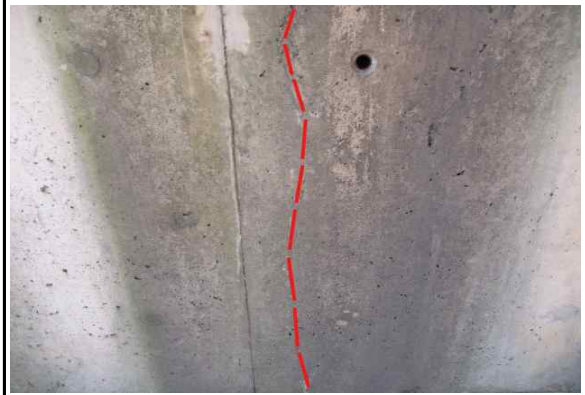
교대 균열(cw:0.3mm미만) (25년 하반기 정기안전점검)
