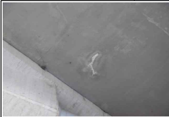
바닥판하면 백태 (25년 상반기 정기안전점검)
