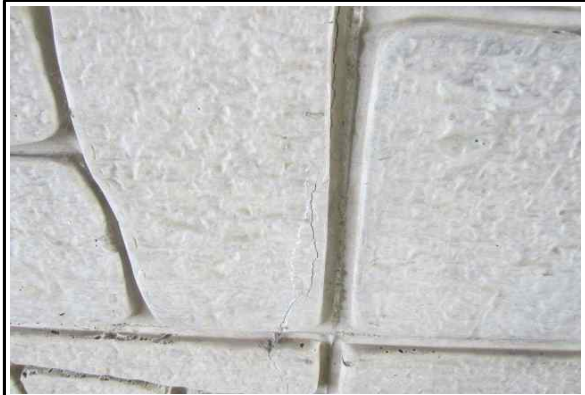
교대 균열(cw:0.3mm미만) (25년 하반기 정기안전점검)
