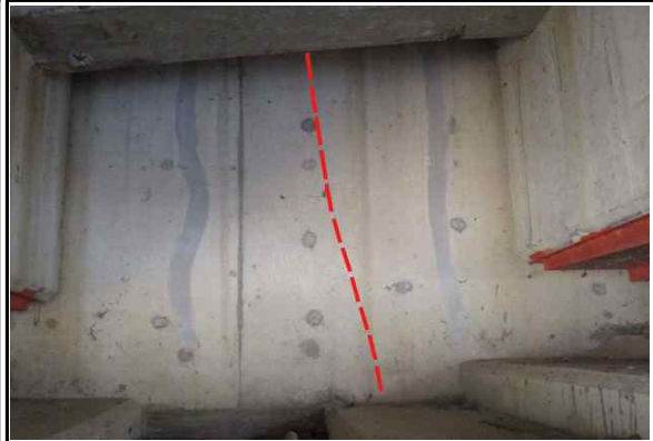
A1(G1~G2) 흥벽-균열(cw:0.3mm미만) (25년 하반기 정기안전점검)
