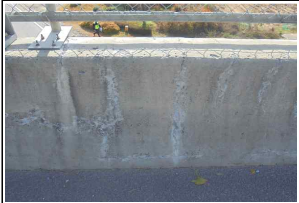
방호벽 균열(cw:0.3mm미만) (25년 하반기 정기안전점검)
