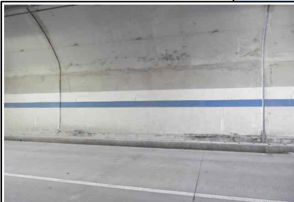
Sta. 200(Span 25) 중앙벽체-누수흔적 (25년 상반기 정기안전점검)
