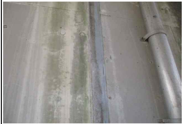
교대 실링재 파손 (25년 하반기 정기안전점검)
