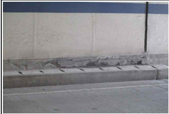
Sta. 011(Span 4) 중앙벽체-백태 및 누수흔적 (25년 하반기 정기안전점검)
