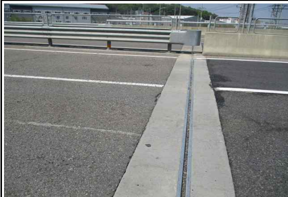
교면포장 접속부 아스콘 파손 (25년 상반기 정기안전점검)
