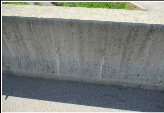
방호벽 균열부 백태(cw:0.3mm미만) (25년 상반기 정기안전점검)
