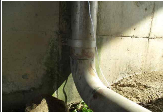
배수시설 배수관 파손 (25년 하반기 정기안전점검)
