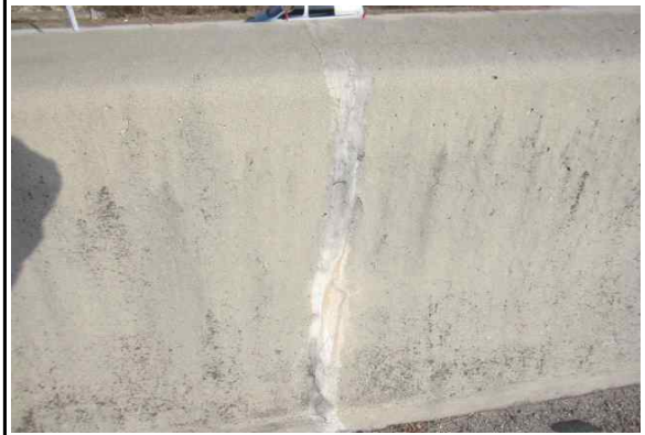
연석 균열(cw:0.3mm미만) (25년 하반기 정기안전점검)
