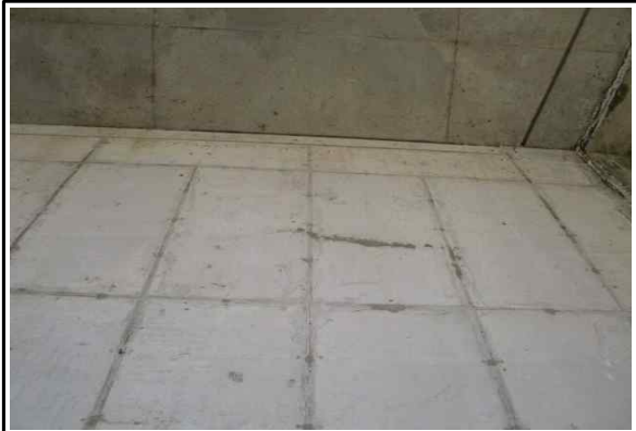
교대 망상균열(cw:0.3mm미만) (25년 하반기 정기안전점검)
