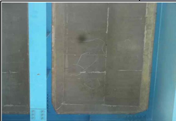
S2 바닥판하면-망상균열(cw:0.3mm미만) (25년 상반기 정기안전점검)
