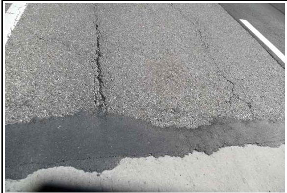
교면포장 접속부 포장 균열 (25년 하반기 정기안전점검)
