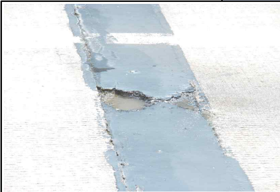
포장부 조인트 파손 (25년 상반기 정기안전점검)
