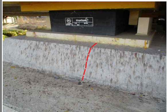
받침장치 받침몰탈 균열(cw:0.3mm미만) (25년 하반기 정기안전점검)
