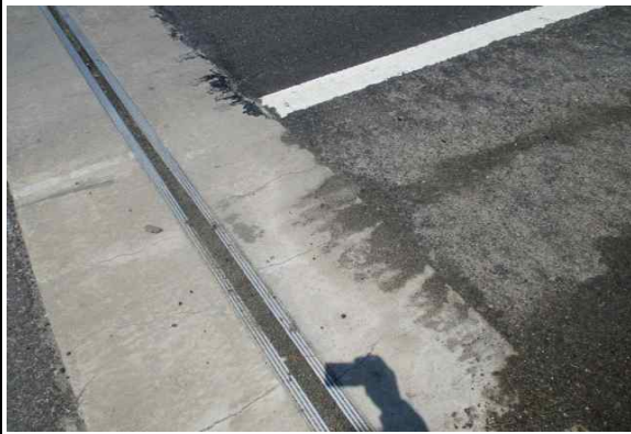
신축이음 후타재 균열(cw:0.3mm미만) (25년 상반기 정기안전점검)
