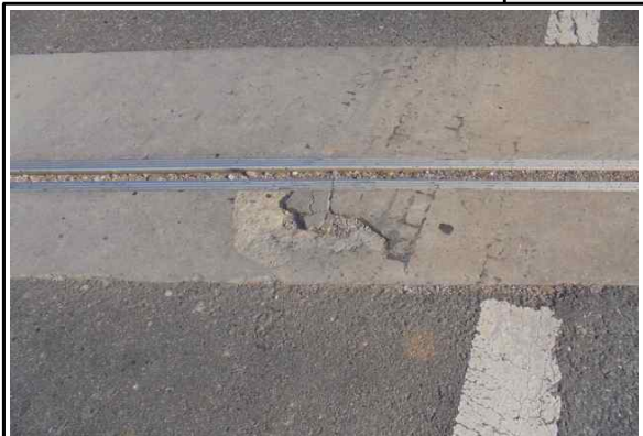
신축이음 후타재 파손 (25년 하반기 정기안전점검)
