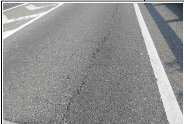
교면포장 포장 균열 (25년 하반기 정기안전점검)
