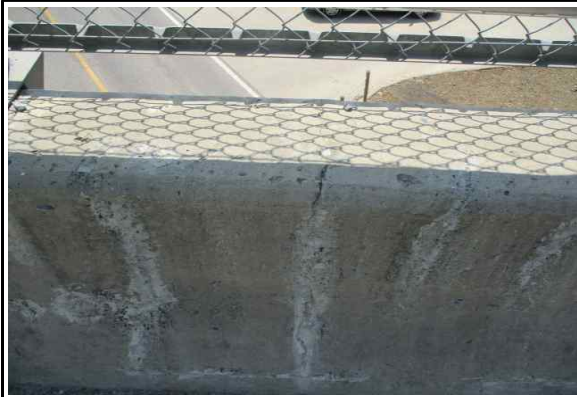
방호벽 균열(cw:0.3mm미만) (25년 상반기 정기안전점검)
