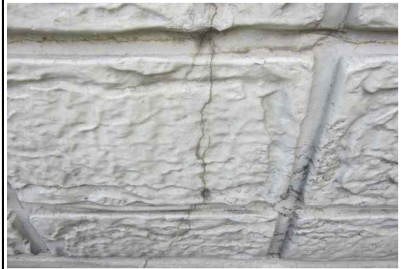
U-Type 옹벽-균열(cw:0.3mm미만) (25년 하반기 정기안전점검)
