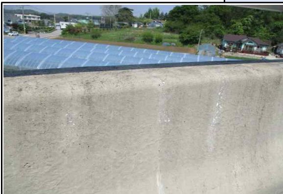
S2 방호울타리-균열(cw:0.3mm미만) (25년 상반기 정기안전점검)
