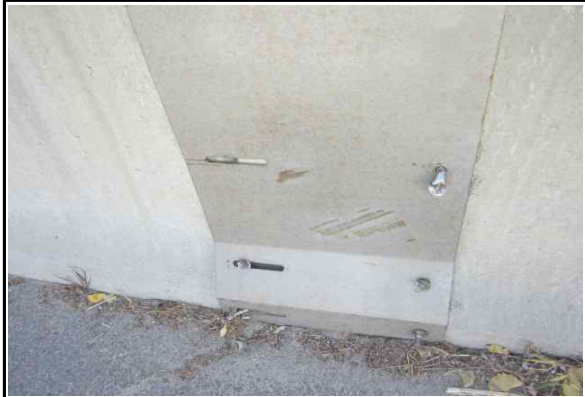
A2 신축이음-차수판 볼트 체결불량 (25년 하반기 정기안전점검)
