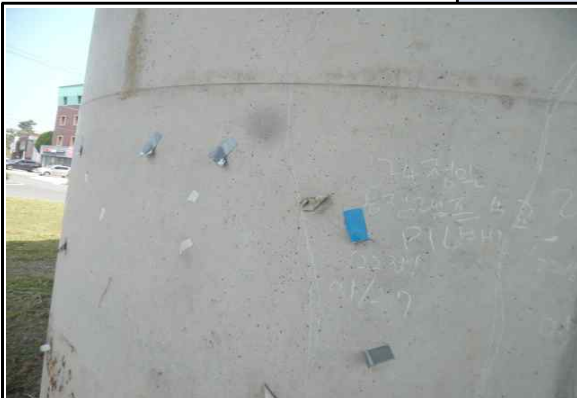
P1 기둥-균열(cw:0.3mm미만) (25년 상반기 정기안전점검)
