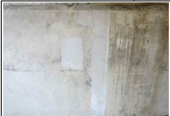
A2 교대-균열(cw:0.3mm미만) (25년 하반기 정기안전점검)
