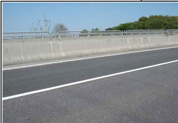
S4(1차로) 교면포장 - 포장패임(보수완료) (25년 상반기 정기안전점검)
