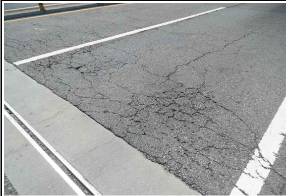
교면포장 접속부 포장 망상균열 (25년 상반기 정기안전점검)
