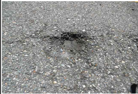
교면포장 포트홀 (25년 상반기 정기안전점검)
