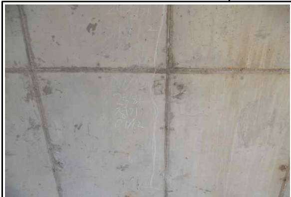
교대 균열(cw:0.3mm미만) (25년 하반기 정기안전점검)
