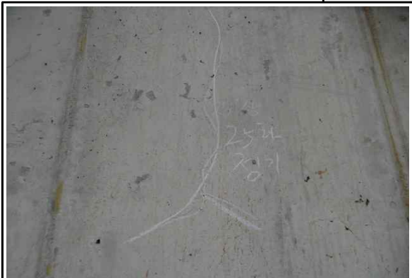
교대 균열(cw:0.3mm미만) (25년 하반기 정기안전점검)
