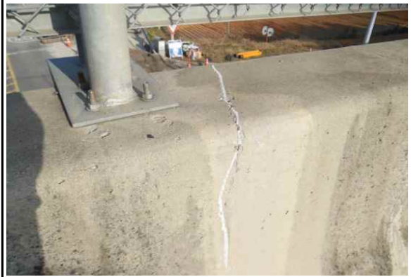
연석 균열(cw:0.3mm미만) (25년 하반기 정기안전점검)
