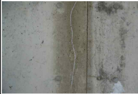
교대 균열(cw:0.3mm미만) (25년 상반기 정기안전점검)
