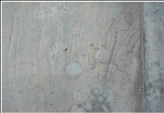
교대 망상균열(cw:0.3mm미만) (25년 상반기 정기안전점검)
