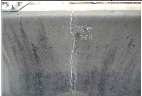
연석 균열(cw:0.3mm미만) (25년 하반기 정기안전점검)
