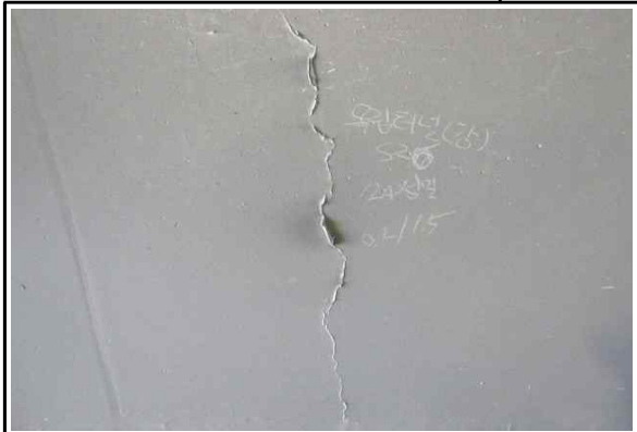
Span26 벽체-균열(cw:0.3mm미만) (25년 하반기 정기안전점검)
