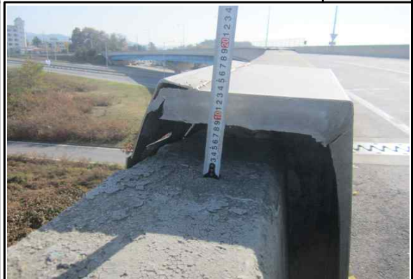
시점 접속부 옹벽-침하 (25년 하반기 정기안전점검)
