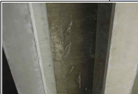
바닥판하면 균열부 백태(cw:0.3mm미만) (25년 상반기 정기안전점검)
