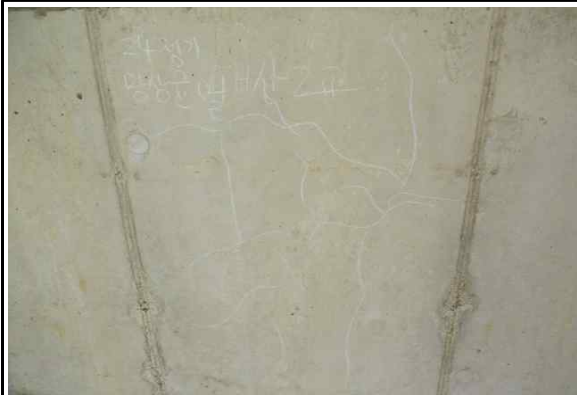
교대 망상균열(cw:0.3mm미만) (25년 상반기 정기안전점검)
