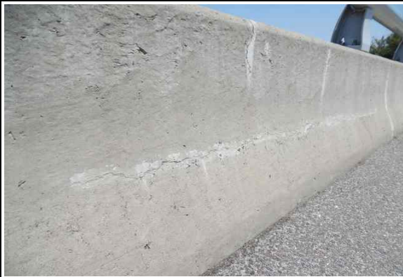
방호벽 균열부 백태(cw:0.3mm이상) (25년 상반기 정기안전점검)
