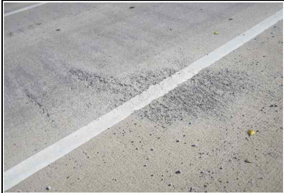
S1 교면포장-포장박리 (25년 하반기 정기안전점검)
