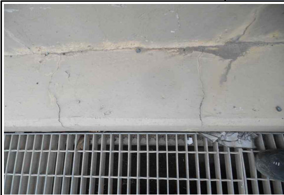
연석-균열(cw:0.3mm미만) (25년 상반기 정기안전점검)
