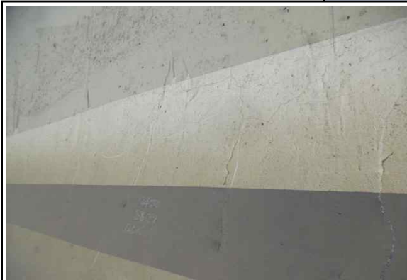
Sta. 052(Span 8) 우측벽체-망상균열 (25년 상반기 정기안전점검)
