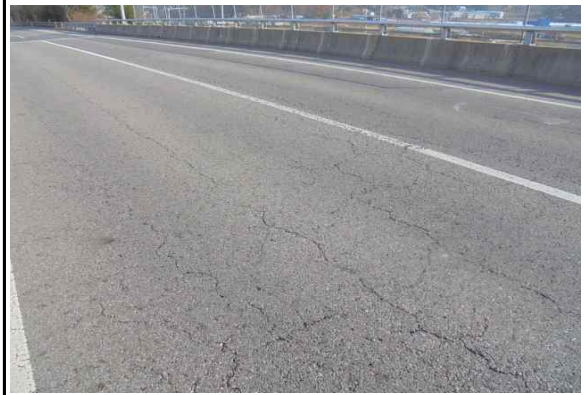
교면포장 포장 망상균열 (25년 하반기 정기안전점검)
