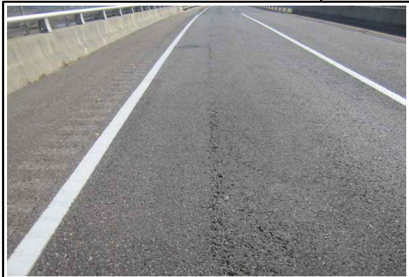
교면포장 포장 균열 (25년 하반기 정기안전점검)
