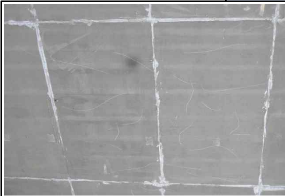
바닥판하면 망상균열(cw:0.3mm미만) (25년 상반기 정기안전점검)
