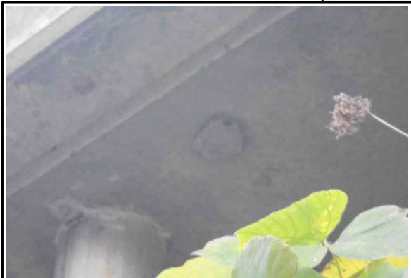
바닥판하면 들뜸 (25년 하반기 정기안전점검)
