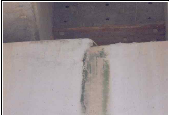
P2(G1~G2) 코핑(전면)-균열부 백태(cw:0.3mm미만) (25년 하반기 정기안전점검)
