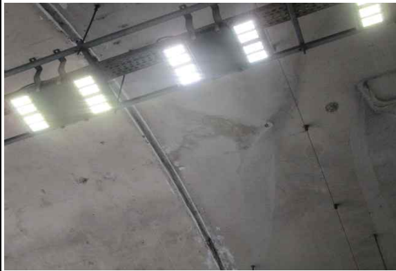
Sta. 228(Span 27) 천단부-표면열화 (25년 상반기 정기안전점검)
